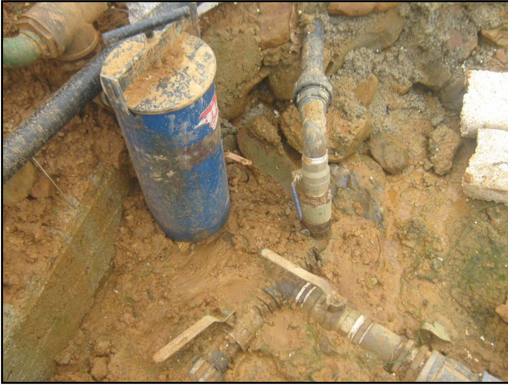
Fotoğraf 51: Jeotermal Kaynaktan Yararlanarak Yapılan Toprak Isıtma Sisteminin Tesisinden Bir Görünüm (Aydın / Germencik)
