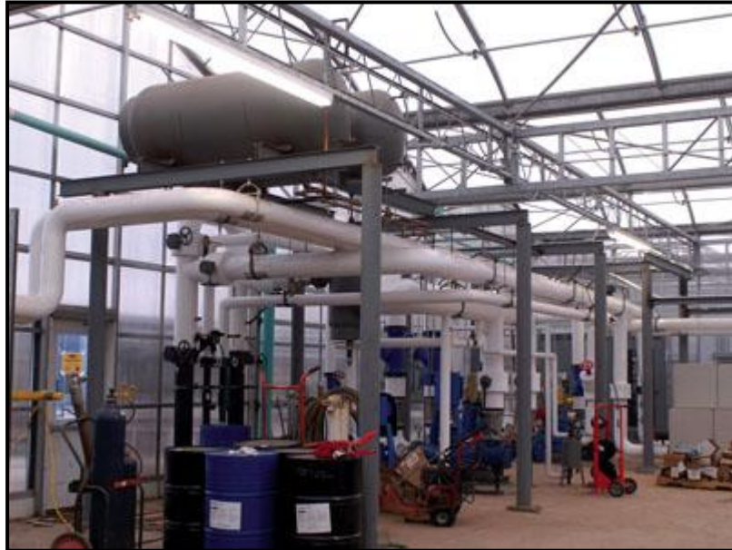
Fotoğraf 11: Klorifer Sisteminin Döşendiği Plastik Seranın İçeriden Görünümü (Yakıt olarak doğalgaz kullanılmaktadır / 2008)
