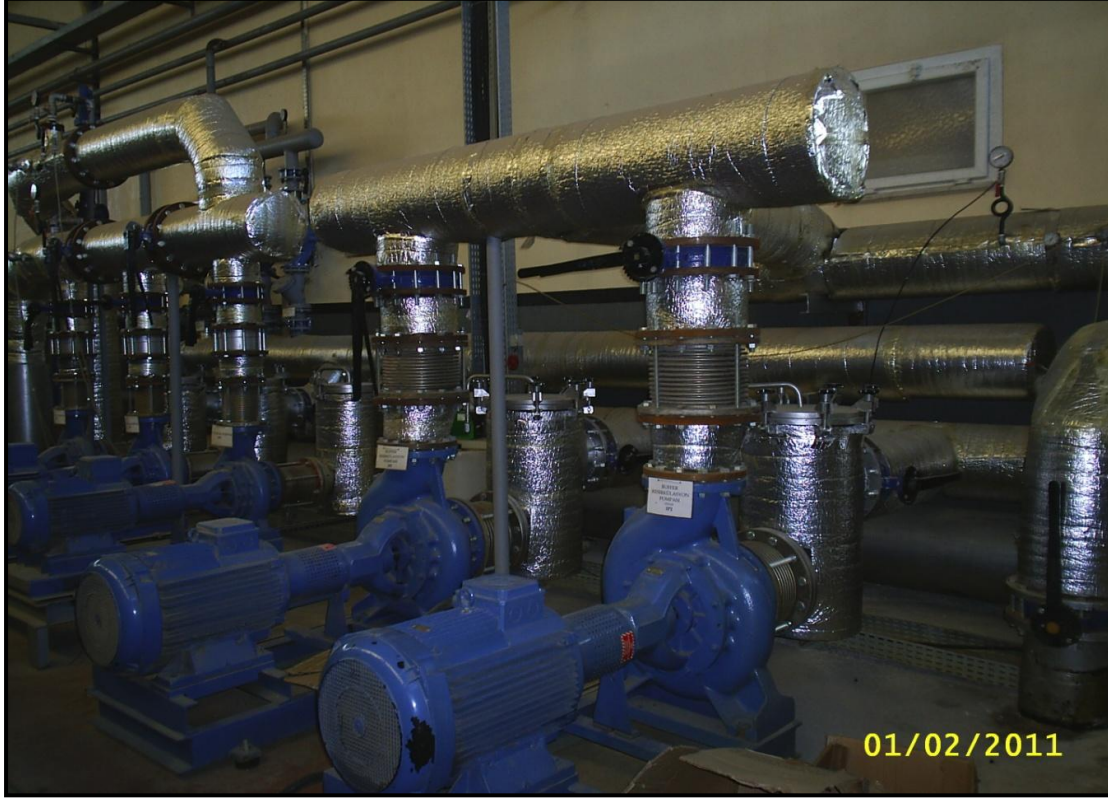
Fotoğraf 48: Aydın (Buharkent)’da Jeotermal Kaynaklarla Isıtılan Bir Seranın Isıtma Sisteminden Bir Görünüm
