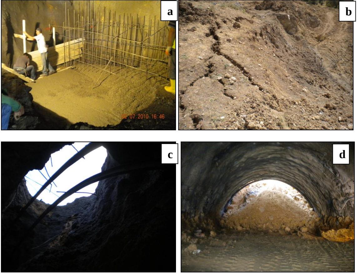
Fotoğraf 2.7 (a)Aynayla yakın mesafeli invert uygulamasında yapılması (b)Tünel üstündeki heyeylan çatlakları (c) Çalışma sırasında oluşan göçük (d) Baca açılması
