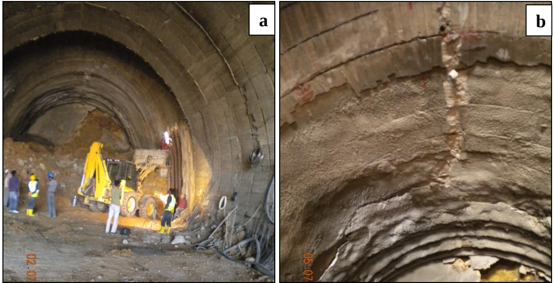
Fotoğraf 2.6 (a) Portaldan sonra deforme olmuş iksaların yenilenmesi (b) İksalarda oluşan çatlak
