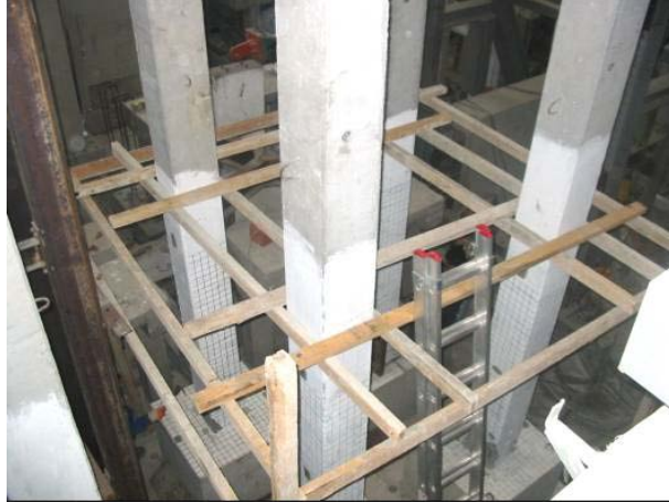
Şekil 4.71 : Güçlendirme öncesinde desteklenen hasarlı dört numune.
