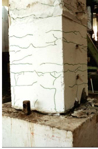
Şekil 4.70 : Yenilenen mantoda ve eski çanak betonundaki hasar durumu.
