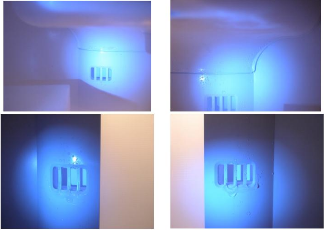
Şekil 3.18 : Taze besin bölümünde bulunan çoklu kanal straforunda oluşan terleme Taze besin bölümünde, bulunan çoklu kanal straforun üzerindeki kanal çıkışlarında terleme nedeniyle oluşan buz parçacıkları görülmektedir (Şekil 3.18).
