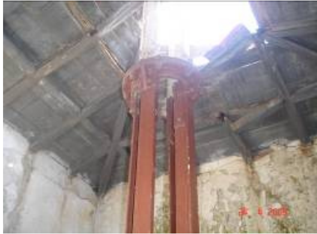
Resim 4.69 : Fener odasının duvarında görülen yosunlaşma (2010).
