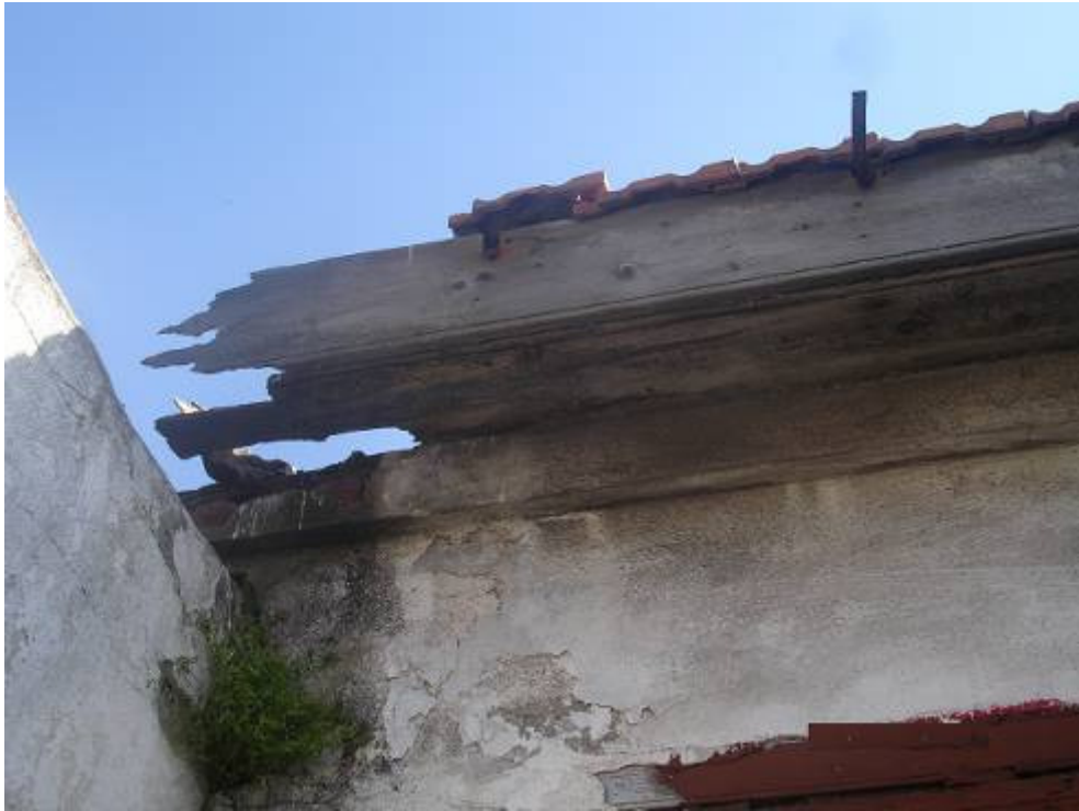
Resim 4.74 : Saçak altı kaplama tahtaları ve alın tahtalarındaki hasar ve taşıyıcı duvardaki bitkilenme (2010).
