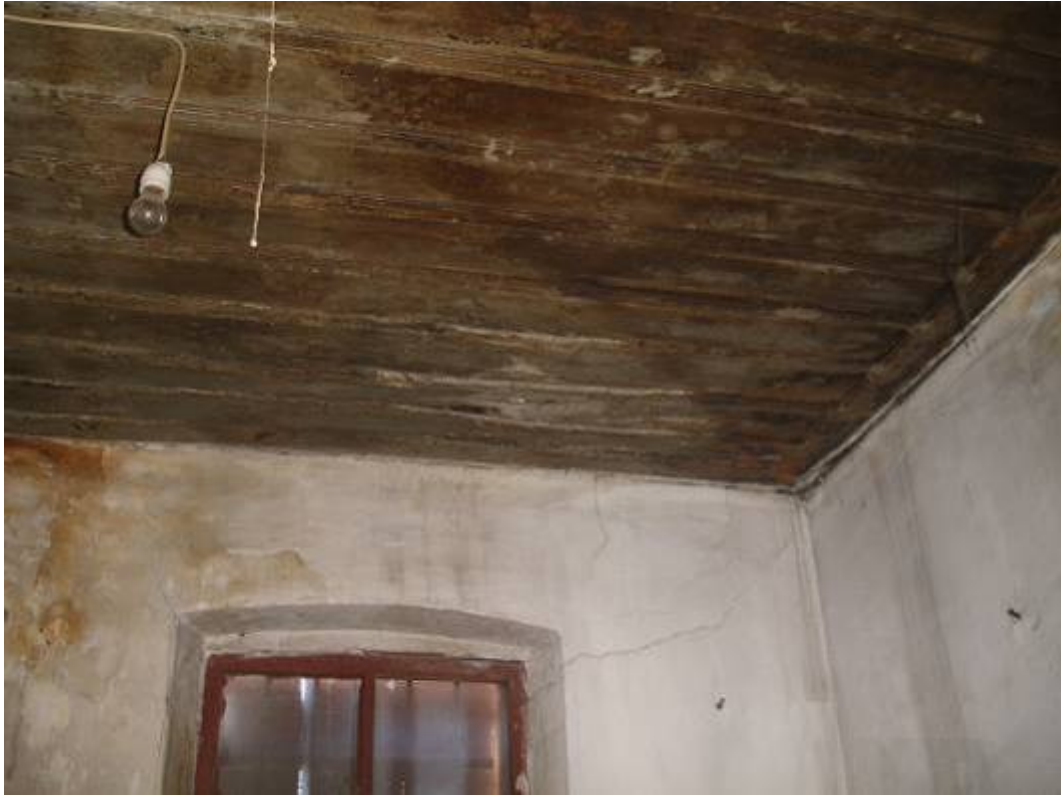
Resim 4.70 : D05 no'lu odada çatıdan sızan suyun izleri ve ahşap kaplamadaki çürüklük mantarı (2010).
