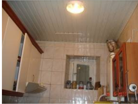
Resim 4.32 : Z02 no'lu mekanın metal asma tavanı (2010).
