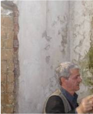
Resim 4.68 : Duvarda görülen yosunlaşma (2010).
