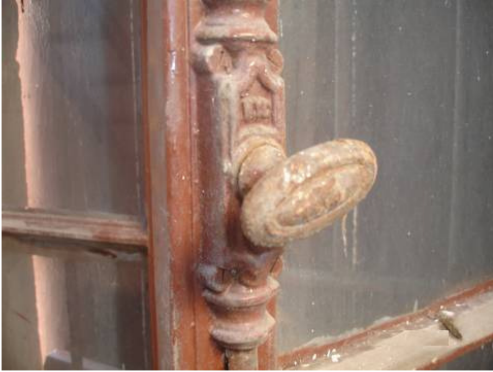
Resim 4.73 : Yapının metal pencere anahtarındaki paslanma (2010).
