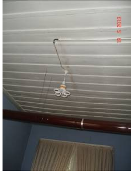
Resim 4.31 : Z05 no'lu mekanın tavanı (2010).
