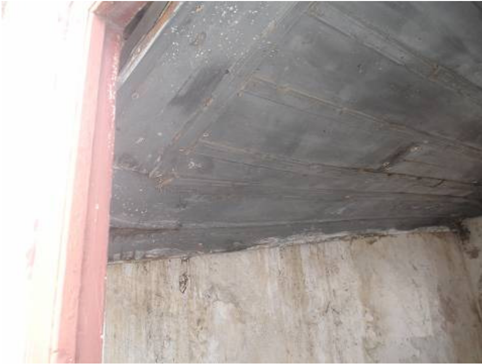
Resim 4.72 : D02 no'lu sarnıç mekanının çöken ahşap tavanı (2010).
