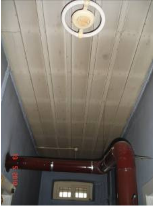
Resim 4.30 : Z04 no'lu mekanın tavanı (2010).
