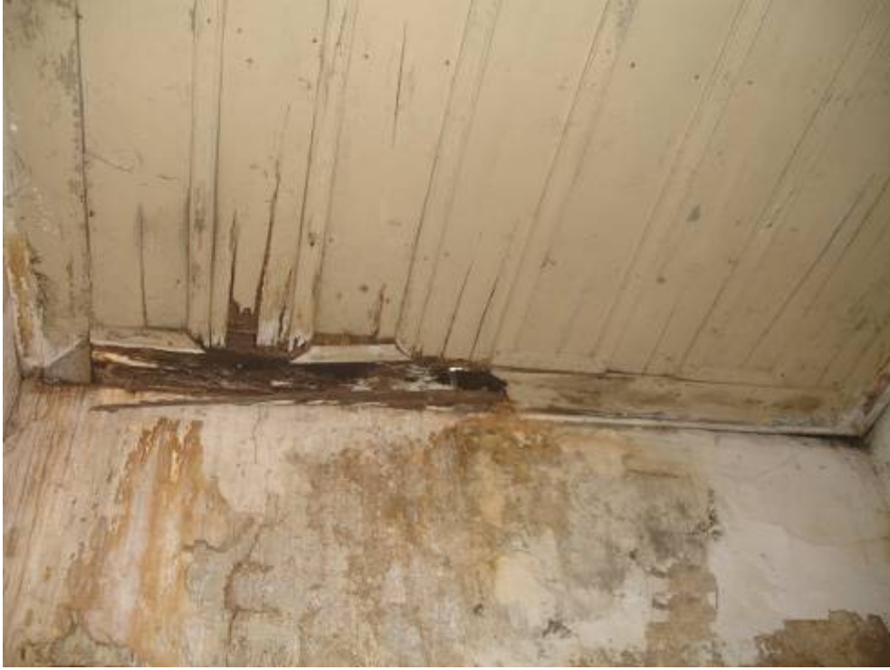
Resim 4.71 : D06 nolu odadaki çatıdan sızan suyun izleri ve ahşap kaplamadaki çürüklük mantarı (2010).
