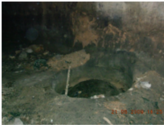
Resim 3.63. Su deposu döşeme görünüşü 2009 - E.İ.İ
