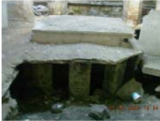
Resim 7.6. Yıkık döşeme - 2009 E.İ.İ
