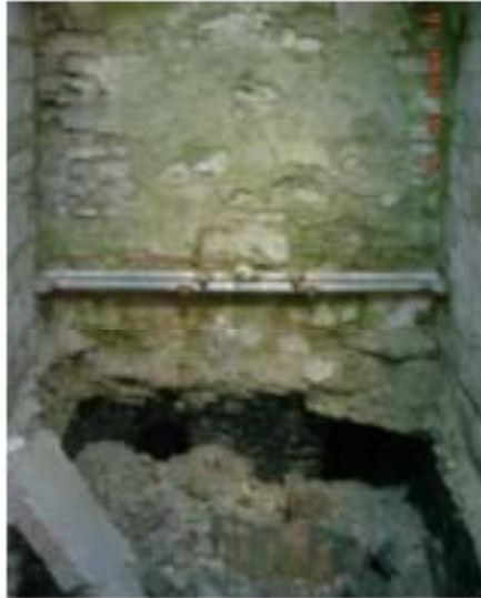
Resim 3.57. Erkekler bölümü sıcaklığı açıktan giden galvaniz su boruları - 2009 E.İ.İ
