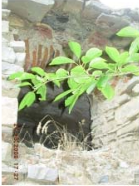
Resim 3.25. Batı cephesi P6 penceresi 2009 - E.İ.İ
