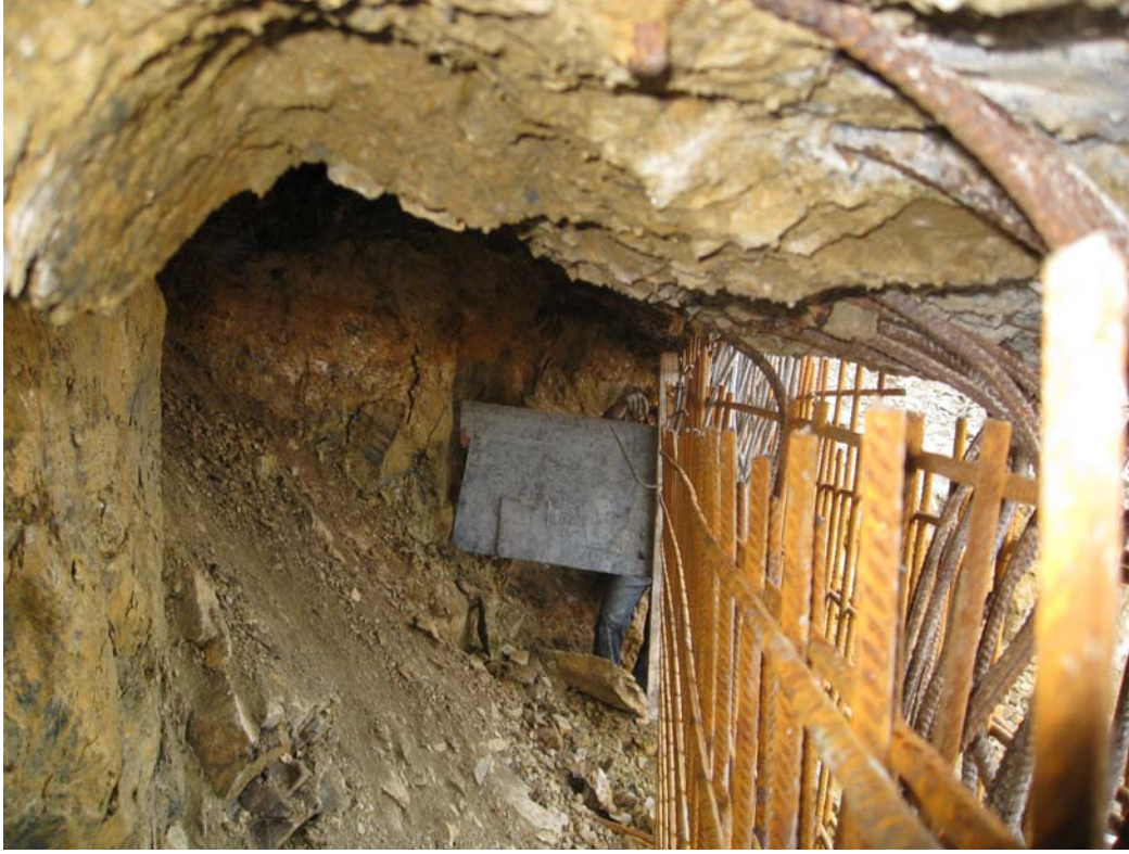
Şekil 6.16 : Grafitik şistli tabakaların ayrışıp dökülmesi sonucu perde arkasında oluşan boşluklar
