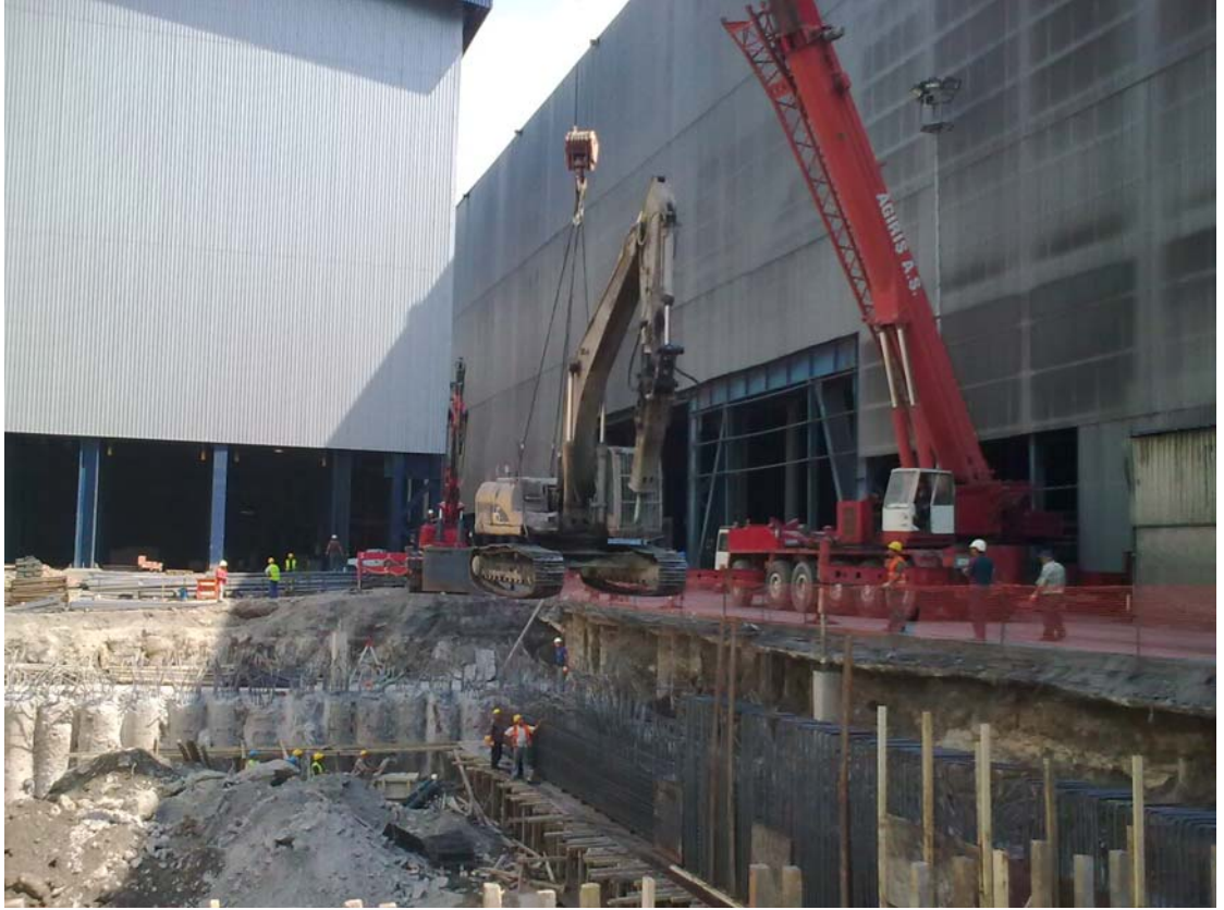
Şekil 4.17 : İksa sistemi arkasında sürşarj yükü oluşturan ekipmanlar
