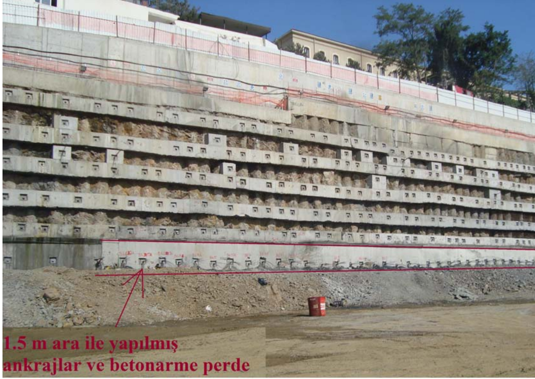
Şekil 6.14 : Önlem olarak ankraj sıklaştırılması yapılan betonarme perde
