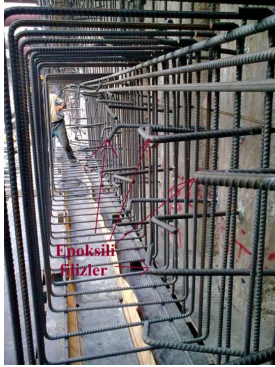
Şekil 5.40 : Kuşak kirişi içerisindeki epoksi filizleri
