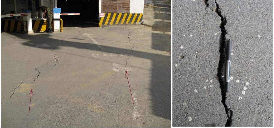
Şekil 6.13 : İksa sistemindeki deplasman sonucu oluşan yüzey çatlakları
