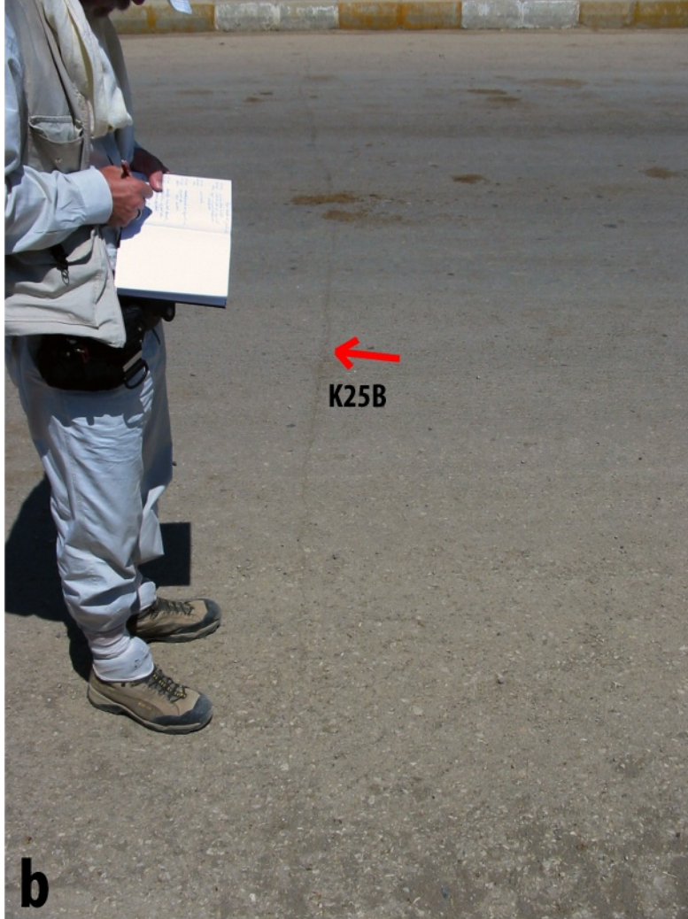
Şekil 3.21 Afşar kasabasında deprem sırasında bir evin duvarında oluşan makaslama kırıkları (a) ve asfaltta görülen K25B doğrultulu kırık (b)
