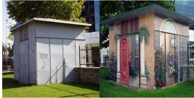
Şekil 3.20 : Güzelleştirilen trafo örneği (Url-35).
