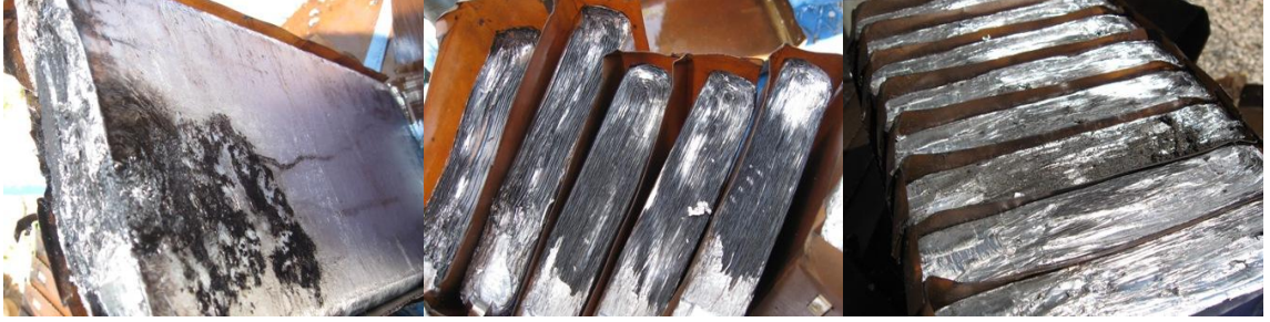
Şekil 3.3. Zarar görmüş OG kondansatörler ve kondansatör plakaları
