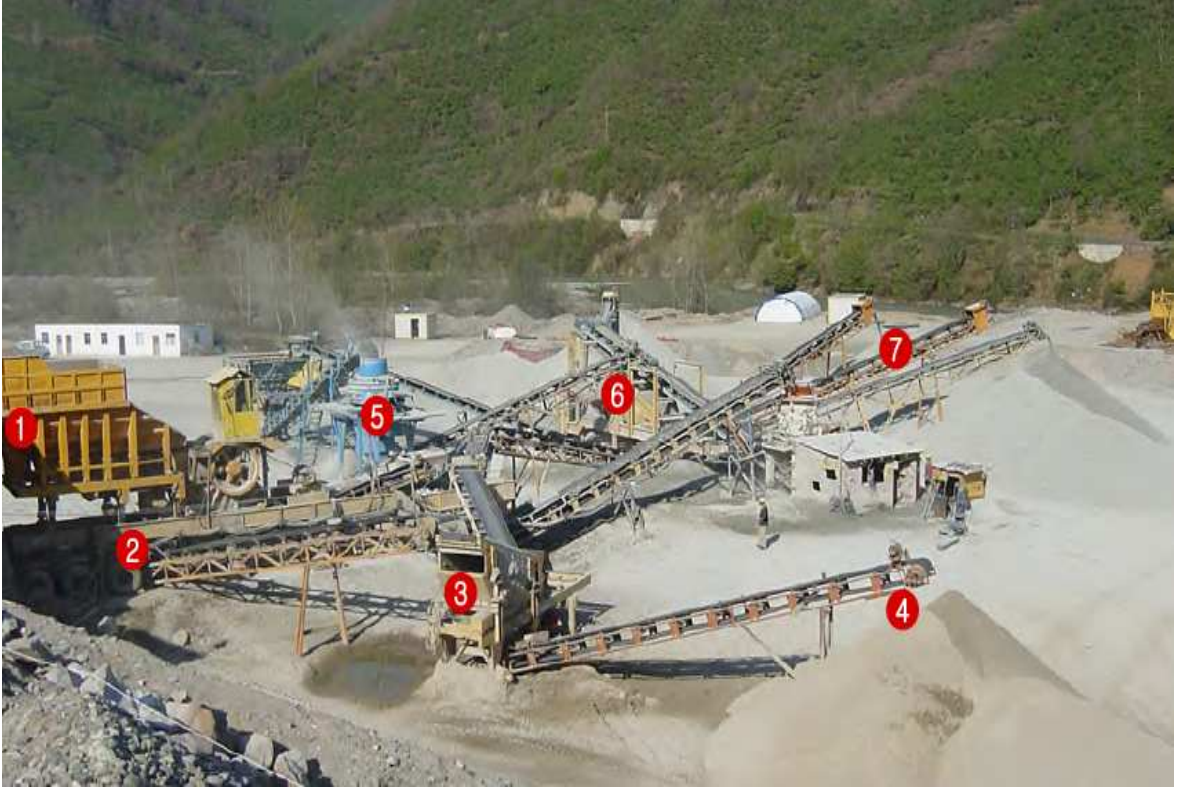
Şekil 2.1. Malzemelerin kırıldığı konkasör tesisi (Karaahmetli köyü-Tirebolu)
