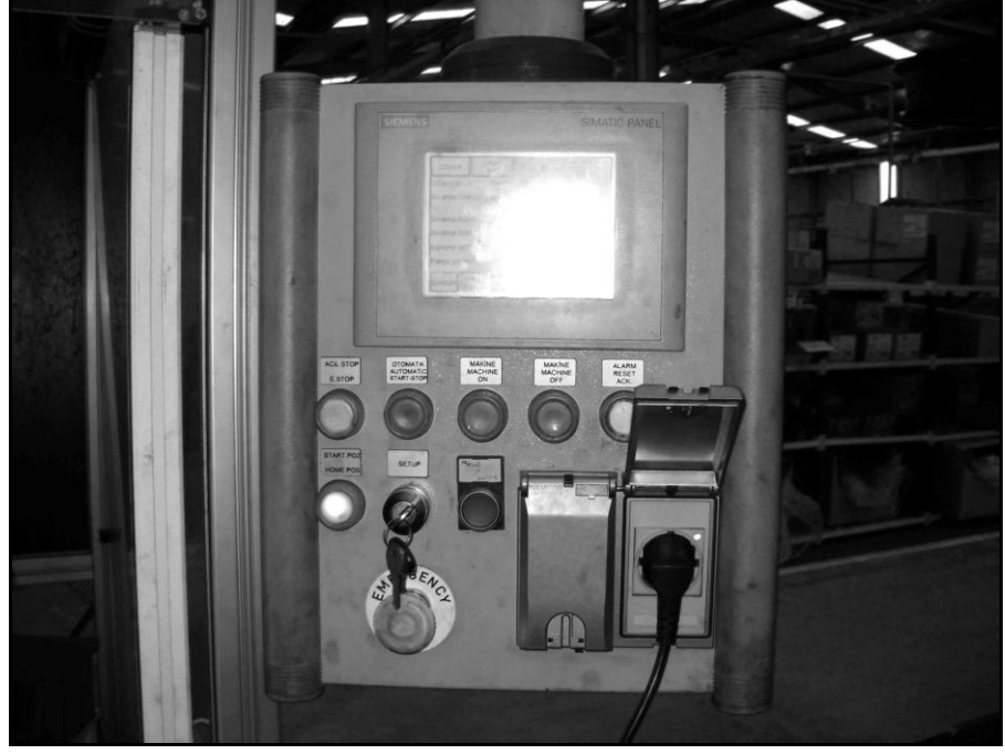
Şekil 7.1 Sıvama tezgâhına ait elektronik kumanda paneli
