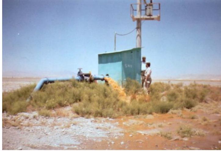
Şekil 3.2. Araştırma alanındaki yeraltı su kuyusundan görünüm
