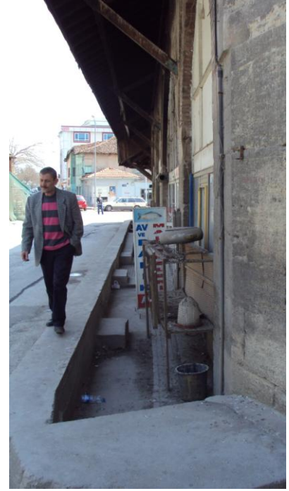
Şekil 4.98. Kervansarayın giriş kısmında yükselen yol kodu (27.03.2011)
