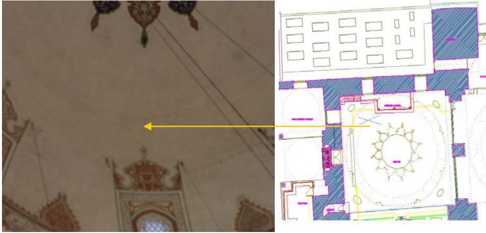
Şekil 5.1 Mescit kubbesinde meridyen şeklinde oluşan çatlak ve plandaki durumu
