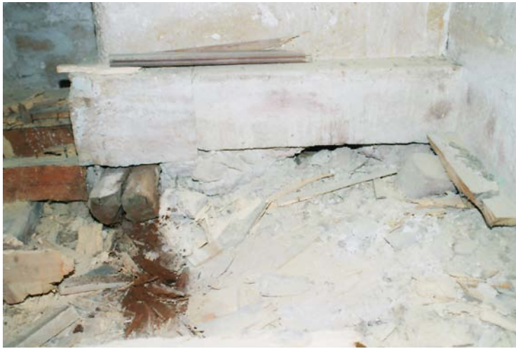
Şekil 2.11 Taşıyıcı fil ayağın çürümüş ahşap ızgara destekli temel sistemi
