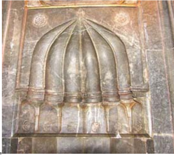
Şekil 2.13 Mermer mihrap ve bünyesinde oluşan çatlama.
