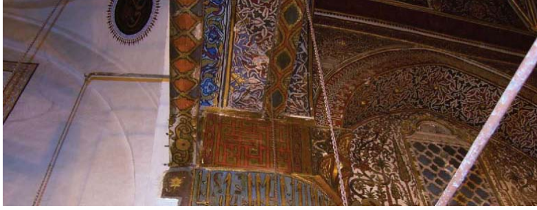
Şekil 2.7 Ahşap yüzeylerdeki süslemelerde görülen bozulmalar
