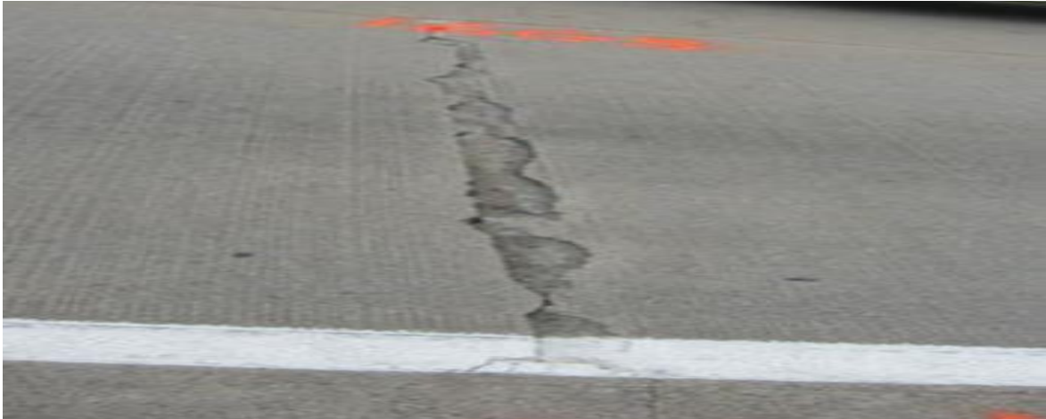
Şekil 19. Tipik orta panel çatlak kabarma ve parçalanması
