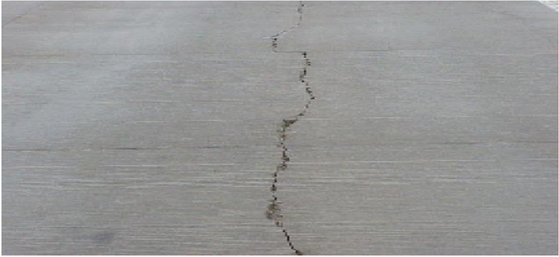
Şekil 22. Boyuna çatlağa yakın bir bakış
