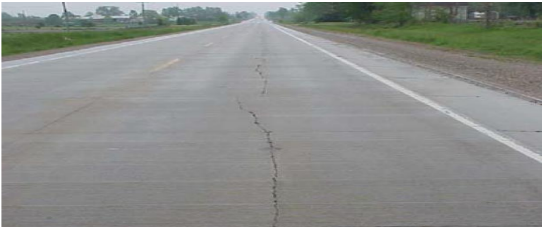
Şekil 21. Boyuna gelişen uzun çatlaklar
