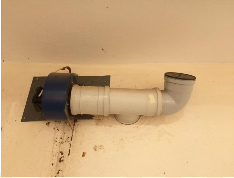
Şekil 3.3. Havalandırma ünitesinden bir görünüm
