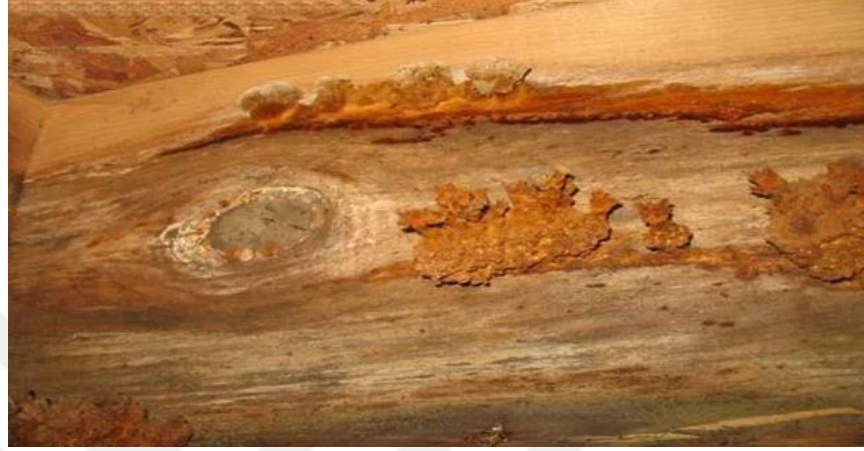
Şekil 3.2.: Mantarların ahşap malzemeye verdiği hasar [13].
