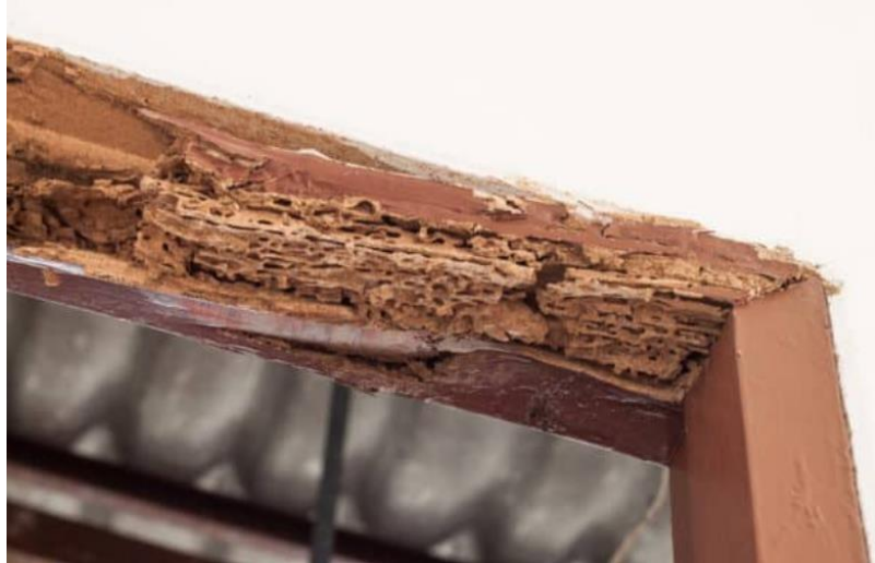
Şekil 3.5. : Termitlerin ahşap malzemeye verdiği hasar [15].
