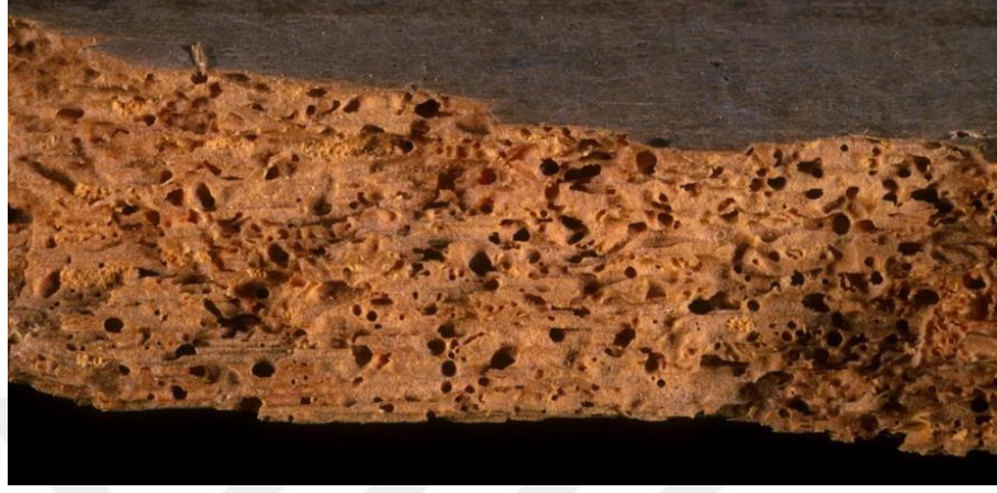
Şekil 3.4. : Ahşap yapıya böceklerin verdikleri hasar [14].
