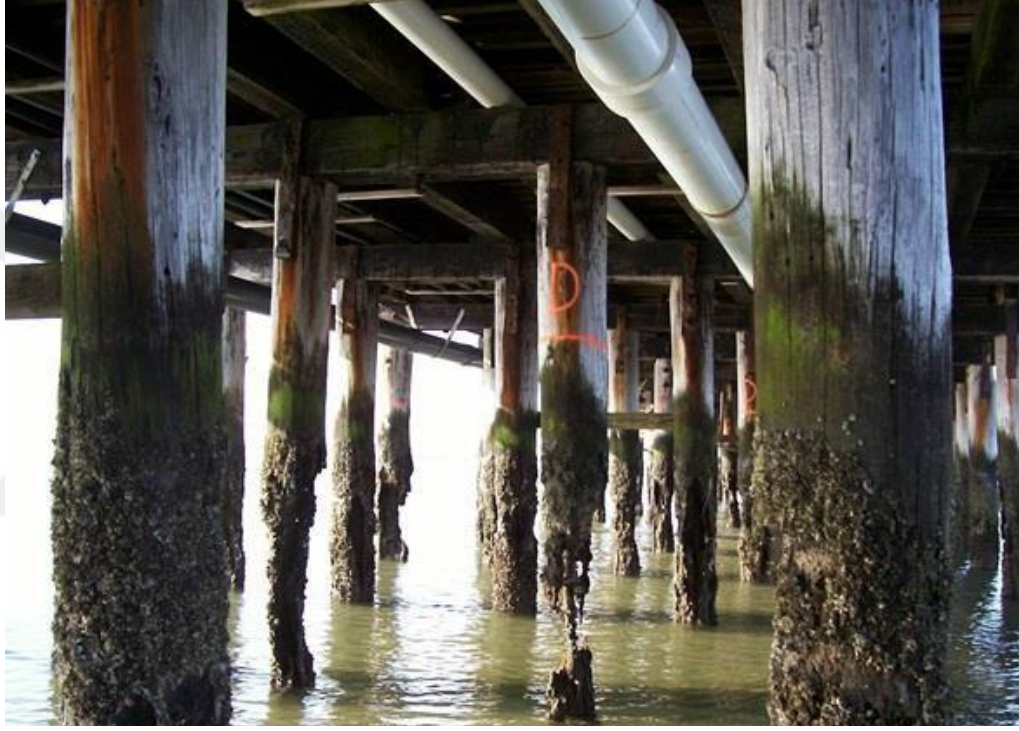
Şekil 3.6. : Deniz zararlılarının ahşap malzemeye verdiği hasar [17].
