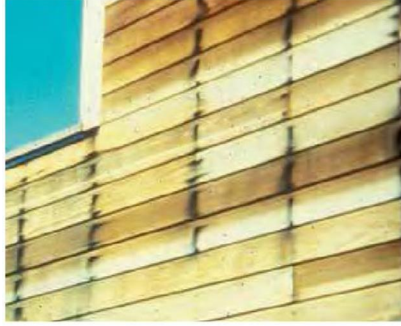
Şekil 5.2. : Ahşap malzeme üzerinde çivinin oluşturduğu korozyon [39].
