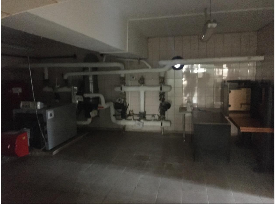
Şekil 5.145 Bodrum kat ısı merkezi görünüşü (Yağcı, 2020).
