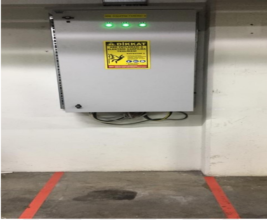
Şekil 52.Atölyede Bulunan Yalıtkan PaspasızTehlikeli Elektrik Panosu
