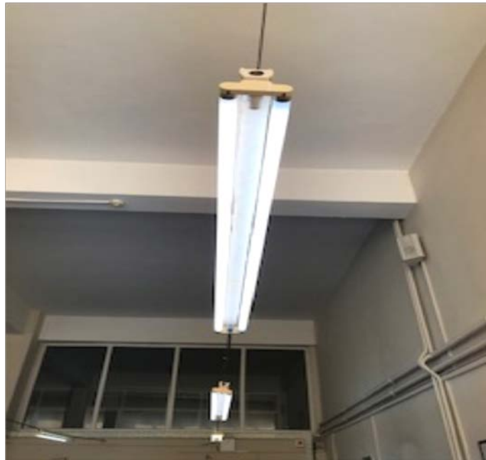
Şekil 34. Güvenilir Olmayan Aydınlatma Lambası
