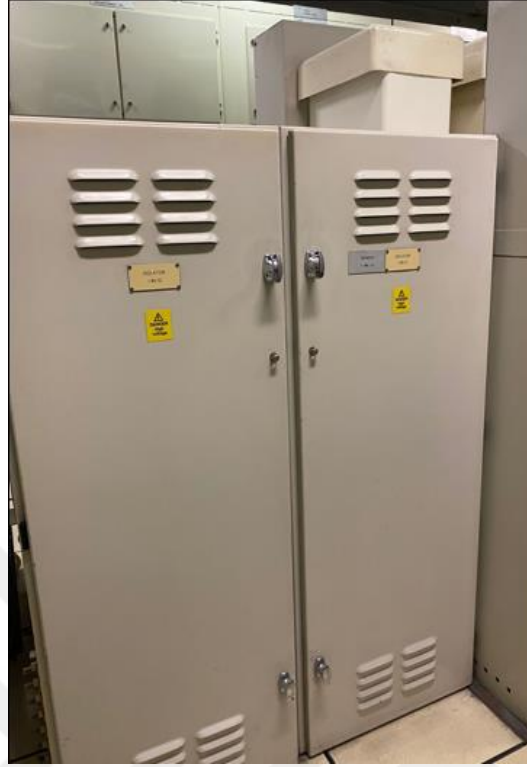
Şekil 7.8: Sağmalcılar trafo merkezi ayırıcılar.
