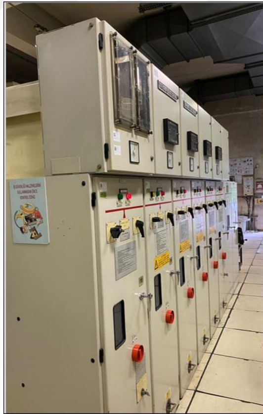
Şekil 7.7: Sağmalcılar trafo merkezi DC hücreler.
