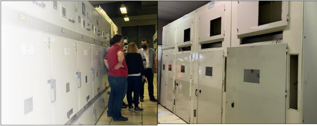
Şekil 7.5: Sağmalcılar trafo binası orta gerilim hücreleri.
