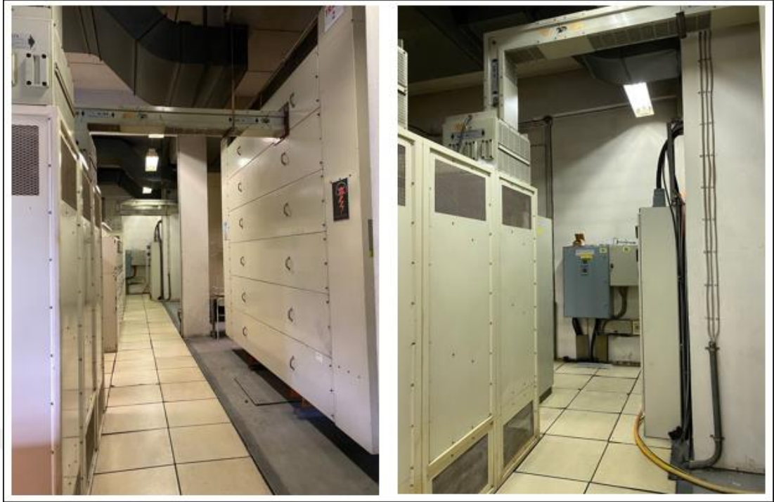
Şekil 7.6: Sağmalcılar trafo merkezi cer trafoları.
