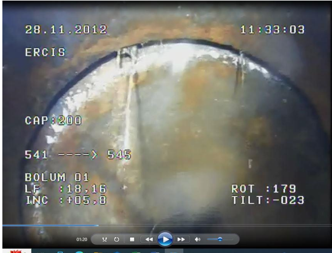
Şekil 5.8 541-545 boru hattı hafif hasar örneği
