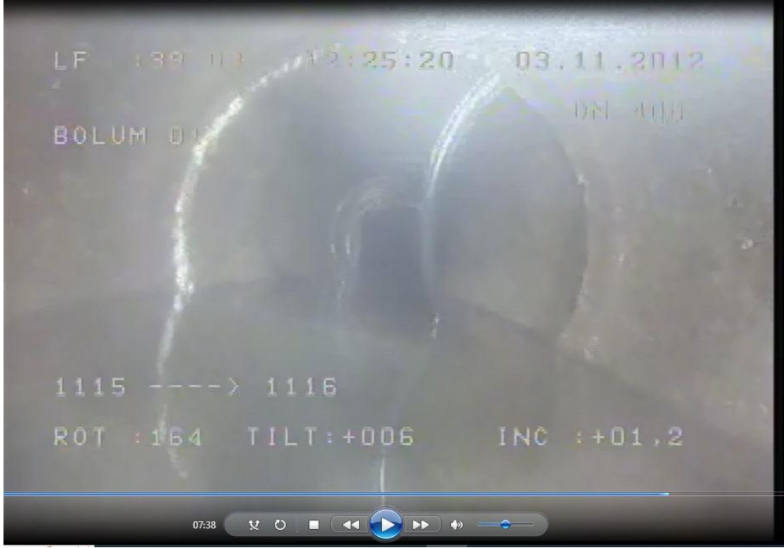
Şekil 5.23 1115-1116 boru hattı ağır hasar örneği
