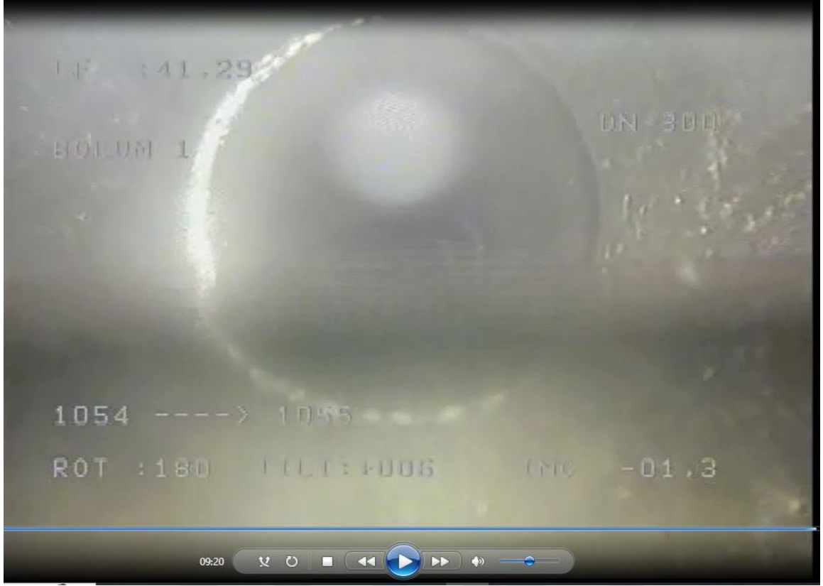
Şekil 5.13 1054-1055 boru hattı orta hasar örneği
