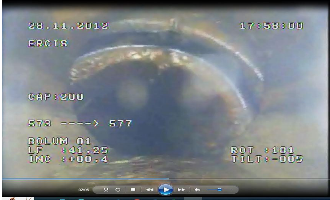
Şekil 5.18 573-577 boru hattı ağır hasar örneği
