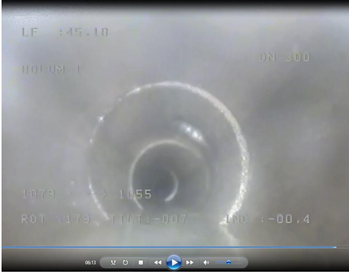
Şekil 5.12 1079-1055 boru hattı orta hasar örneği
