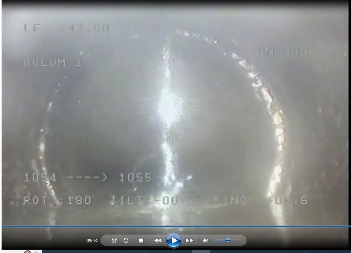
Şekil 5.15 1054-1055 boru hattı orta hasar örneği
