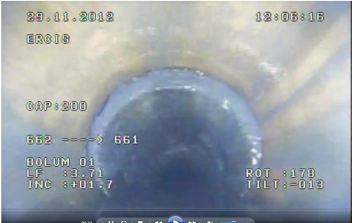
Şekil 5.6 662-661 boru hattı hafif hasar örneği
