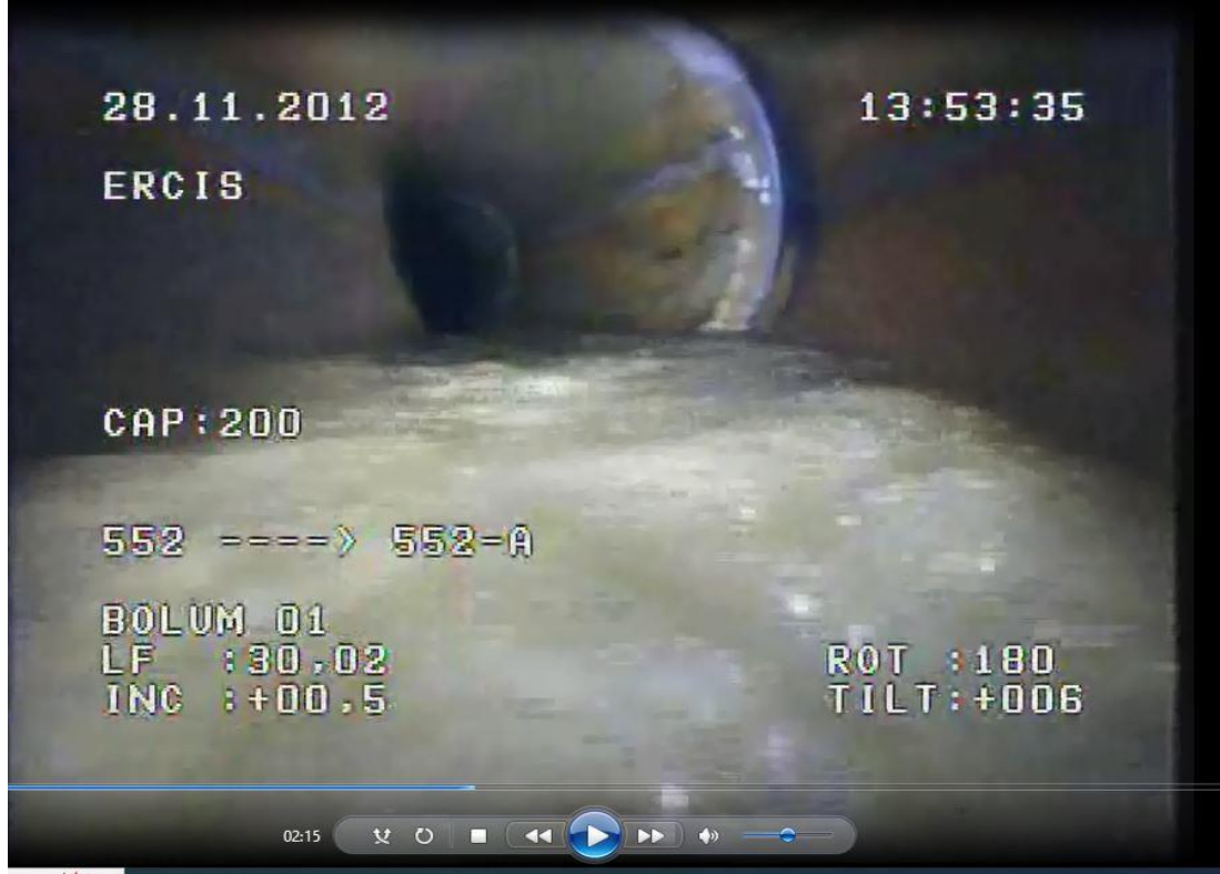
Şekil 5.4 552-552/A boru hattı hafif hasar örneği
