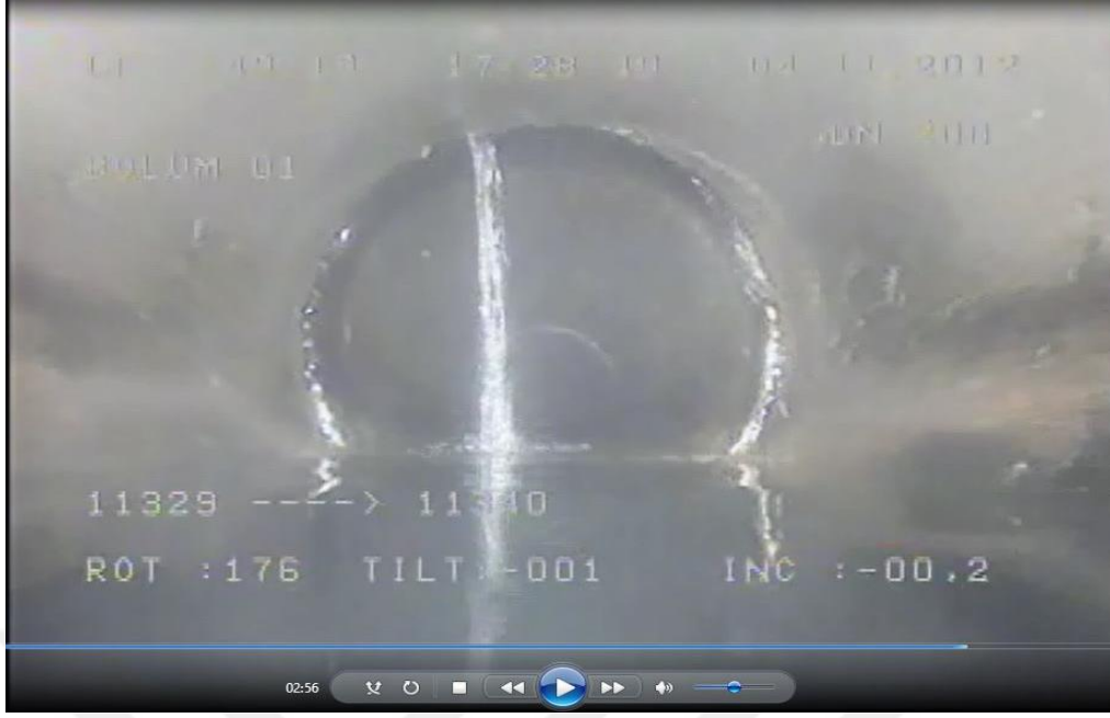
Şekil 5.9 11329-11340 boru hattı orta hasar örneği
