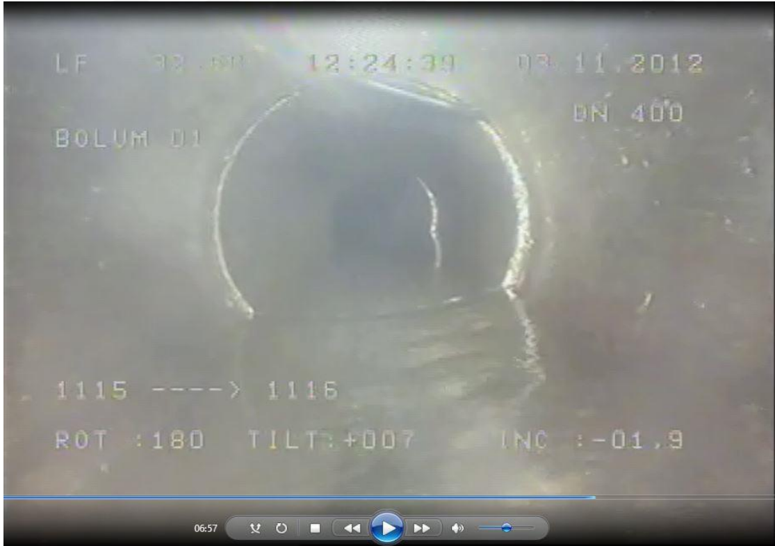
Şekil 5.22 1115-1116 boru hattı ağır hasar örneği
