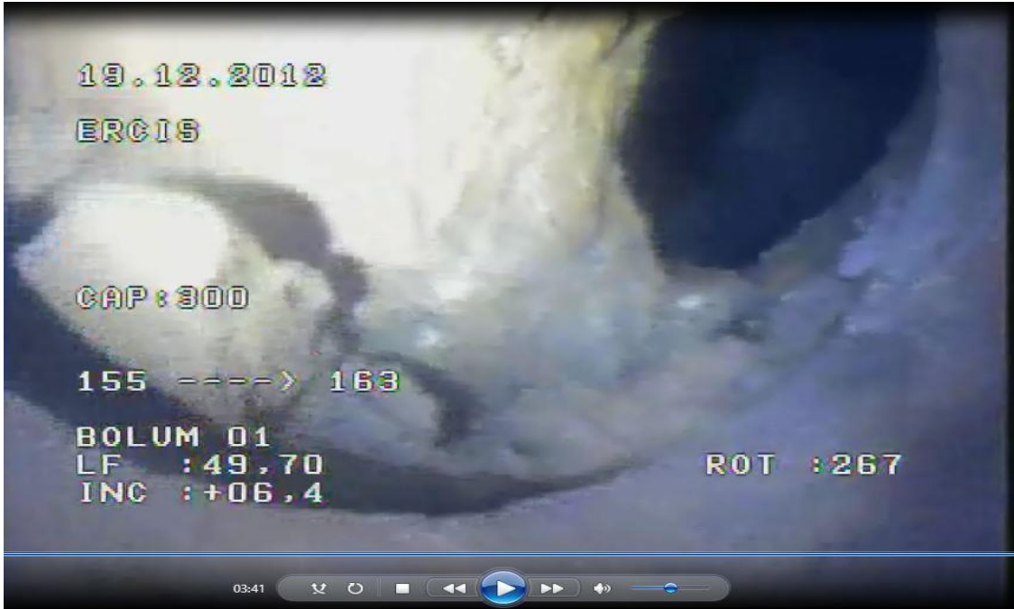
Şekil 5.28 155-163 boru hattı ağır hasar örneği
