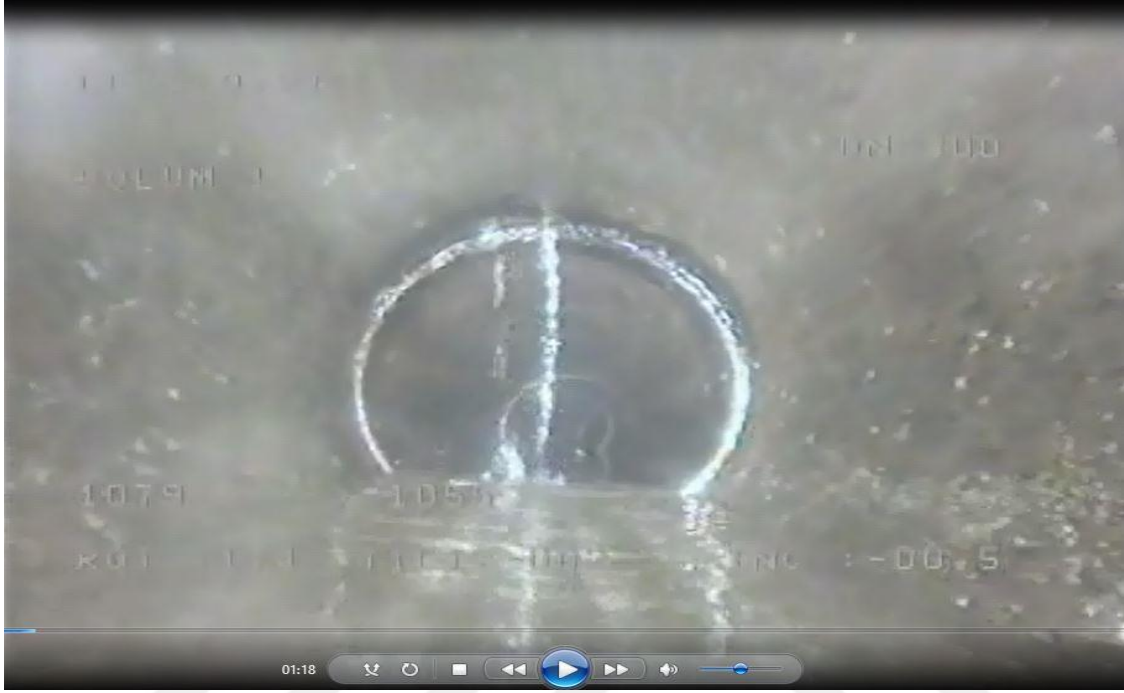
Şekil 5.11 1079-1055 boru hattı orta hasar örneği
