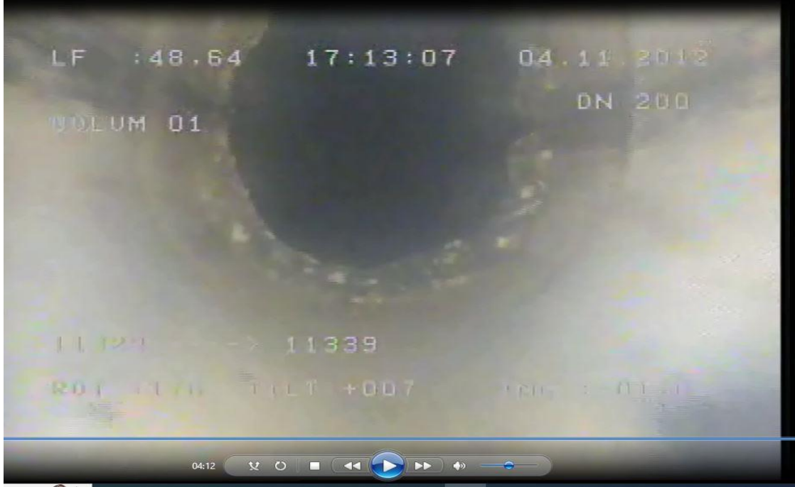
Şekil 5.16 11329-11339 boru hattı orta hasar örneği
