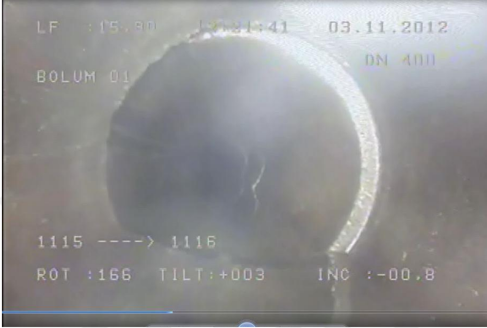
Şekil 5.20 1115-1116 boru hattı ağır hasar örneği
