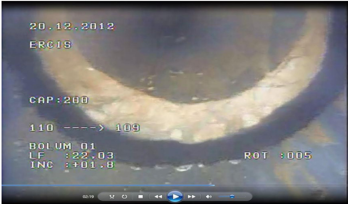
Şekil 5.25 110-109 boru hattı ağır hasar örneği
