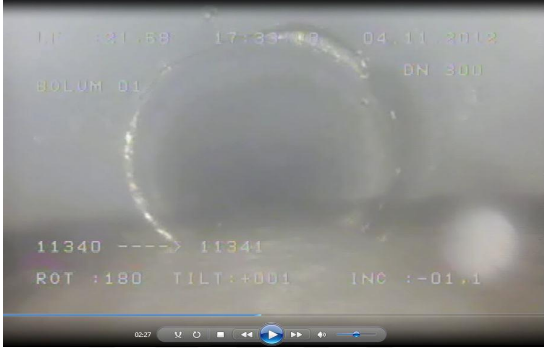
Şekil 5.24 11340-11341 boru hattı ağır hasar örneği
