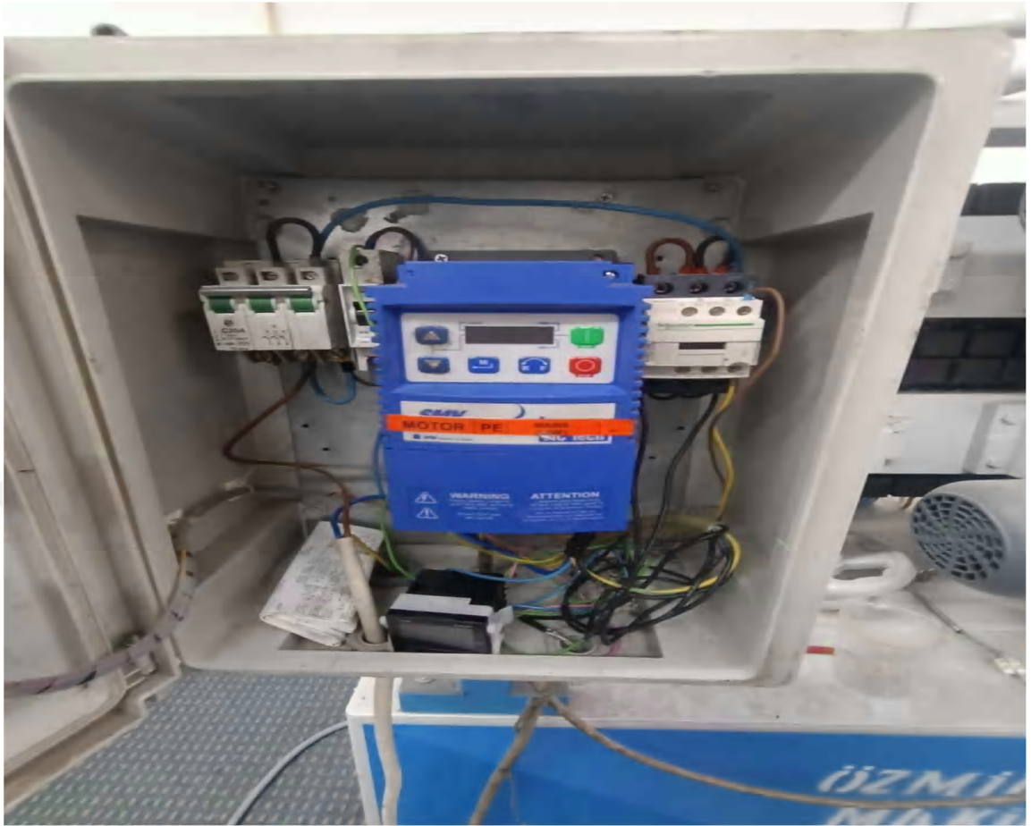
Şekil 2.4.4. Çekme işlemini sağlayan sisteminin kontrol panosu. Üstte büyük olan motorların hızını belirleyen kontrol ekranı, alttaki küçük ekran ile sıcaklık kontrolünün yapıldığı ekran.
