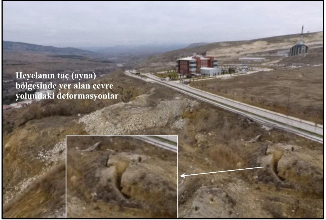
Şekil 4.3 Heyelan sahasının ve heyelan sahasında kalan yol güzergahındaki deformasyon ve gerilme çatlaklarının durumu (İHA Görüntüsü)
