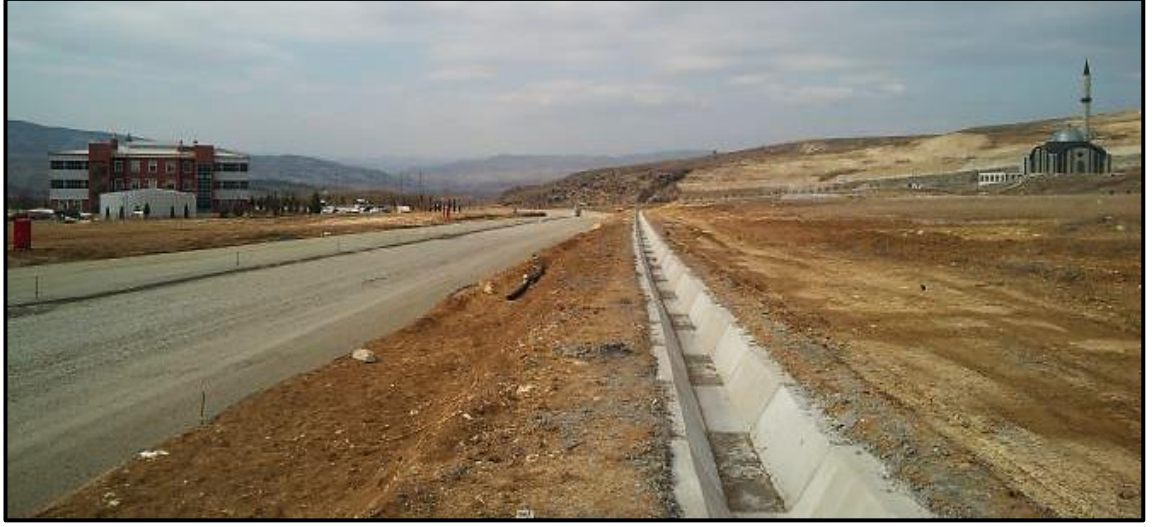
Şekil 4.30 Uluyazı Kampüsünde yüzey drenaj sistemi
