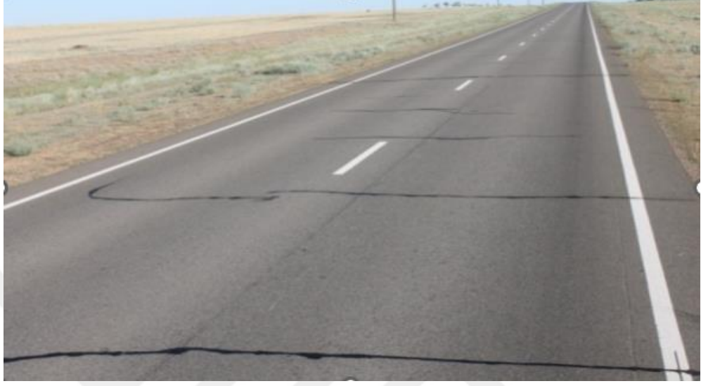
Şekil 3.14 Yolun asfalt beton kaplamasının düşük sıcaklıkta çatlaması (Bagdat 2016)
