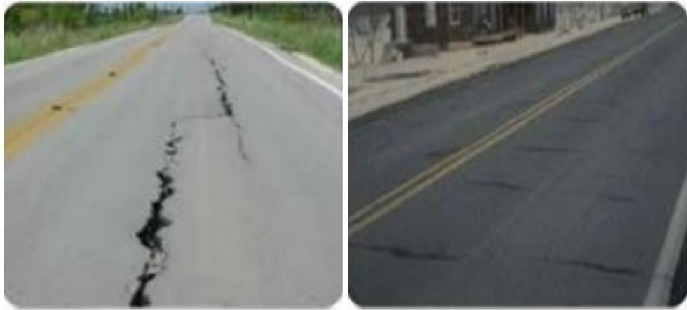
Şekil 3.10 a). Asfalt esnek kaplamada boyuna çatlama, b). Asfalt esnek eaplamada enine çatlama ( Basheer and Ahmad 2020)
