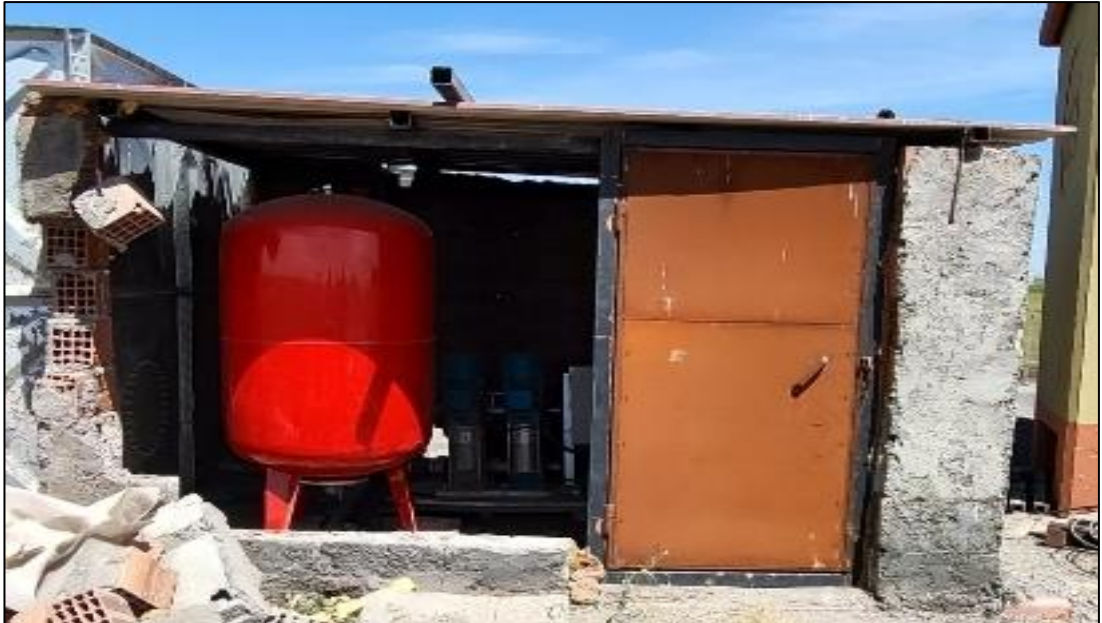
Şekil 3.15 Kompresör ve hidrofor tankı
