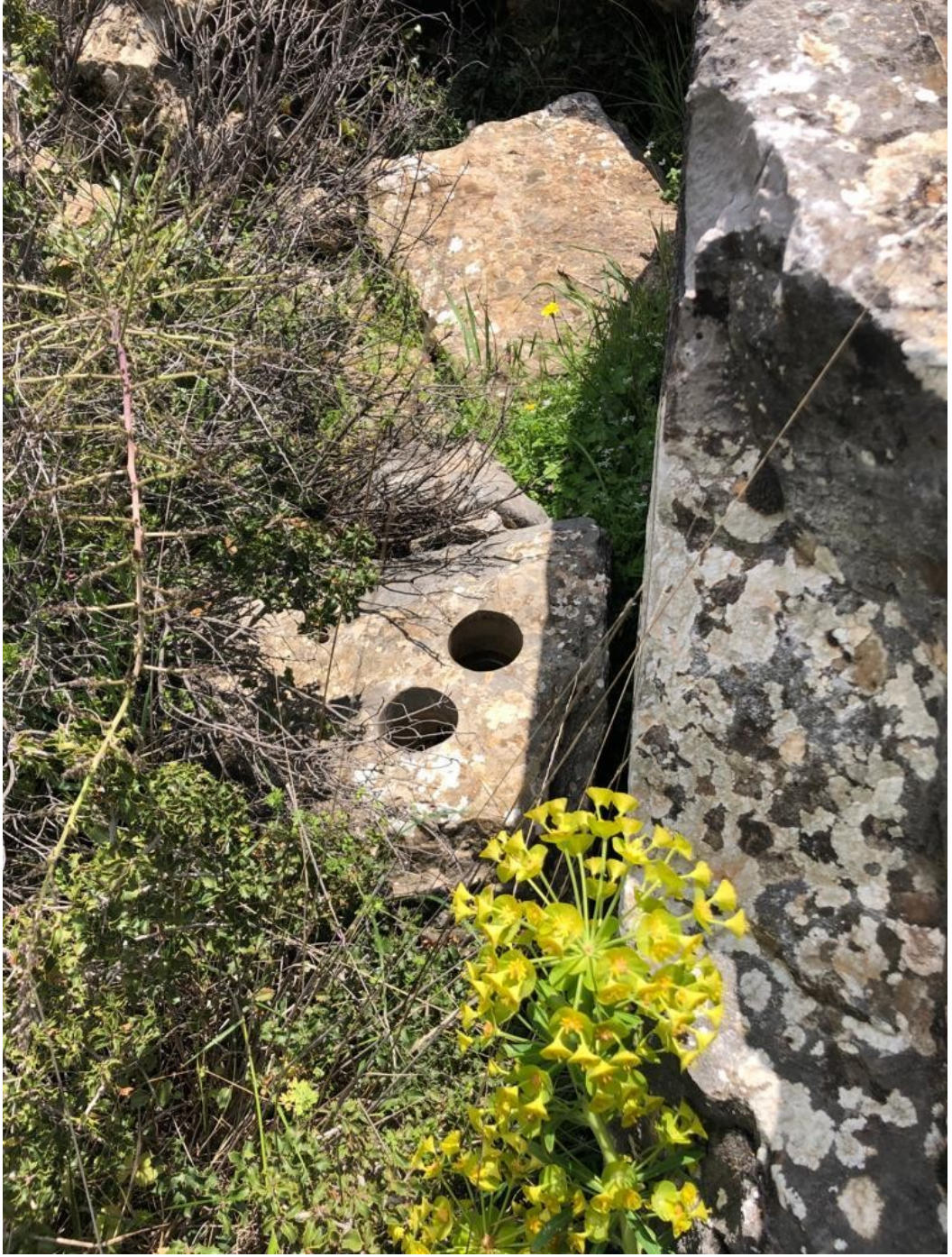
Karot makinası tahribatı
