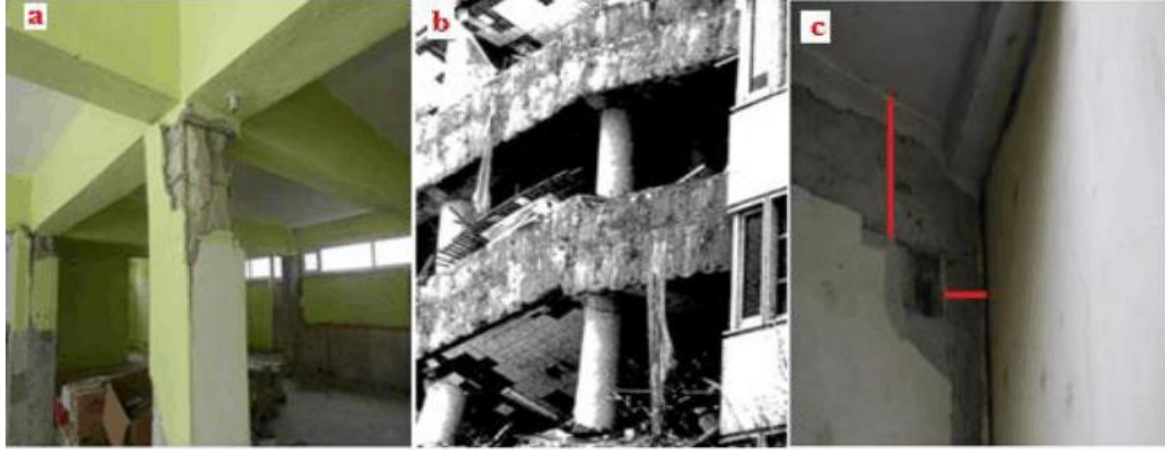
Şekil 3.2. Güçlü kiriş zayıf kolon hasarları a- Simav depremi, b- Kobe depremi, c- Van depremi [30]
