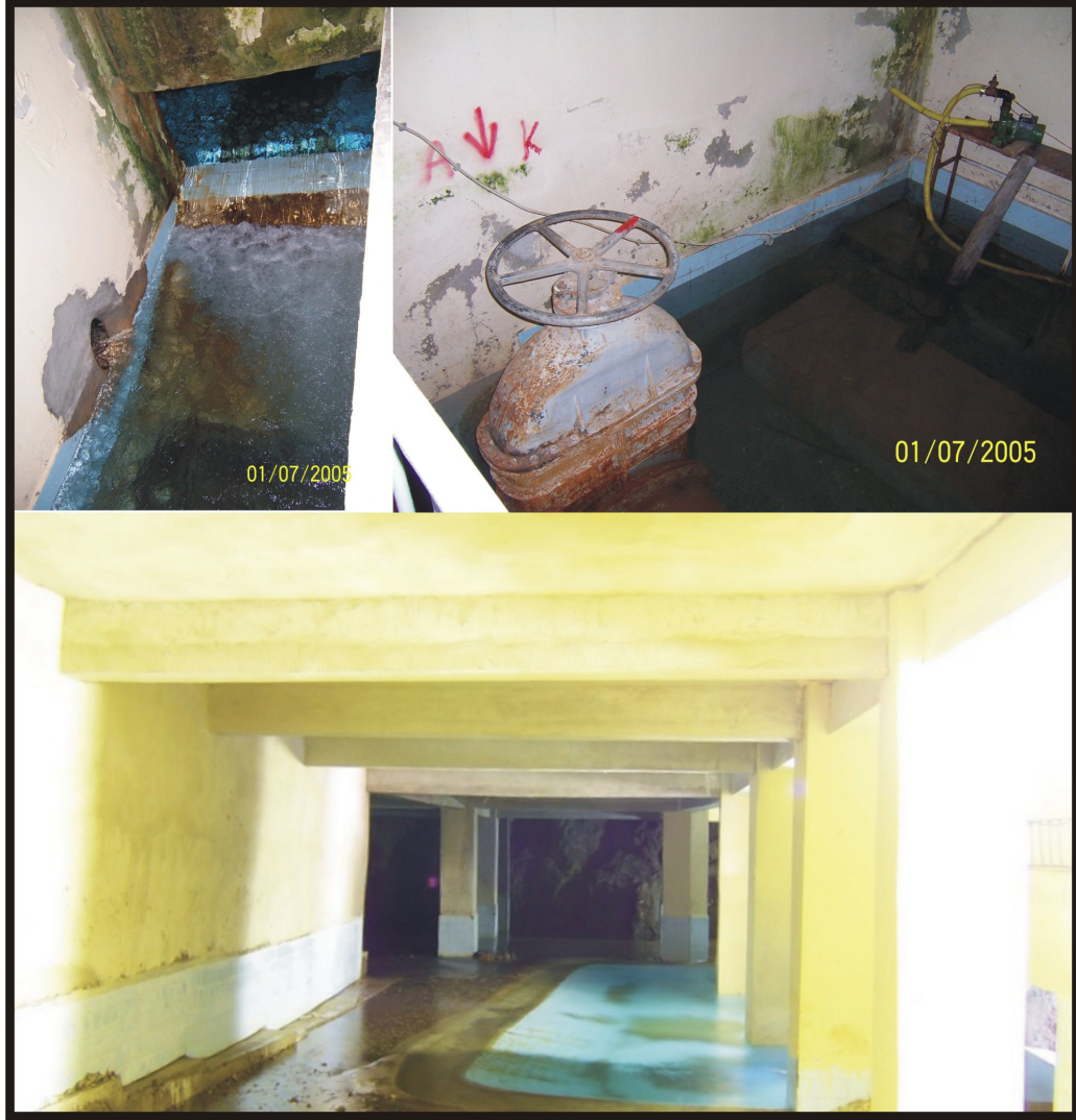
Şekil 3.11 Toplanan suyun borularla iletilmesi ve ana kaynağın kaptaj içerisinden görünümü.
