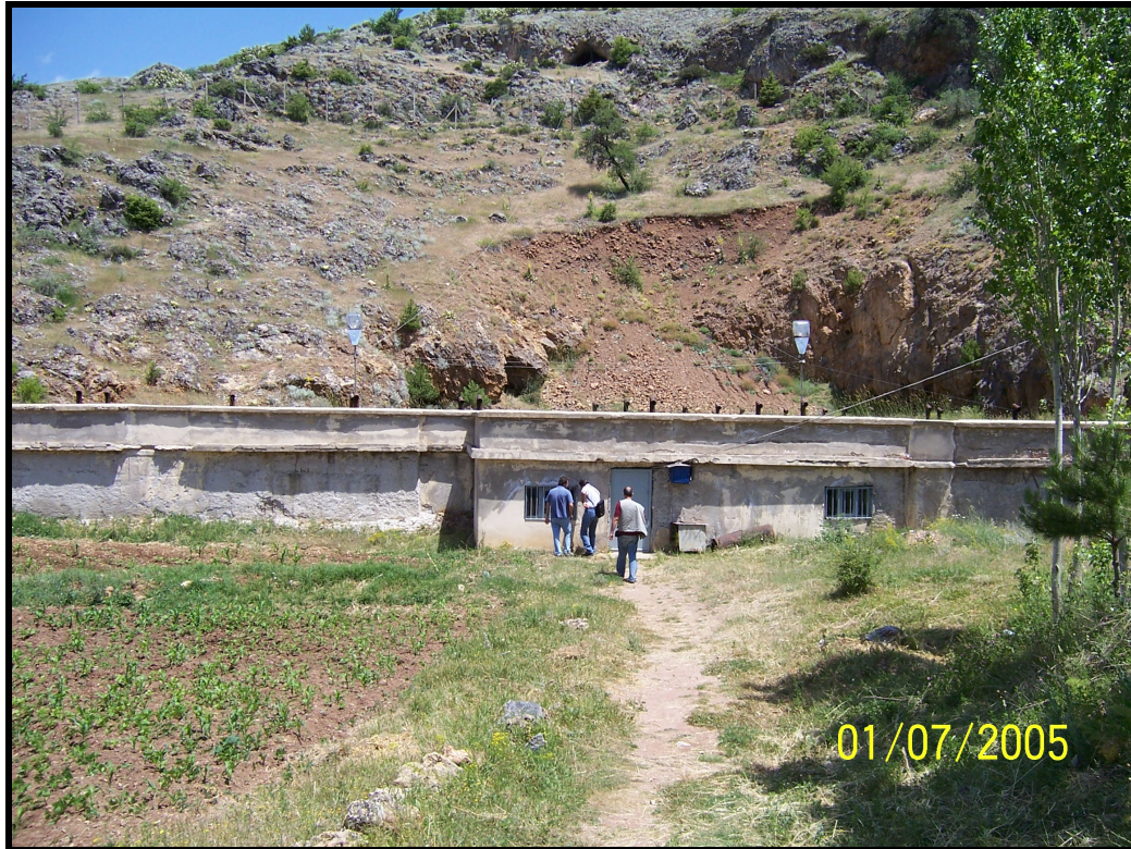
Şekil 3.10 Çokrağan Kaynağında yer alan kaptajın dışardan görünümü.
