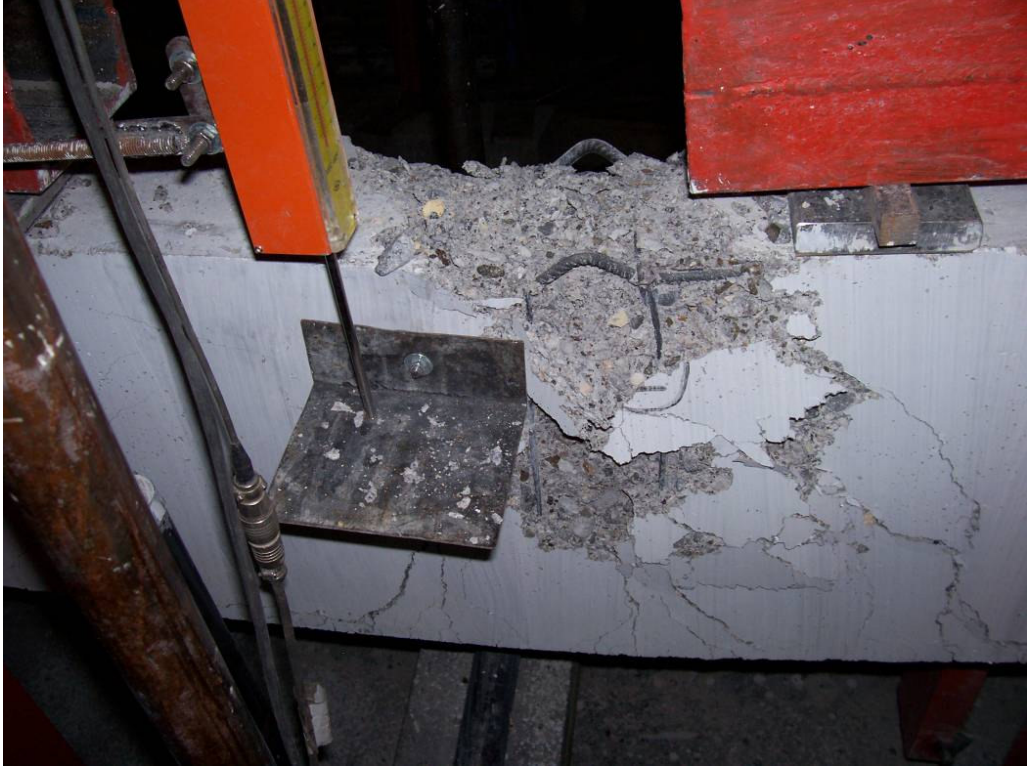
Resim 5.8. B B kirişinde betonda ezilme ve basınç donatısında burkulma
