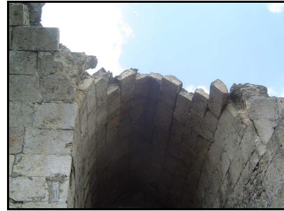
Resim 4.55 Yıkılan bölüm b
