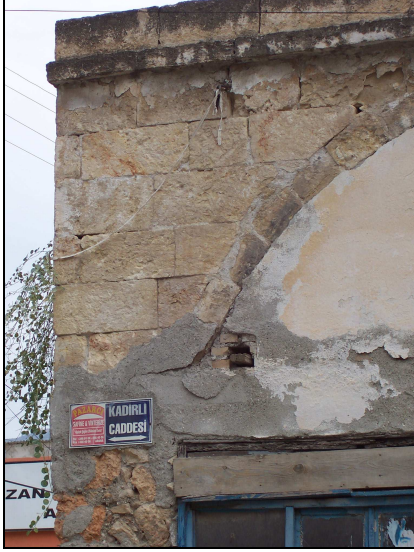
Resim 5.8. Ön cephe sıva müdahale izleri
