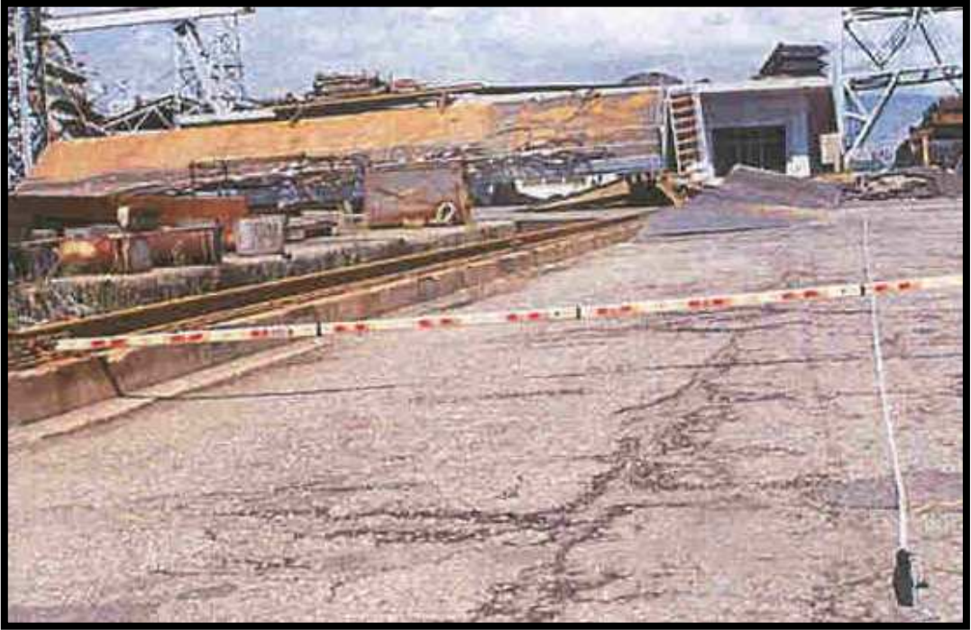
Resim 16: Gölcük Tersanesi. Kreyn Rayının Yüzey Kırığı Tarafından Ötelenmesi. Rayda Ölçülen Sağ Yanal Yer Değiştirme Miktarı 4.20 m'dir. Kuzey bakış (MTA 2003 Gn. Md.'lüğü).
