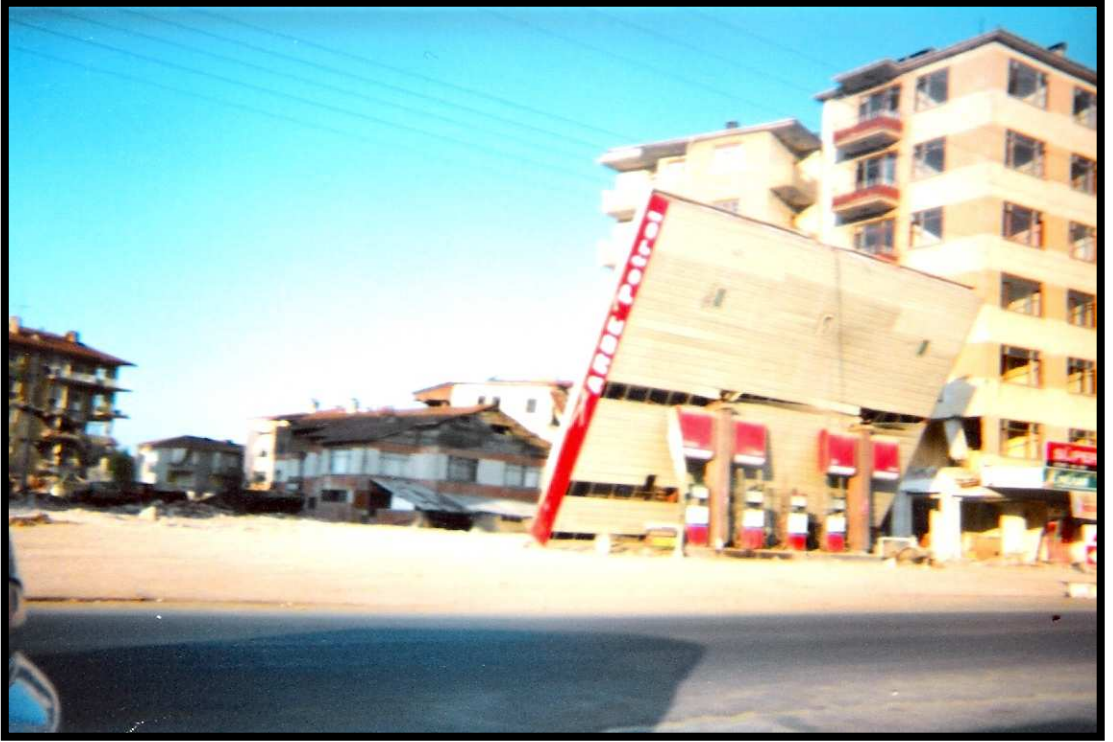
Resim12: Gölcük –Değirmendere Arasında Hasar Gören Benzin İstasyonu (20 Ağustos 1999).
