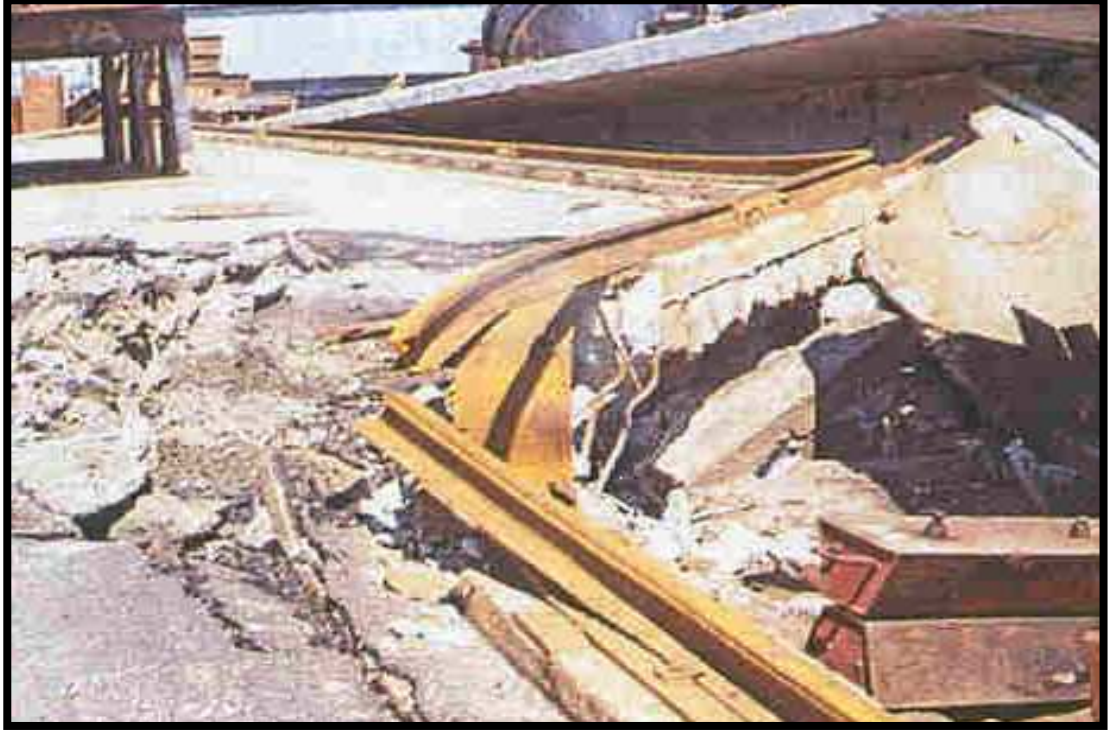
Resim 17: Gölcük Tersanesi. Kreyn Rayında Sağ Yönlü Yer Değiştirmeyeyle Meydana Gelen Deformasyon (MTA 2003 Gn. Md.'lüğü).
