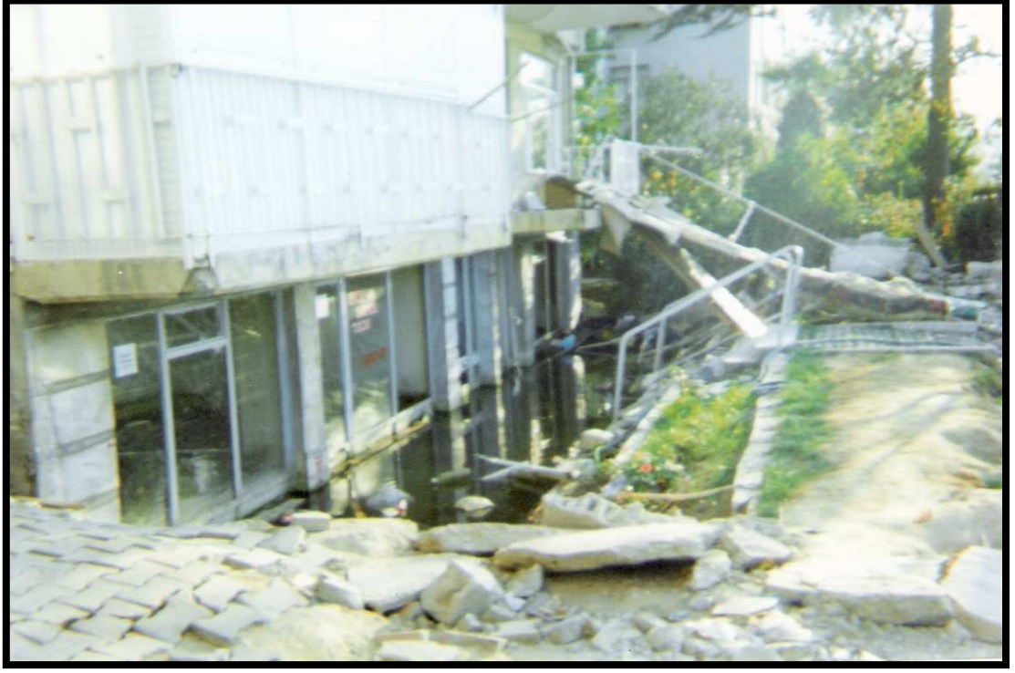
Resim 9: 1999 Marmara Depremi Sonucunda Gölcük-Değirmendere Arası Sıvılaşma Nedeniyle Hasar Gören İşyeri (20 Ağustos 1999).
