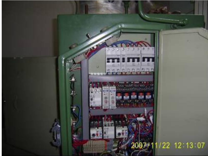
Şekil 3.3. Elektrik panosu ve zaman kontrol ünitesi
