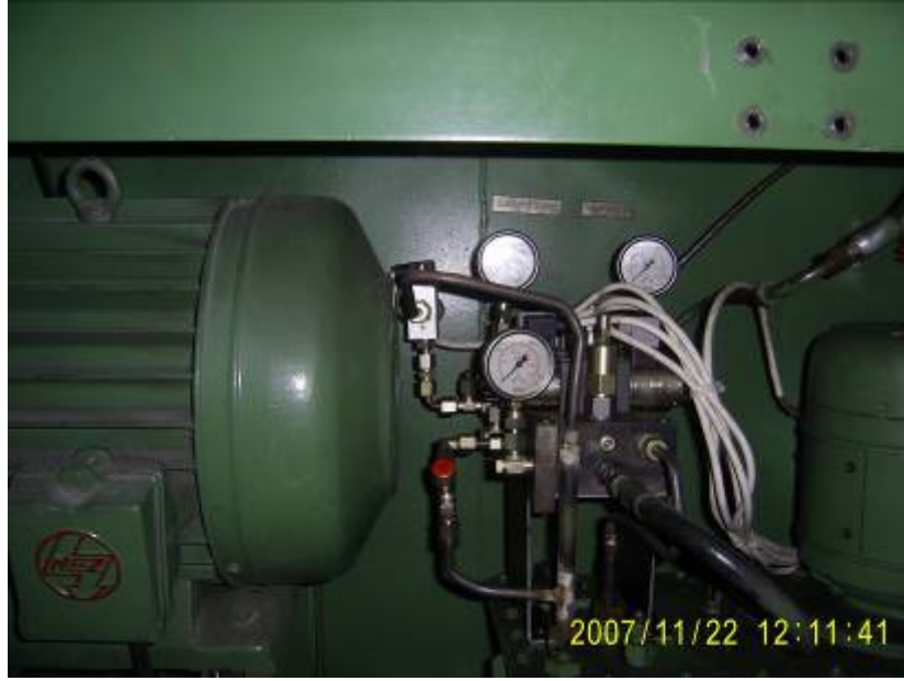
Şekil 3.2. Elektrik motoru, hidrolik pompa motoru ve basınç düzeneği
