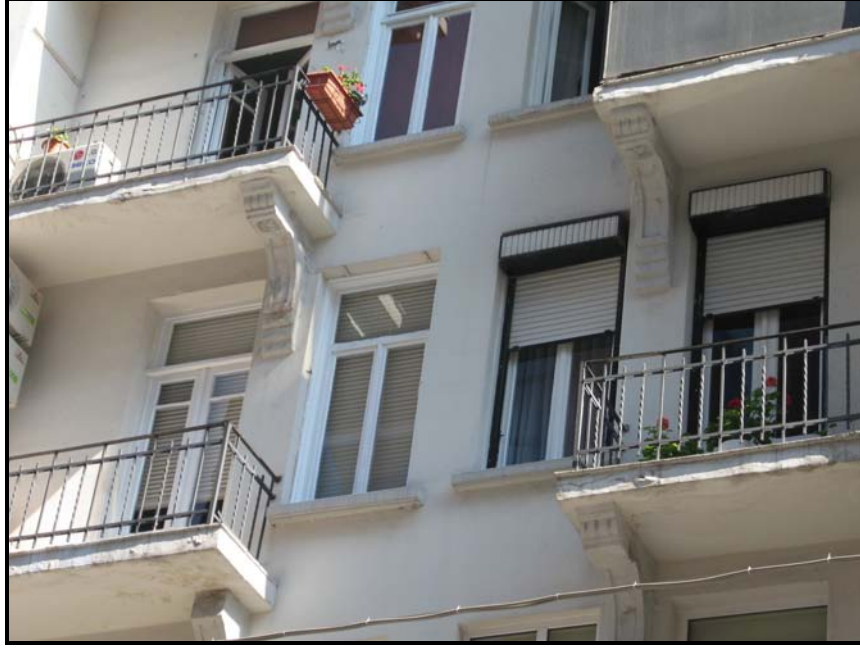
Resim 75 : Cumhuriyet Apartman›, arka cephe konsolları, Gümüşsuyu. Derya ÖZAKBAŞ'tan.
