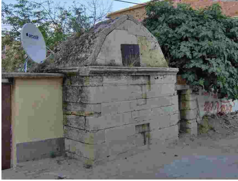
Fot.106: Damat Sokağı Çeşmesi
