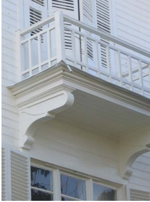
Resim no: 56A. Spanudis Köşkü. Çayır Aralığı Sokak, No:15. Konsol detayı.
