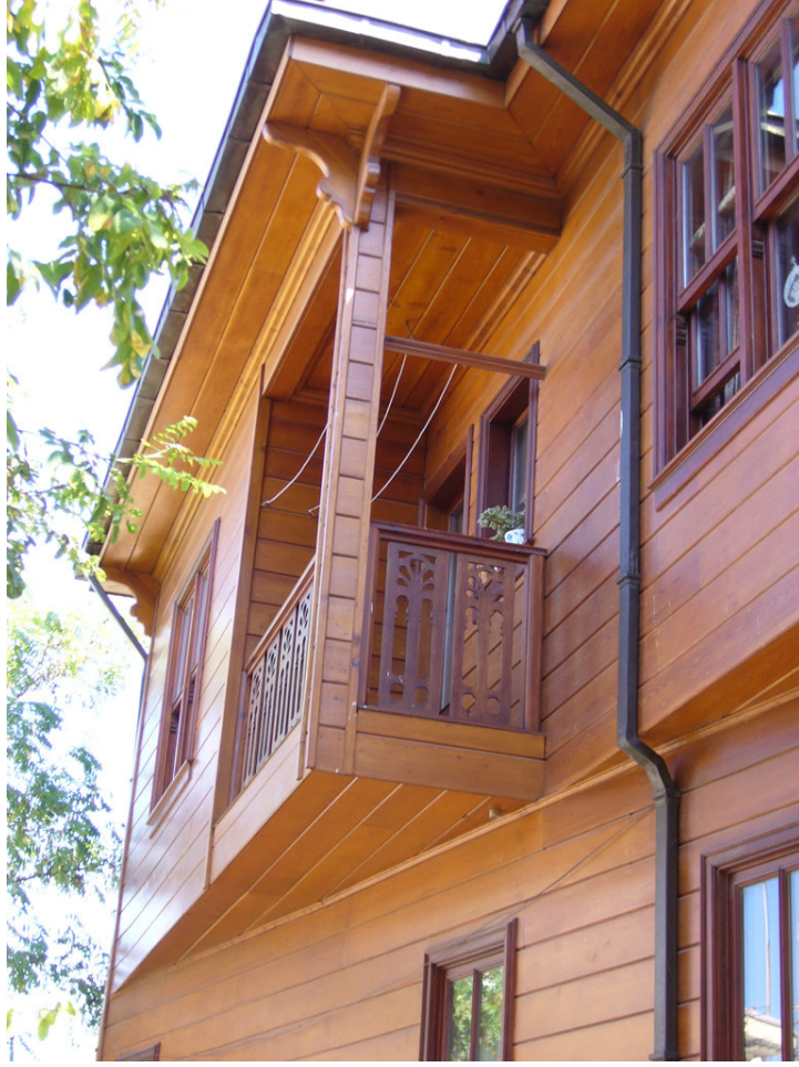
Resim no: 33A. Gökdemir Sokak, No:4. Balkon detayı.
