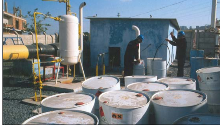
Şekil 1.28. Doğalgaz kokulandırma ünitesi
