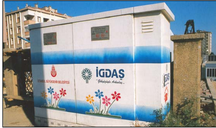
Şekil 1.29. Doğalgaz bölge regülatörü
