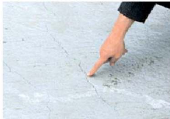
Şekil 3.3 Plastik rötire çatlağı [9]
