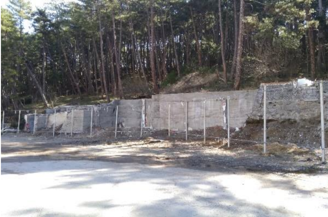
Resim 6: Altın Su Tesisi Yıkıntıları
