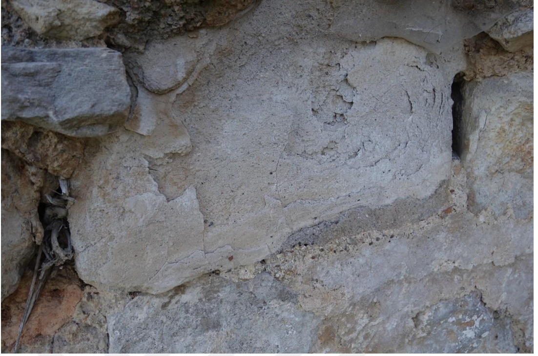
Resim 280 Aralık Bölümü Batı Duvarı (2 Nolu) f. Kabuklanma
