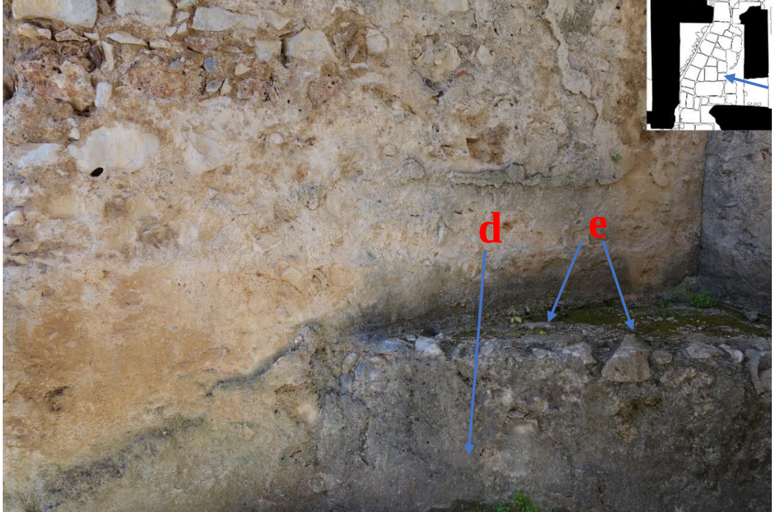
Resim 41 Aralık Bölümü Güney Duvarı ve Seki Görünüşü (2 Nolu) d. Renk Değişimi e. Köklü Bitki ve Biyolojik Oluşum
