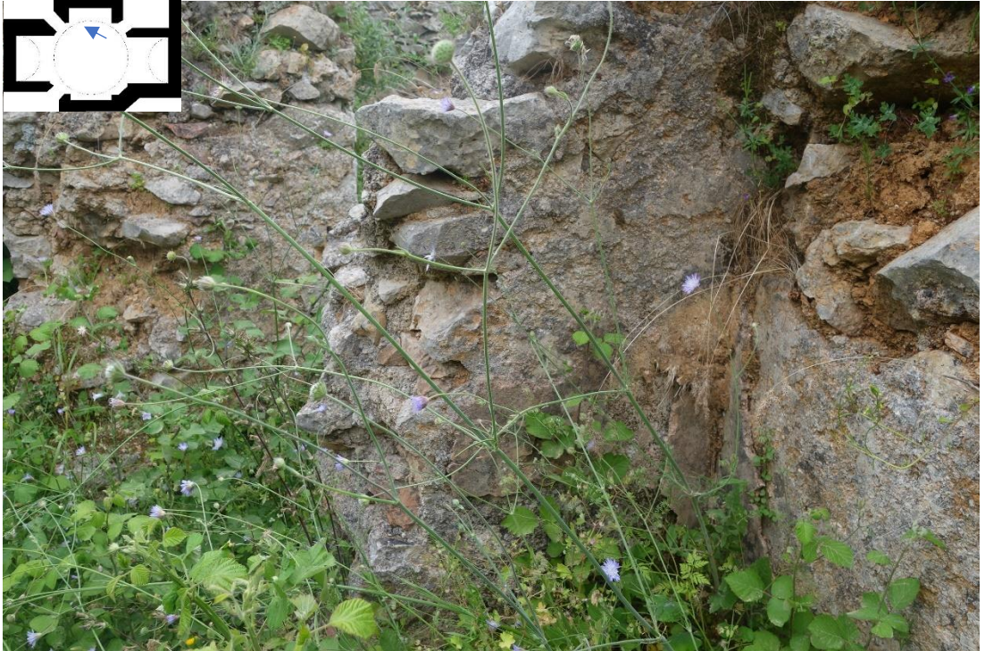
Resim 453 Sıcaklık Bölümü Kuzey Eyvanı (6 Nolu) a. Malzeme Kaybı d. Renk Değişimi e. Biyolojik Oluşumlar ve Köklü Bitkiler
