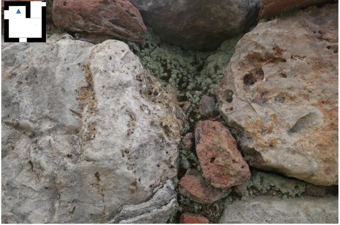
Resim 532 Soyunmalık Bölümü Batı Duvar Harç Malzeme (1 Nolu) a. Malzeme Kaybı e. Biyolojik Oluşum
