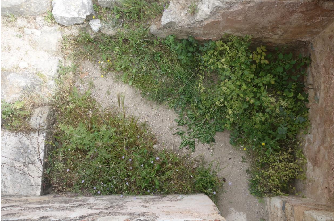
Resim 535 Aralık Bölümü Zemin (2 Nolu) a. Malzeme Kaybı e.Köklü Bitkiler
