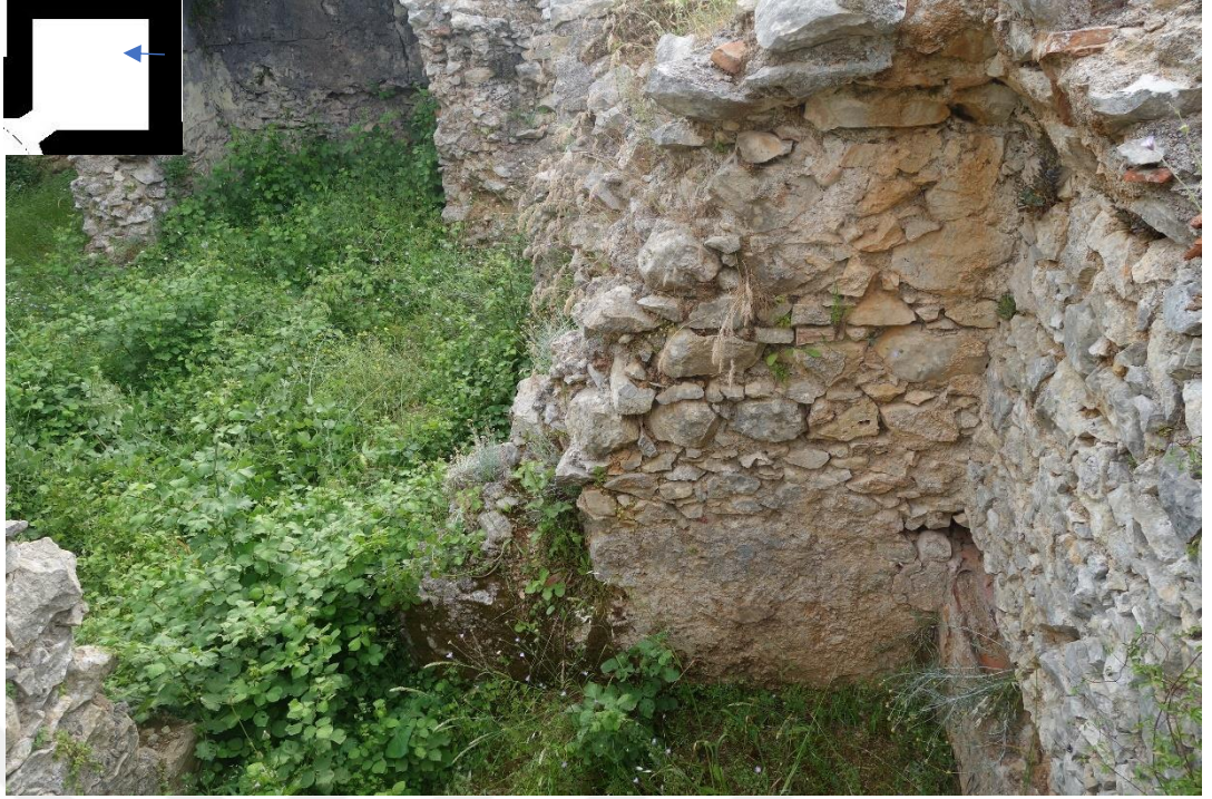
Resim 466 Doğu Halvet Bölümü Doğu Duvarı (7 Nolu) a. Malzeme Kaybı e. Biyolojik Oluşumlar ve Köklü Bitkiler
