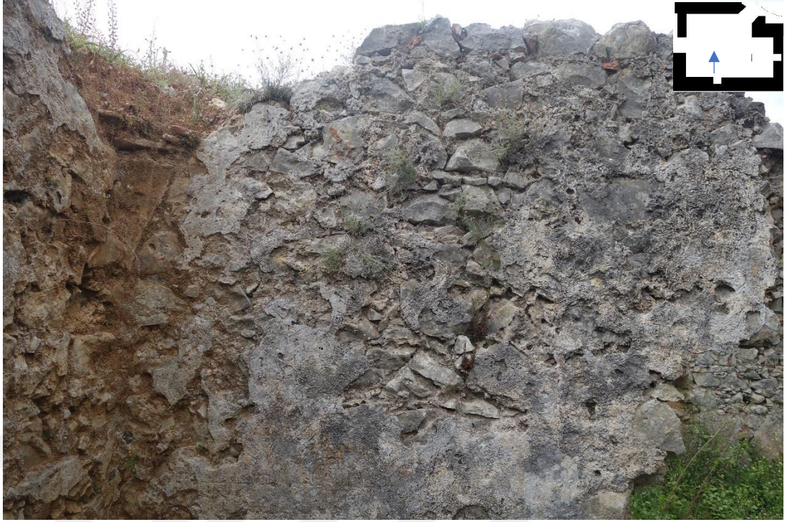
Resim 422 Ilıklık Bölümü Kuzey Duvarı ve Geçiş Ögesi (4 Nolu) a. Malzeme Kaybı c. Petek Gözlülük d. Renk Değişimi e. Biyolojik Oluşumlar ve Köklü Bitkiler
