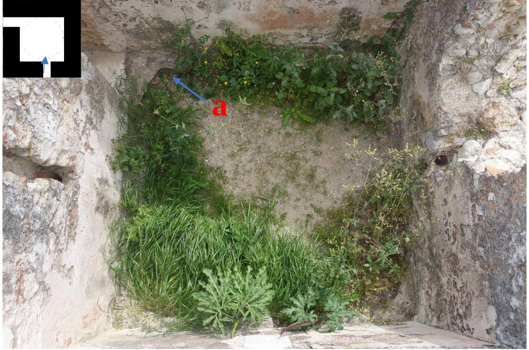
Resim 545 Sıcaklık Bölümü Zemin (3 Nolu) a. Malzeme Kaybı e. Köklü Bitkiler
