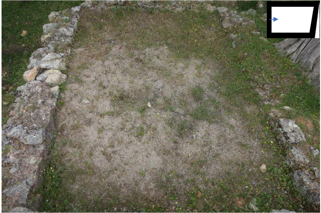
Resim 511 Su Deposu Bölümü (2) Zemin ve Çevre Duvarları (10 Nolu) a. Malzeme Kaybı e. Köklü Bitkiler
