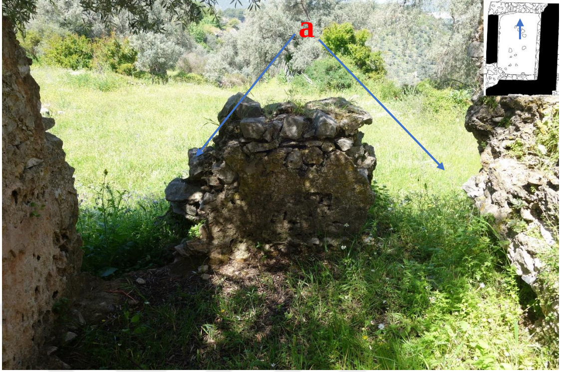
Resim 185 Ek Mekân Batı Duvarı (12 Nolu) a. Malzeme Kaybı
