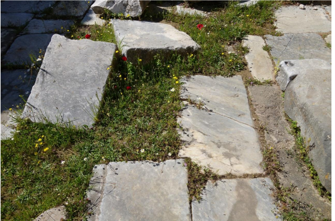
Resim 11 Soyunmalık Bölümü Zemin (1 nolu) a. Çatlak e. Köklü Bitkiler
