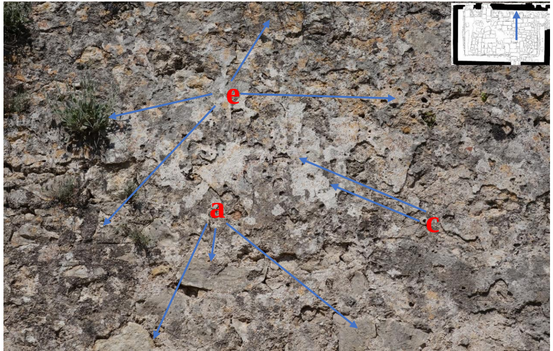
Resim 29 Soyunmalık Bölümü Sıva Malzeme (1 Nolu) a. Malzeme Kaybı b. Petek Gözlülük e. Köklü Bitkiler ve Biyolojik Oluşum
