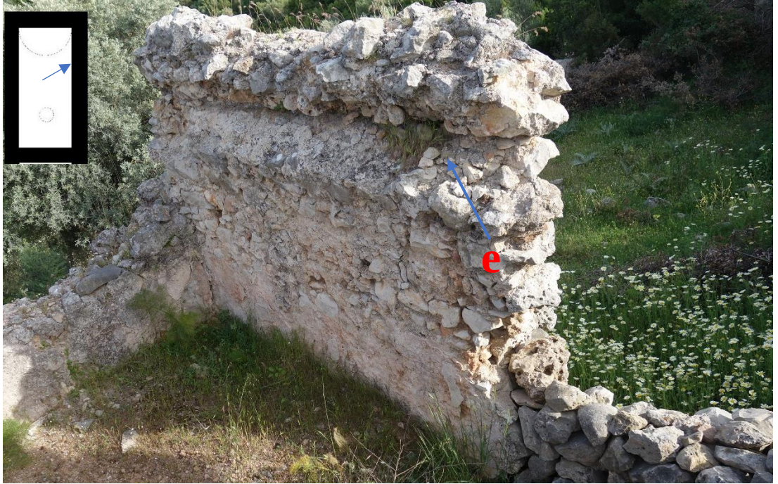
Resim 339 Su Deposu Bölümü Güney Duvar (8 Nolu) a. Malzeme Kaybı e. Köklü Bitkiler
