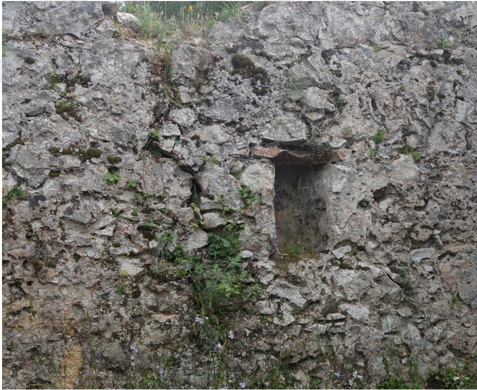
Resim 425 Ilıklık Bölümü Kuzey Duvarı (4 Nolu)
