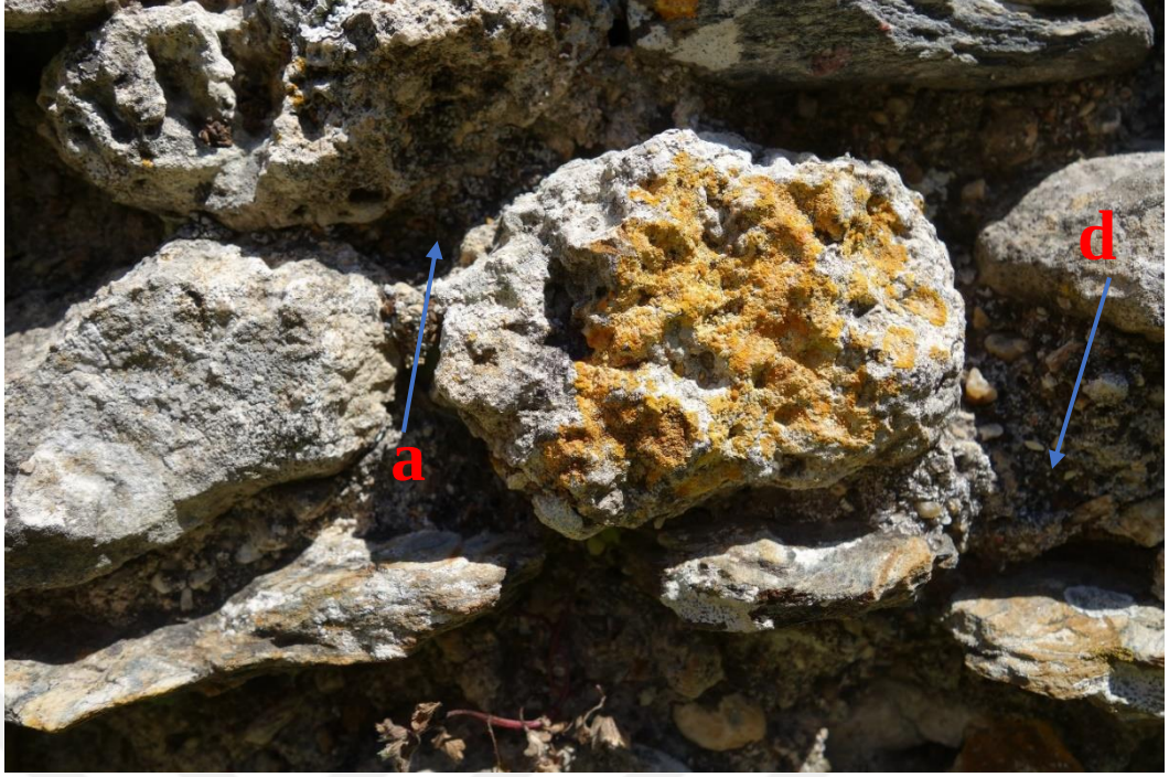
Resim 211 Sıcaklık Bölümü Kuzey Duvarı ve Harç Malzeme (2 Nolu) a. Malzeme kaybı d. Renk Değişimi e. Biyolojik Oluşum
