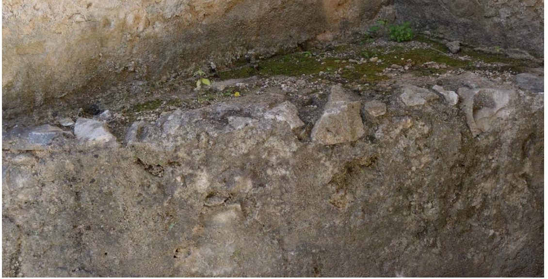
Resim 42 Aralık Bölümü Güney Duvarı ve Seki Görünüşü (2 Nolu) d. Renk Değişimi e. Köklü Bitki ve Biyolojik Oluşum
