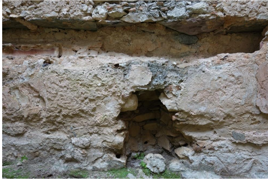
Resim 145 Doğu Halvet Odası Batı Duvarı (8 Nolu) a. Malzeme Kaybı
