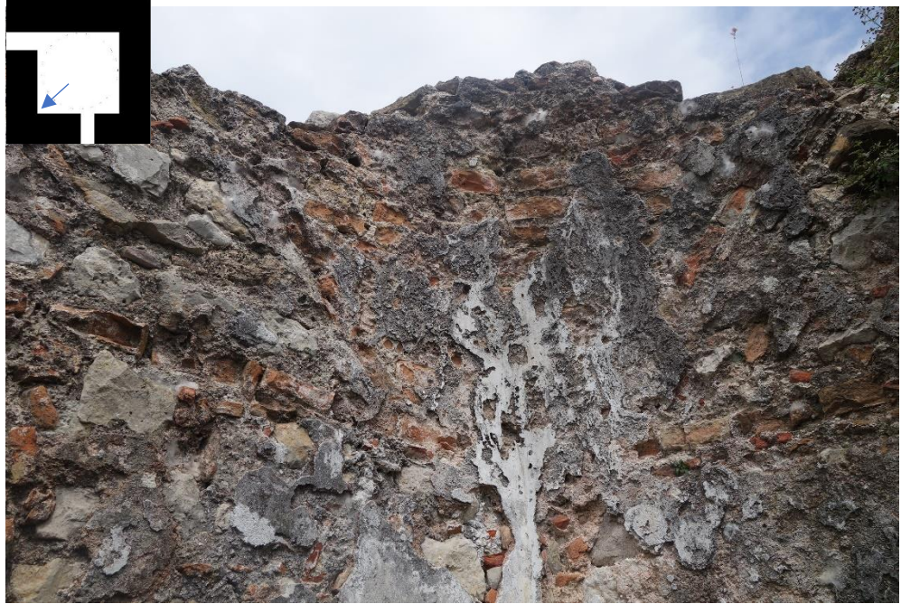
Resim 557 Sıcaklık Bölümü Güneydoğu Geçiş Ögesi (3 Nolu) a. Malzeme Kaybı e. Renk Değişimi
