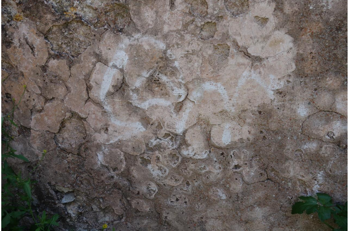
Resim 206 Sıcaklık Bölümü Doğu Duvarı (2 Nolu) h. Vandalizm
