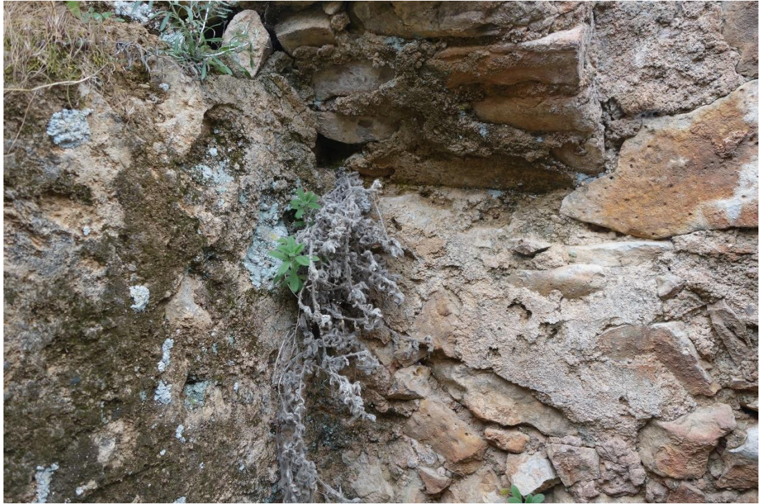
Resim 409 Hela Bölümü Güney Duvar Harç ve Sıva Malzeme (3 Nolu) a. Malzeme Kaybı d. Renk Değişimi e. Biyolojik Oluşum ve Köklü Bitkiler
