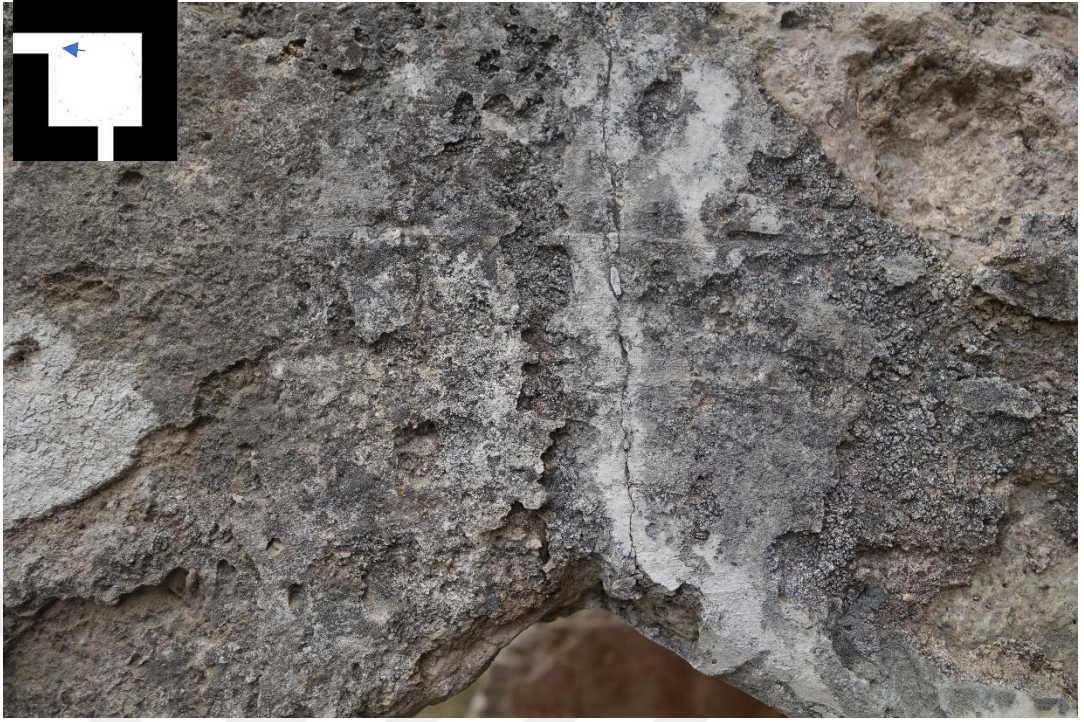
Resim 560 Sıcaklık Bölümü Giriş Açıklık Kemer (3 Nolu) b. Çatlak
