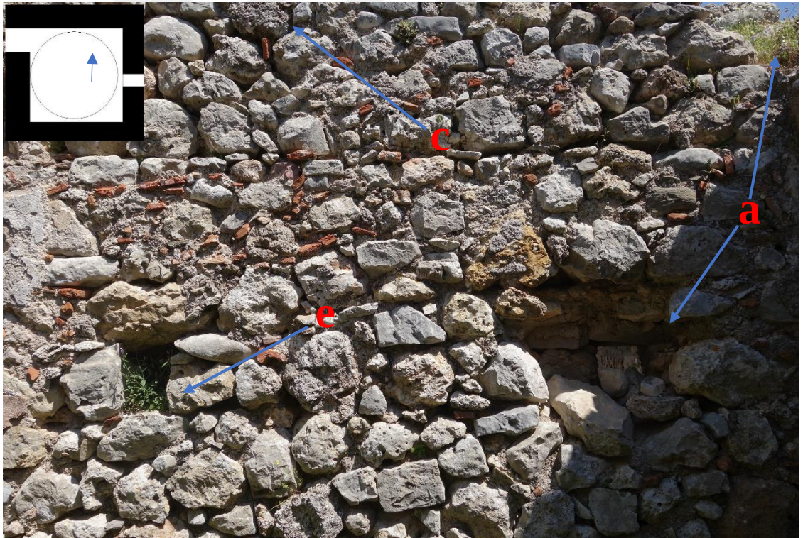
Resim 241 Güney Halvet Odası Kuzey Duvarı (4 Nolu) a. Malzeme Kaybı c. Petek Gözlük e. Köklü Bitkiler
