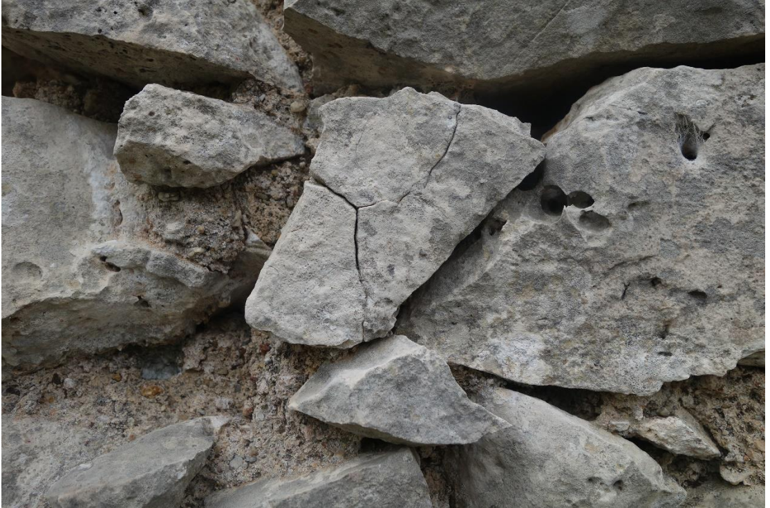
Resim 381 Soyunmalık Bölümü Kuzey Duvar (1 Nolu) b. Çatlak
