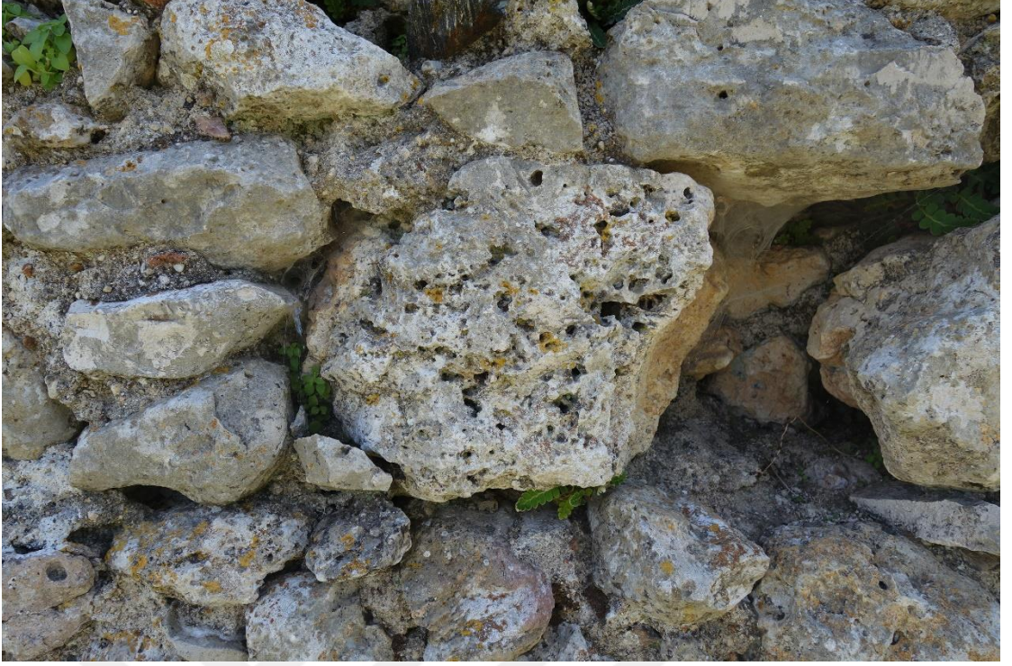
Resim 201 Soyunmalık Bölümü Doğu Duvarı (1 Nolu) c. Petek Gözlülük e. Köklü Bitkiler
