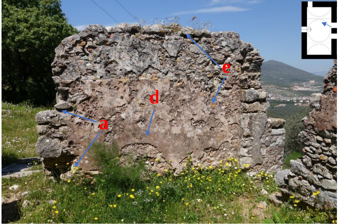
Resim 208 Sıcaklık Bölümü Batı Duvarı (2 Nolu) a. Malzeme Kaybı d. Renk Değişimi e. Biyolojik Oluşum ve Köklü Bitkiler
