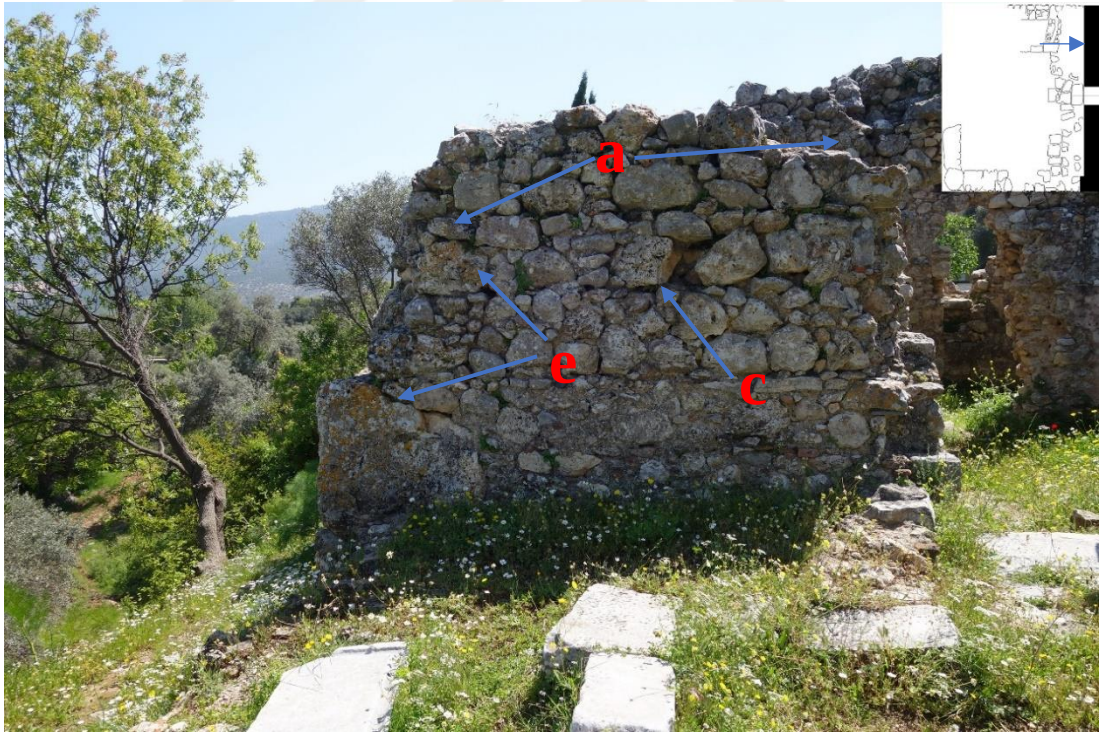
Resim 200 Soyunmalık Bölümü Doğu Duvarı (1 Nolu) a. Malzeme Kaybı c. Petek Gözlülük e. Biyolojik Oluşumlar ve Köklü Bitkiler
