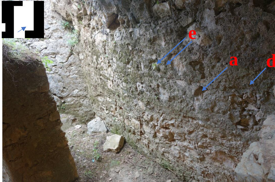
Resim 397 Tıraşlık Bölümü Doğu Duvar (3 Nolu) a. Malzeme Kaybı e. Biyolojik Oluşum
