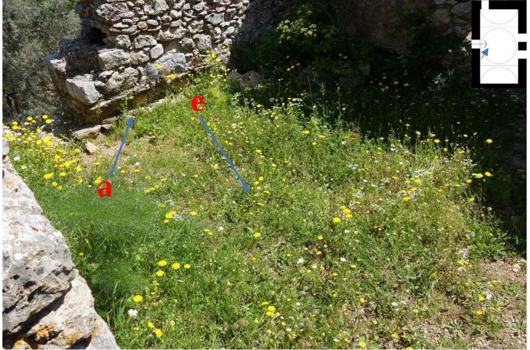
Resim 204 Sıcaklık Bölümü Zemin (2 Nolu) a. Malzeme Kaybı e. Köklü Bitkiler
