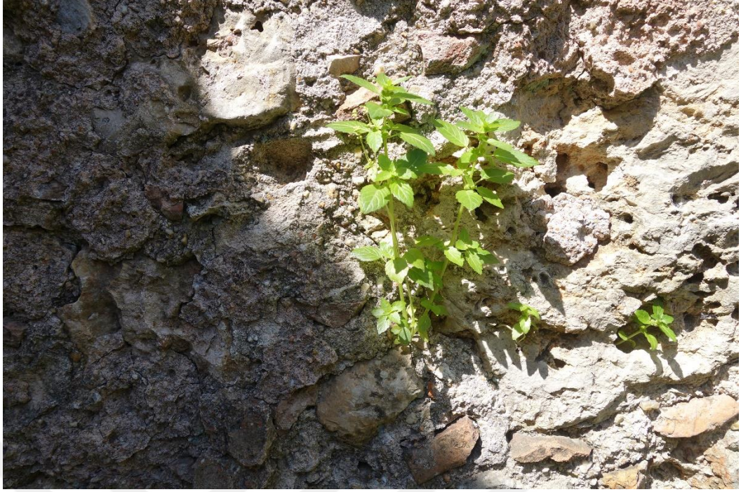
Resim 240 Güney Halvet Odası Batı Duvarı (4 Nolu) e. Köklü Bitkiler
