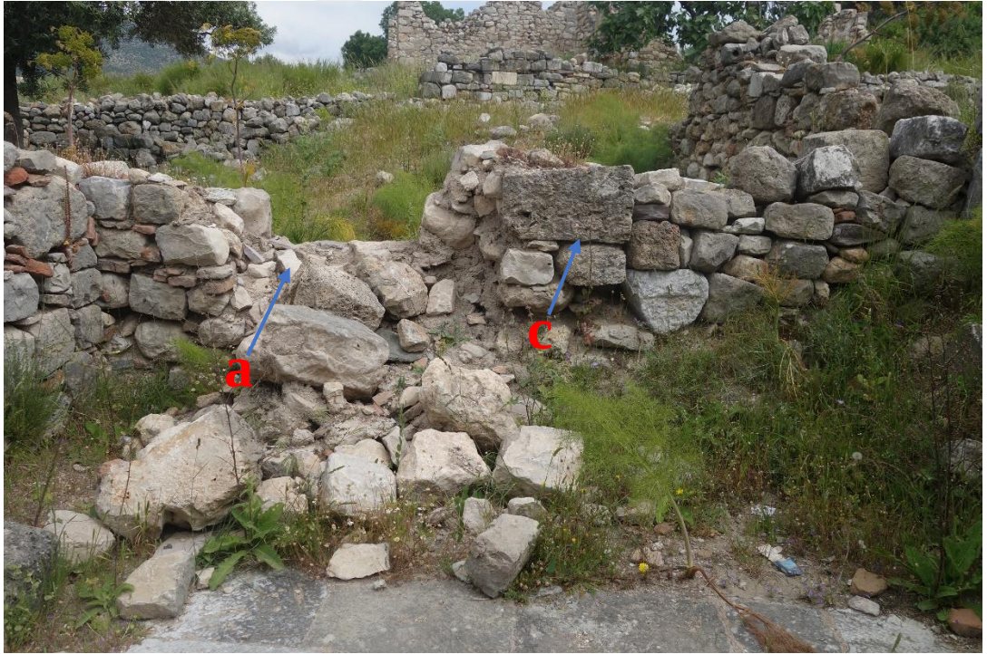
Resim 529 Soyunmalık Bölümü Güney Duvar (1 Nolu) a. Malzeme Kaybı c. Petek Gözlülük
