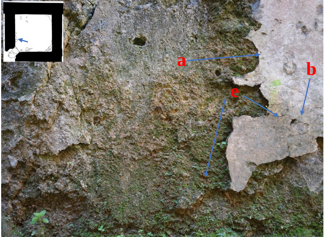
Resim 139 Batı Halvet Odası Sıva Malzeme (7 Nolu) a. Malzeme Kaybı b. Çatlak e. Biyolojik Oluşum ve Köklü Bitkiler
