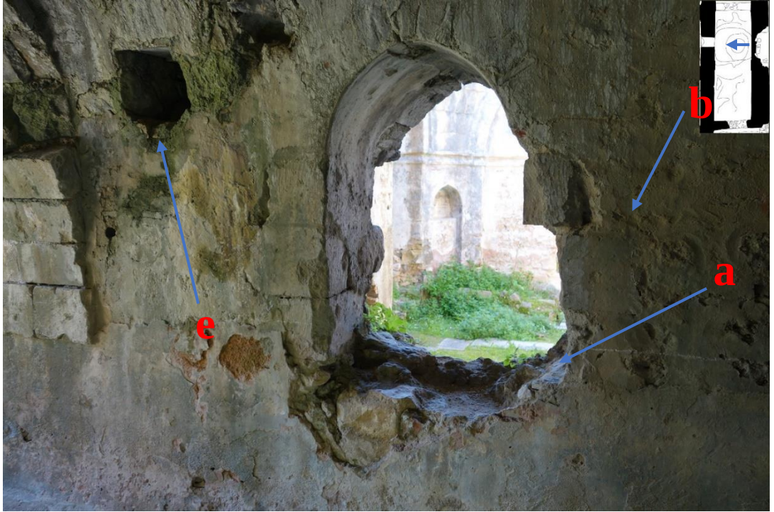
Resim 166 Su Deposu (1) Güney Duvarı (9 Nolu) a. Malzeme Kaybı d. Çatlak e. Biyolojik Oluşumlar
