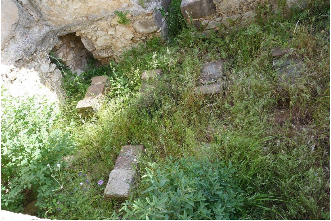
Resim 309 Sıcaklık Bölümü Zemin (5 Nolu) a. Malzeme Kaybı e. Köklü Bitkiler
