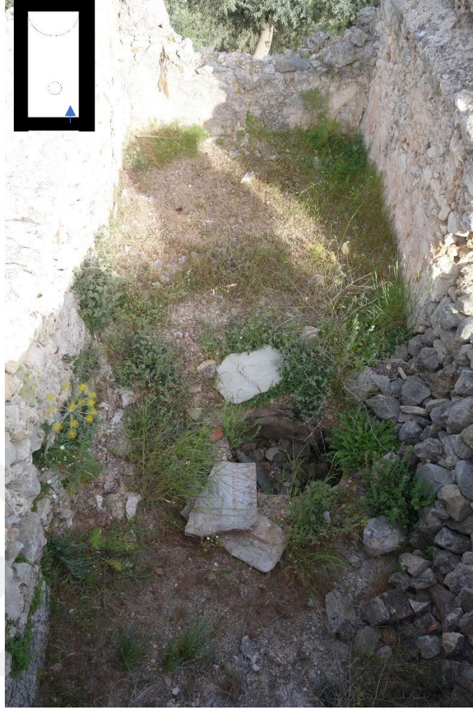
Resim 336 Su Deposu Bölümü (8 Nolu) a. Malzeme Kaybı e. Köklü Bitkiler
