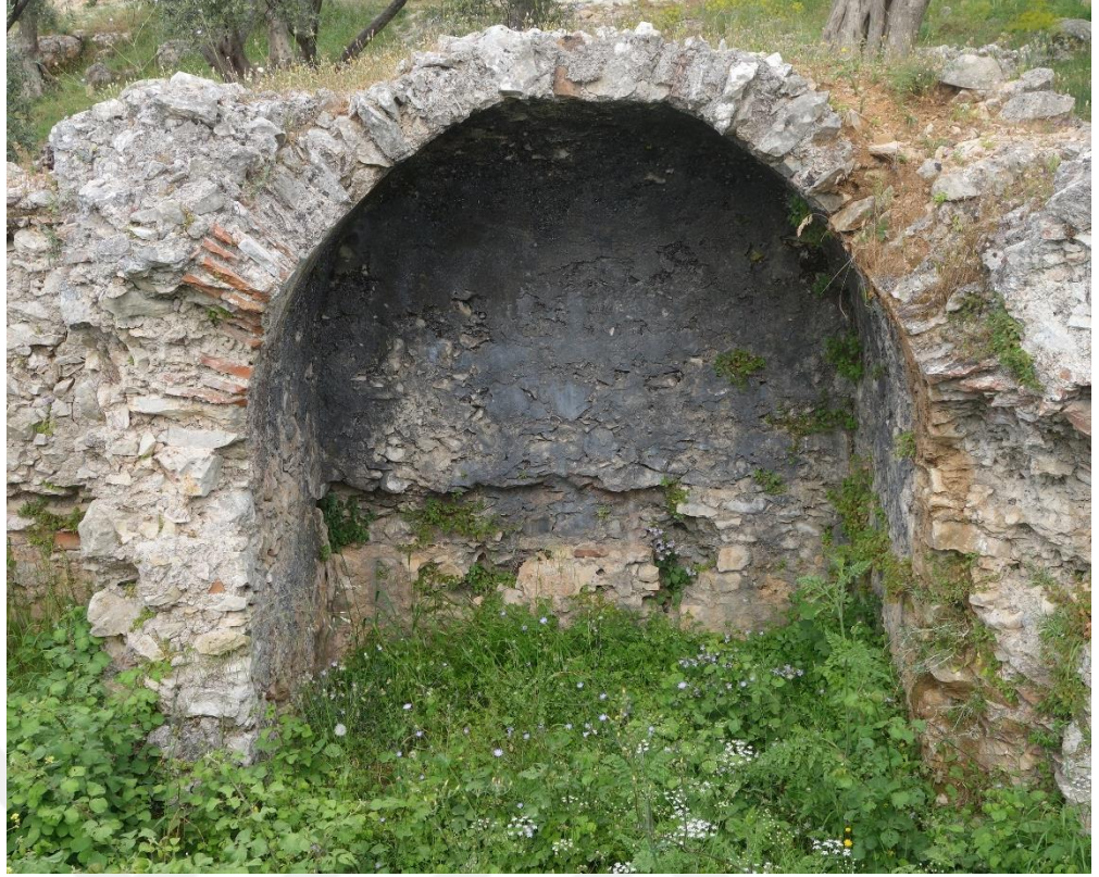
Resim 432 Sıcaklık Bölümü Doğu Eyvanı (6 Nolu) a. Malzeme Kaybı d. Renk Değişimi e. Biyolojik Oluşum ve Köklü Bitkiler
