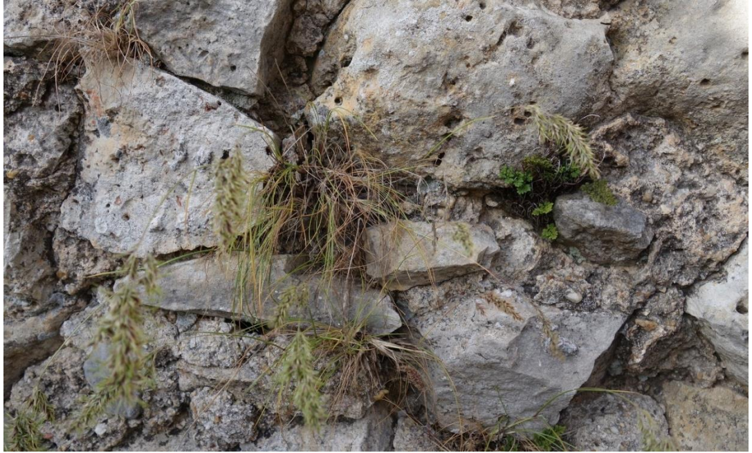
Resim 303 Traşlık Bölümü Kuzey Duvar (4 Nolu) c. Petek Gözlülük e. Biyolojik Oluşum ve Köklü Bitkiler
