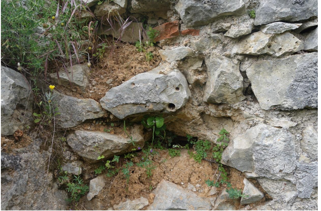
Resim 449 Sıcaklık Bölümü Kuzey Eyvanı (6 Nolu) a. Malzeme Kaybı
