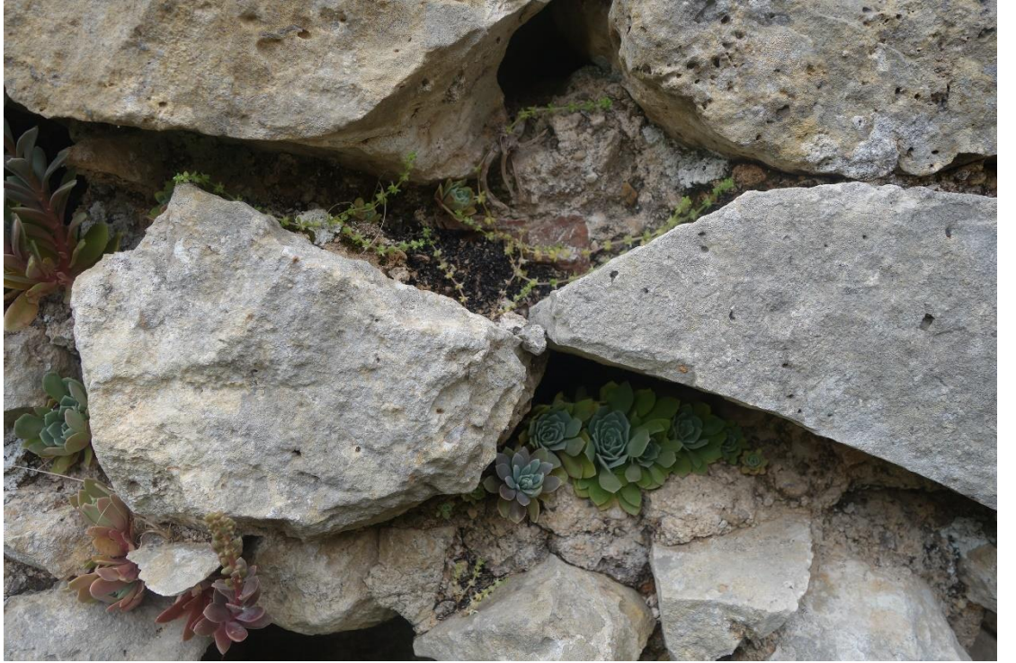
Resim 487 Batı Halvet Kuzey Duvarı (8 Nolu) e. Köklü Bitkiler
