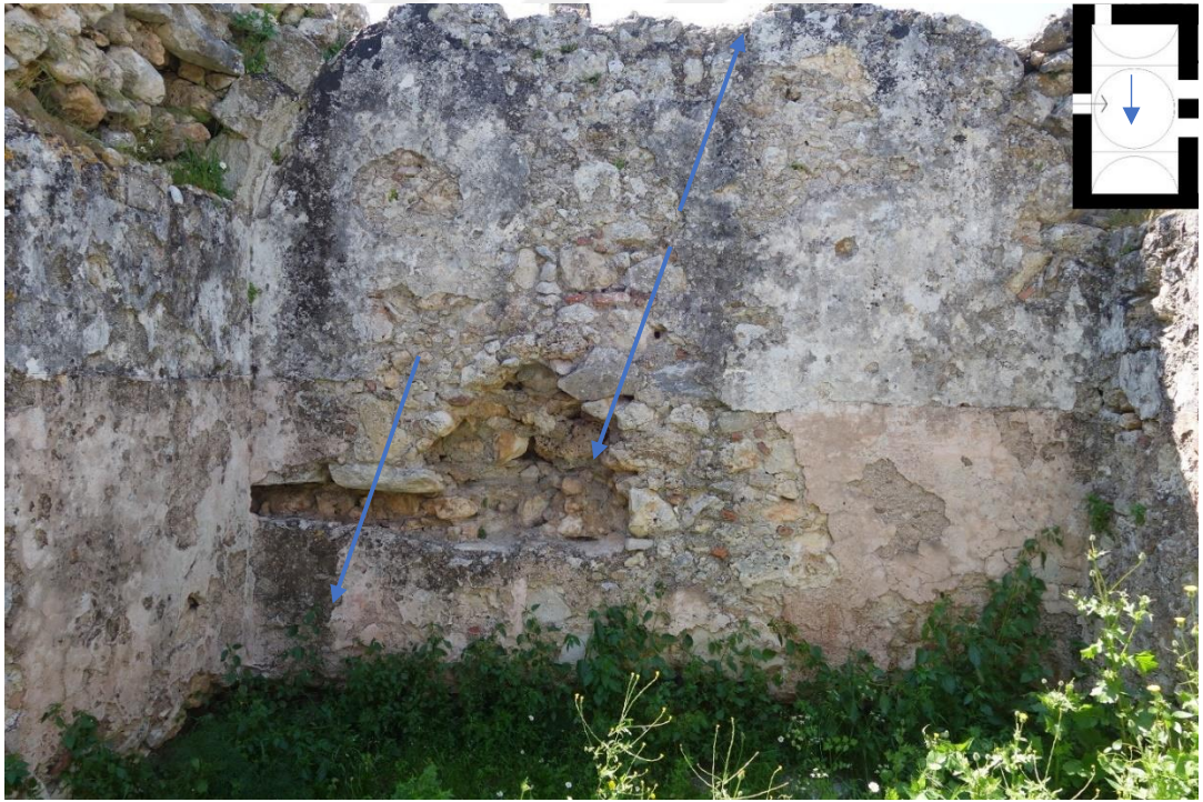
Resim 212 Sıcaklık Bölümü Güney Duvarı (2 Nolu) a. Malzeme kaybı d. Renk Değişimi
