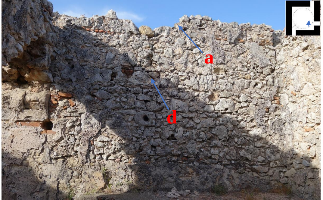
Resim 291 Ilıklık Bölümü Kuzey Duvarı (3 Nolu) a. Malzeme Kaybı c. Petek Gözlülük
