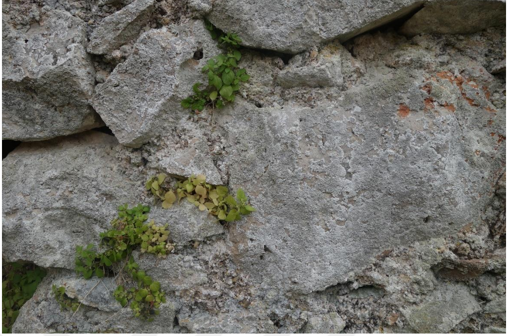
Resim 384 Soyunmalık Bölümü Güney Duvar (1 Nolu) e. Biyolojik Oluşumlar ve Köklü Bitkiler
