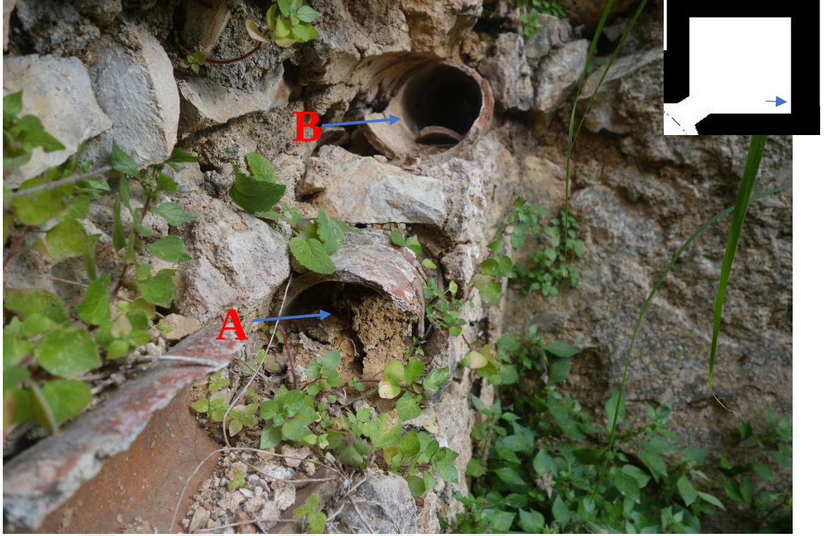
Resim 476 Doğu Halvet Bölümü Doğu Duvarı Su Hattı (7 Nolu) A. Eski Su Hattı B. Sonradan Yapılan Su Hattı
