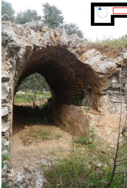
Resim 507 Su Deposu Bölümü (1) Geçiş Ögesi ve Üst Örtü (9 Nolu) a. Malzeme Kaybı
