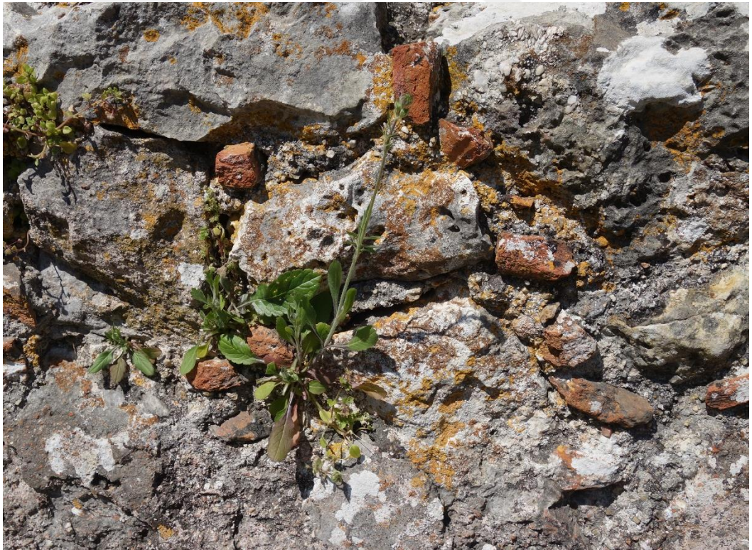
Resim 259 Su Deposu Doğu Duvarı Harç Malzeme (5 Nolu) a. Malzeme Kaybı d. Renk Değişimi e. Biyolojik Oluşumlar ve Köklü Bitkiler
