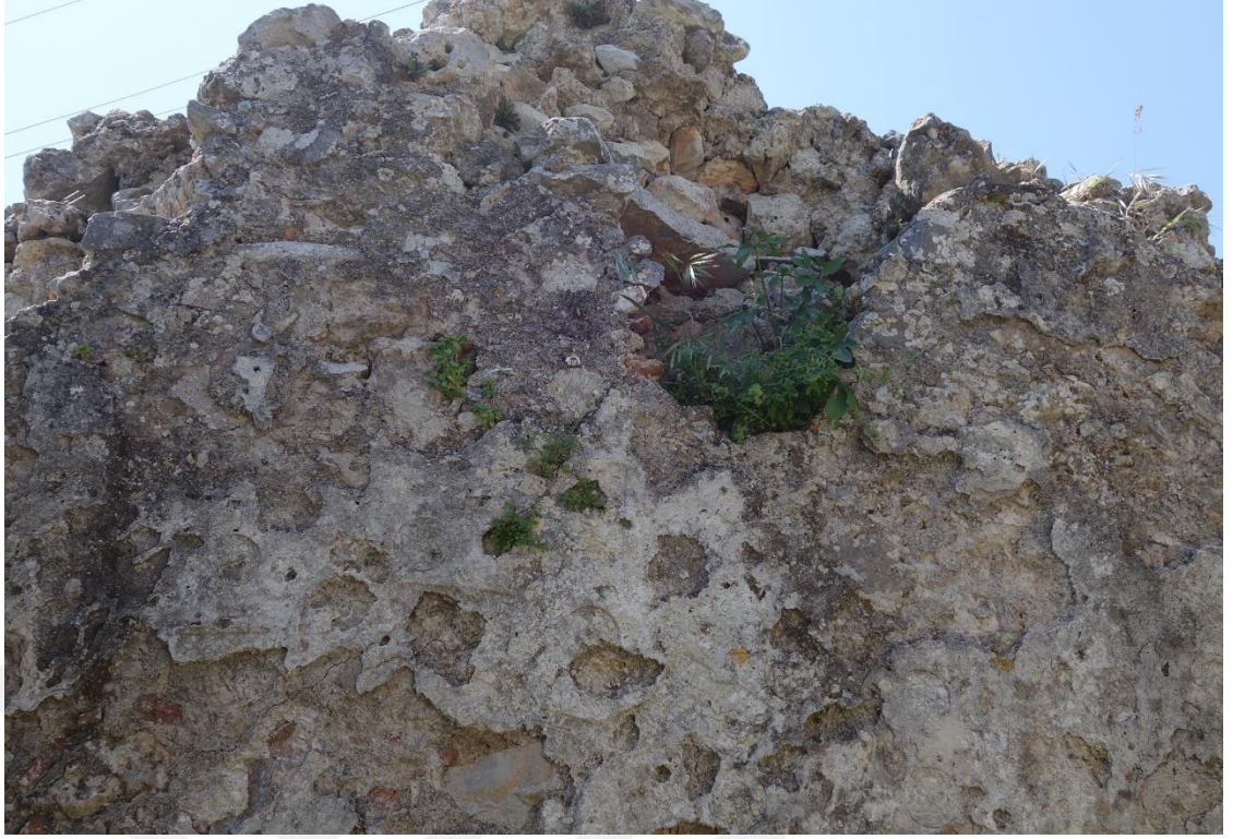
Resim 244 Güney Halvet Odası Güney Duvarı (4 Nolu) a. Malzeme Kaybı d. Renk Değişimi e. Köklü Bitkiler
