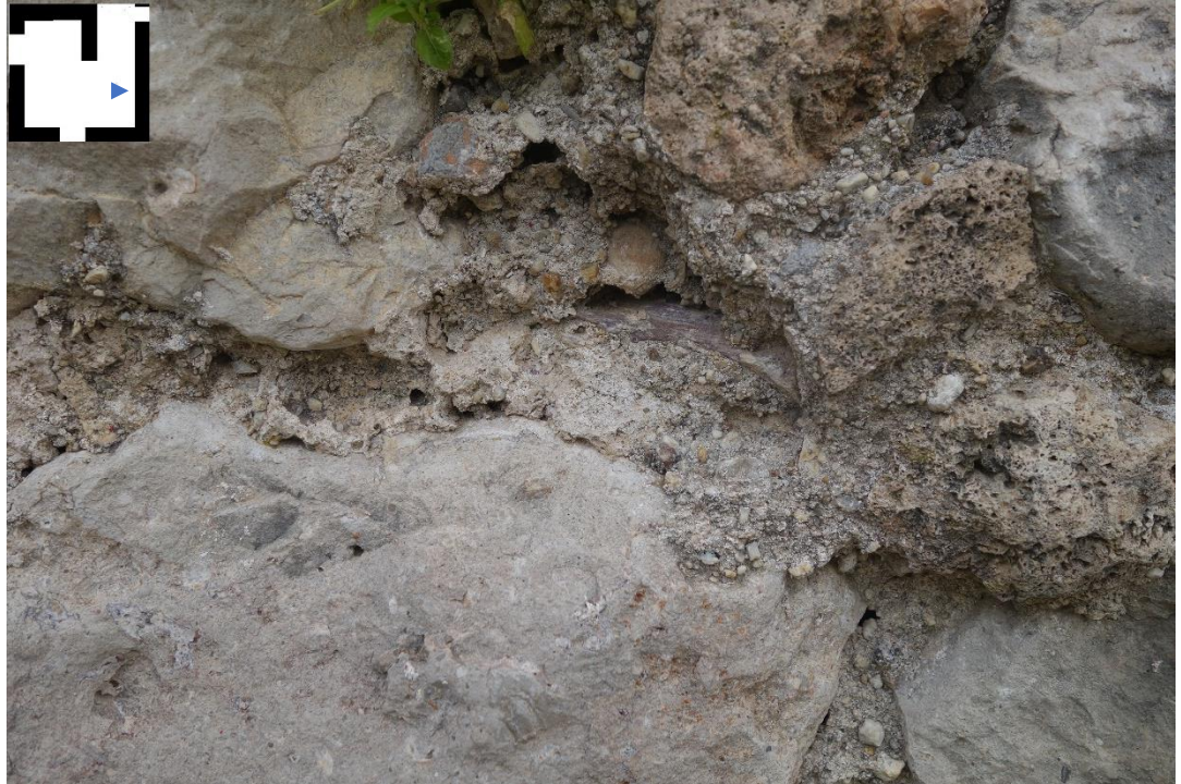
Resim 533 Soyunmalık Bölümü Kuzey Duvar Harç Malzeme (1 Nolu) a. Malzeme Kaybı d. Renk Değişimi
