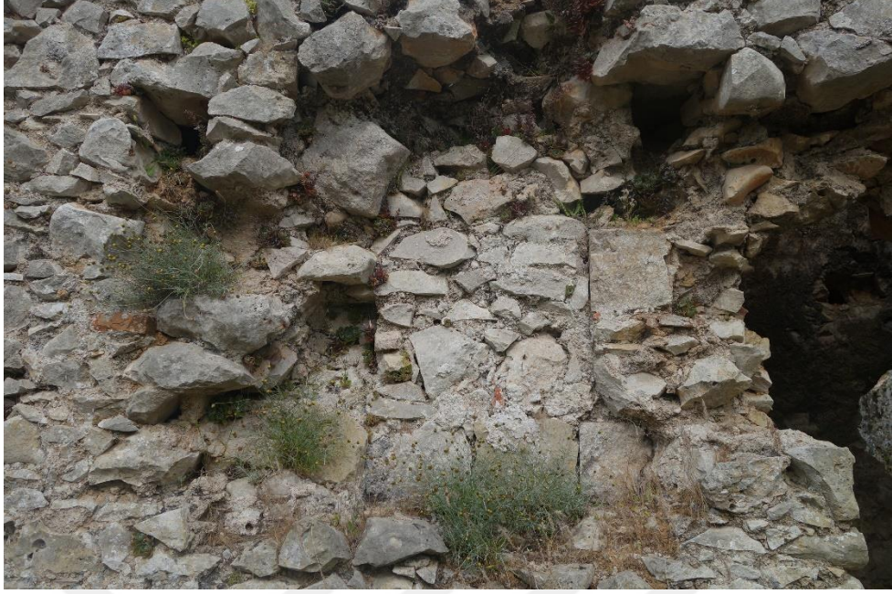
Resim 372 Soyunmalık Bölümü Doğu Duvar (1 Nolu) a. Malzeme Kaybı
