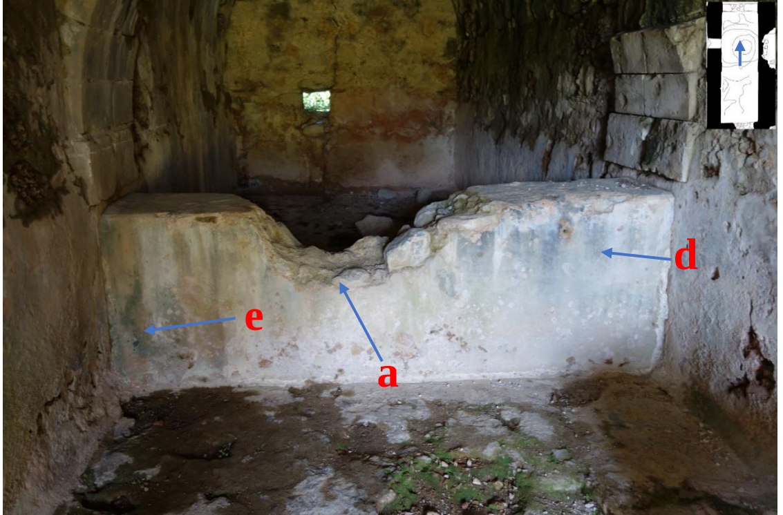
Resim 164 Su Deposu (1) Zemin (9 Nolu) a. Malzeme Kaybı d. Renk Değişimi e. Biyolojik Oluşumlar
