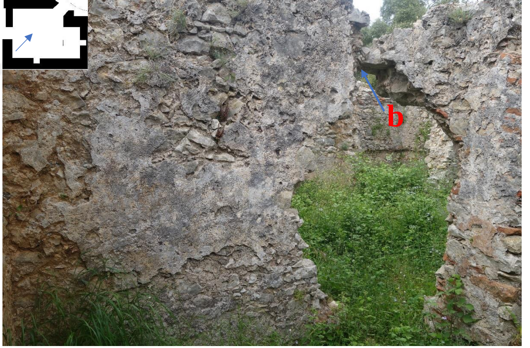
Resim 419 Ihlık Bölümü Kuzey Duvarı (4 Nolu) a. Malzeme Kaybı b. Yarık d. Renk Değişimi e. Biyolojik Oluşumlar ve Köklü Bitkiler
