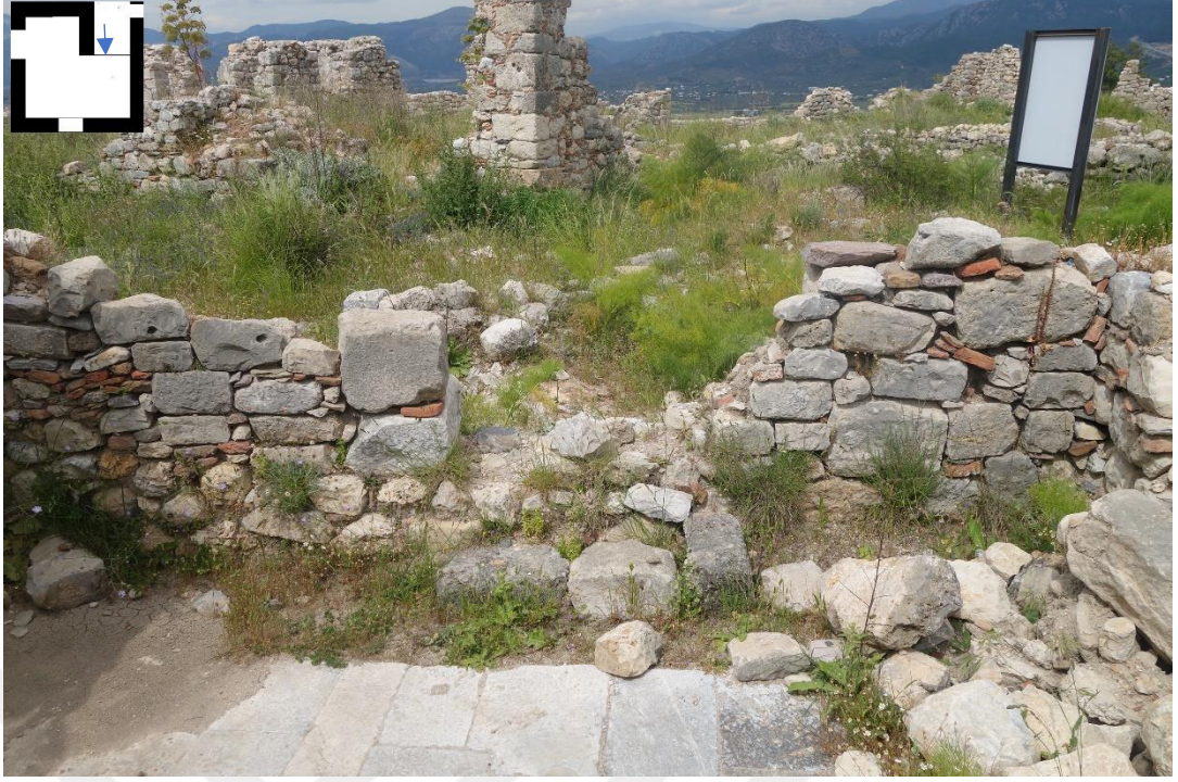
Resim 522 Soyunmalık Bölümü Doğu Duvar (1 Nolu) a. Malzeme Kaybı e. Köklü Bitkiler
