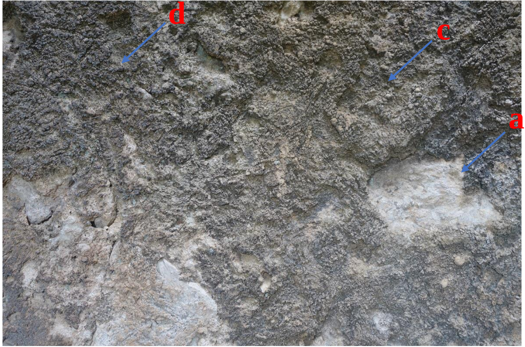
Resim 395 Aralık Bölümü Batı Duvarı Sıva Malzeme (2 Nolu) a. Malzeme Kaybı c. Petek Gözlülük d. Renk Değişimi
