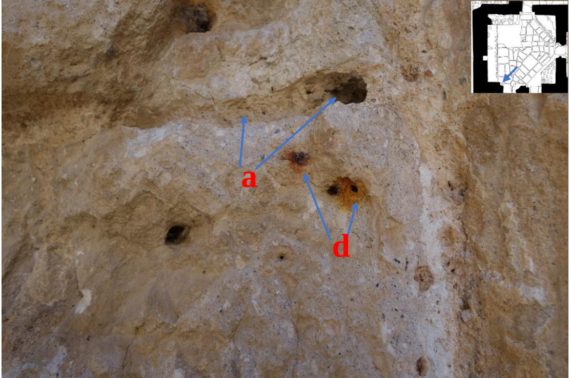
Resim 83 Ilıklık Bölümü Harç Malzeme (4 Nolu) a. Malzeme Kaybı d. Renk Değişimi
