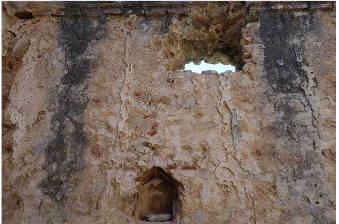
Resim 79 Ilıklık Bölümü Güney Duvarı (4 Nolu) a. Malzeme Kaybı d. Renk Değişimi
