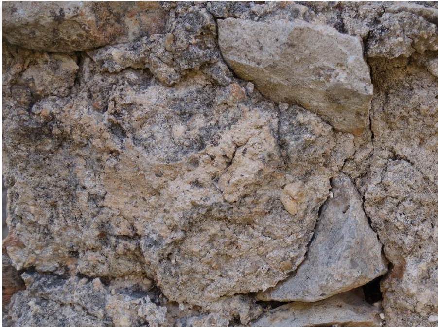
Resim 329 Doğu Halvet Bölümü Güney Duvar Harç Malzeme (6 Nolu) a. Malzeme Kaybı c. Çatlak d. Renk Değişimi
