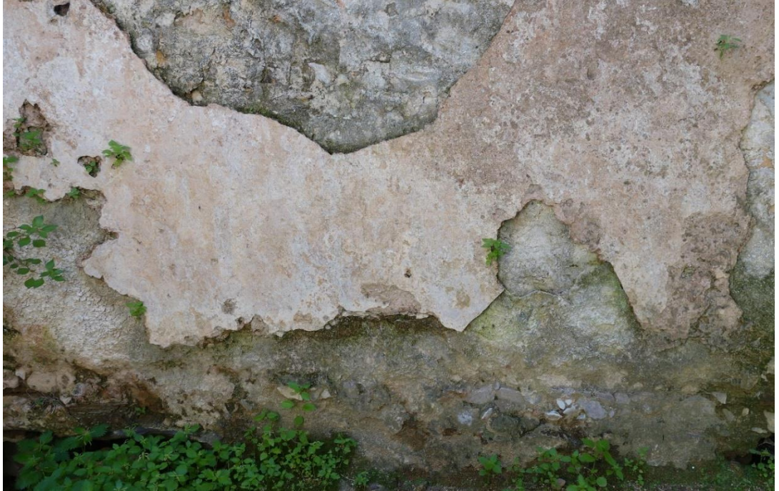
Resim 129 Batı Halvet Odası Doğu Duvarı (7 Nolu) a. Malzeme Kaybı d. Renk Değişimi e. Biyolojik Oluşum ve Köklü Bitkiler
