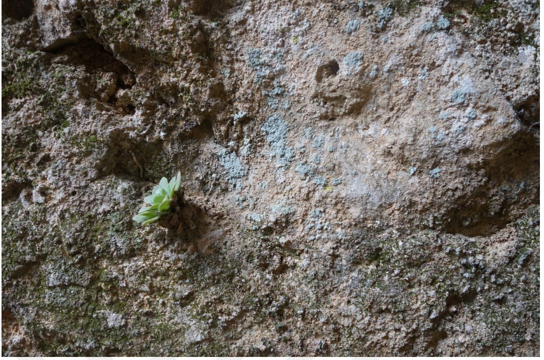
Resim 398 Tıraşlık Bölümü Doğu Duvar (3 Nolu) a. Malzeme Kaybı e. Biyolojik Oluşum
