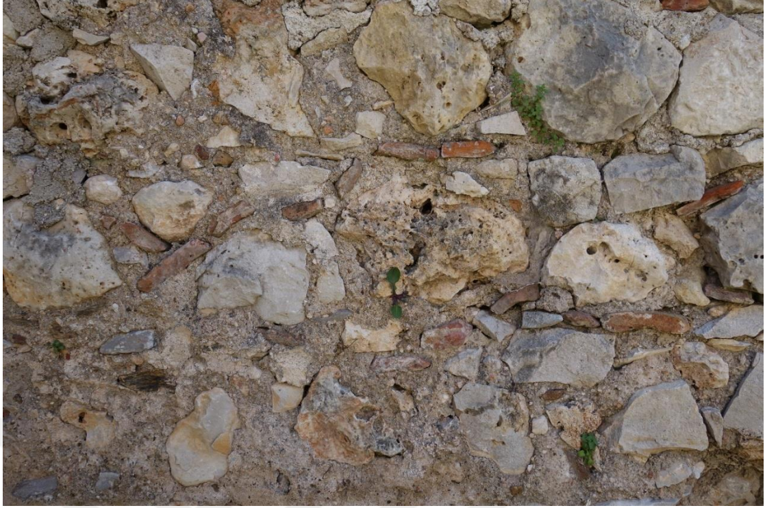
Resim 16 Soyunmalık Bölümü Doğu Duvarı (1 Nolu) c. Petek Gözlülük e. Köklü Bitkiler
