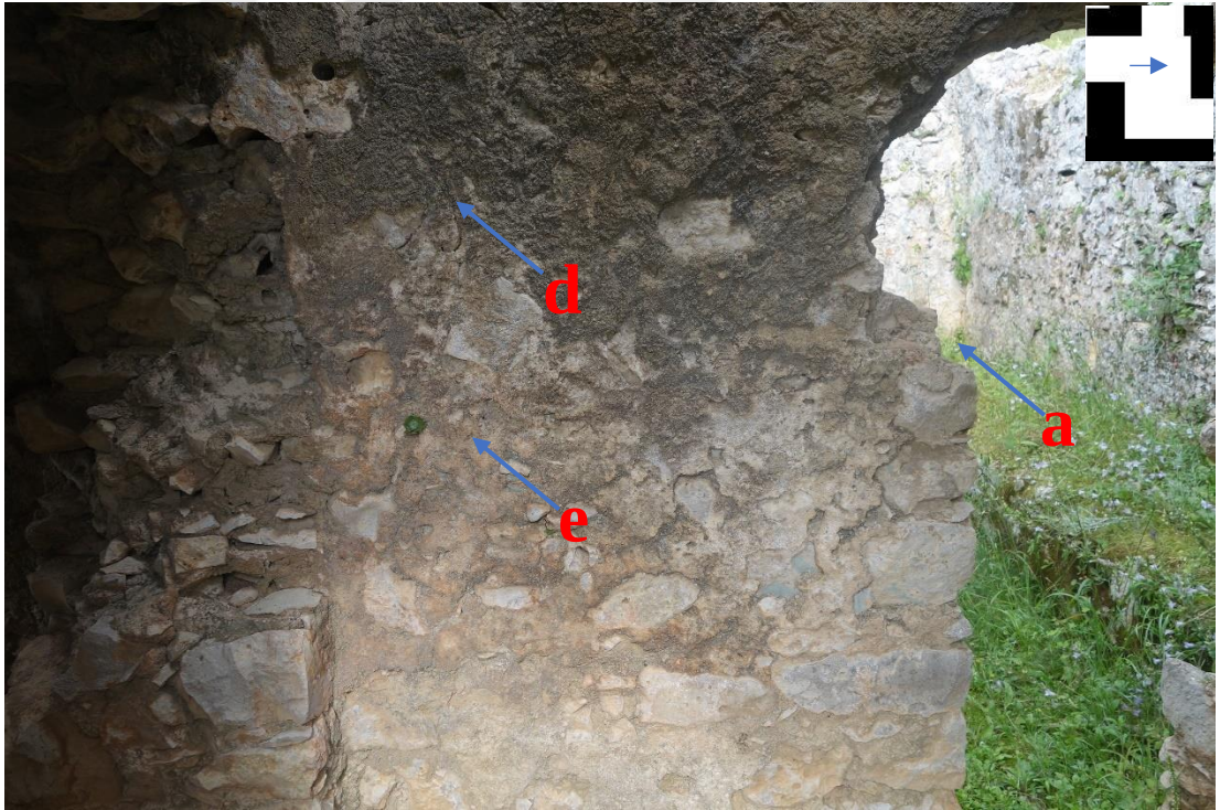
Resim 387 Aralık Bölümü Doğu Duvarı (2 Nolu) a. Malzeme Kaybı d. Renk Değişimi e. Köklü Bitkiler
