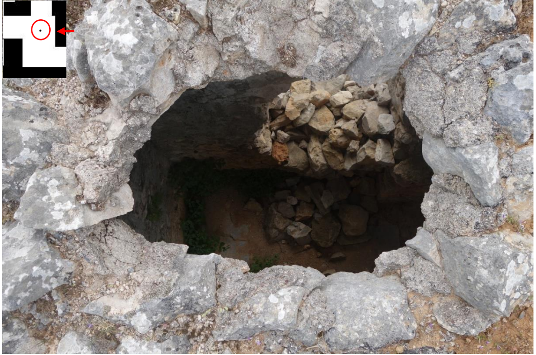
Resim 393 Aralık Bölümü Üst Örtü (2 Nolu) a. Malzeme Kaybı e. Biyolojik Oluşum
