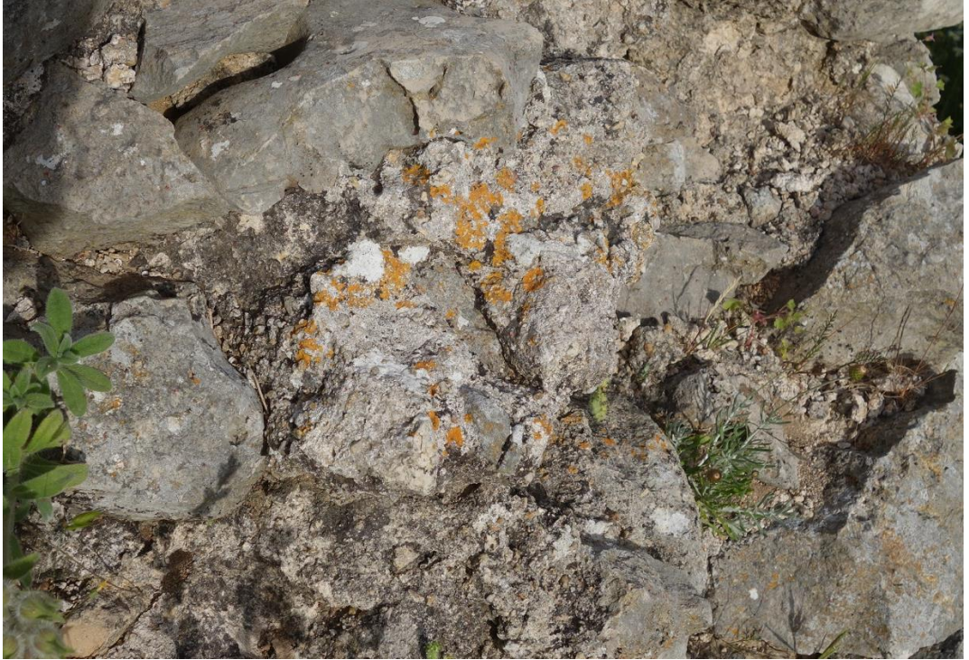
Resim 341 Su Deposu Bölümü Kuzey Duvar Harç Malzeme (8 Nolu) e. Biyolojik Oluşumlar
