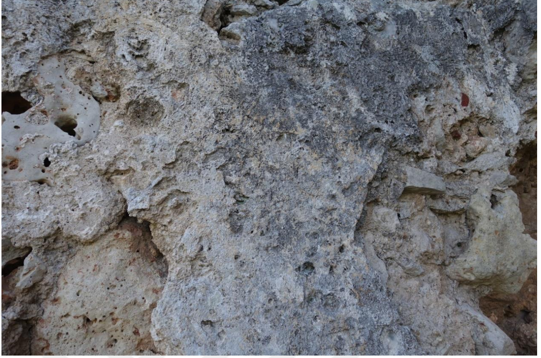
Resim 282 Aralık Bölümü Batı Duvarı (2 Nolu) c. Petek Gözlülük d. Renk Değişimi
