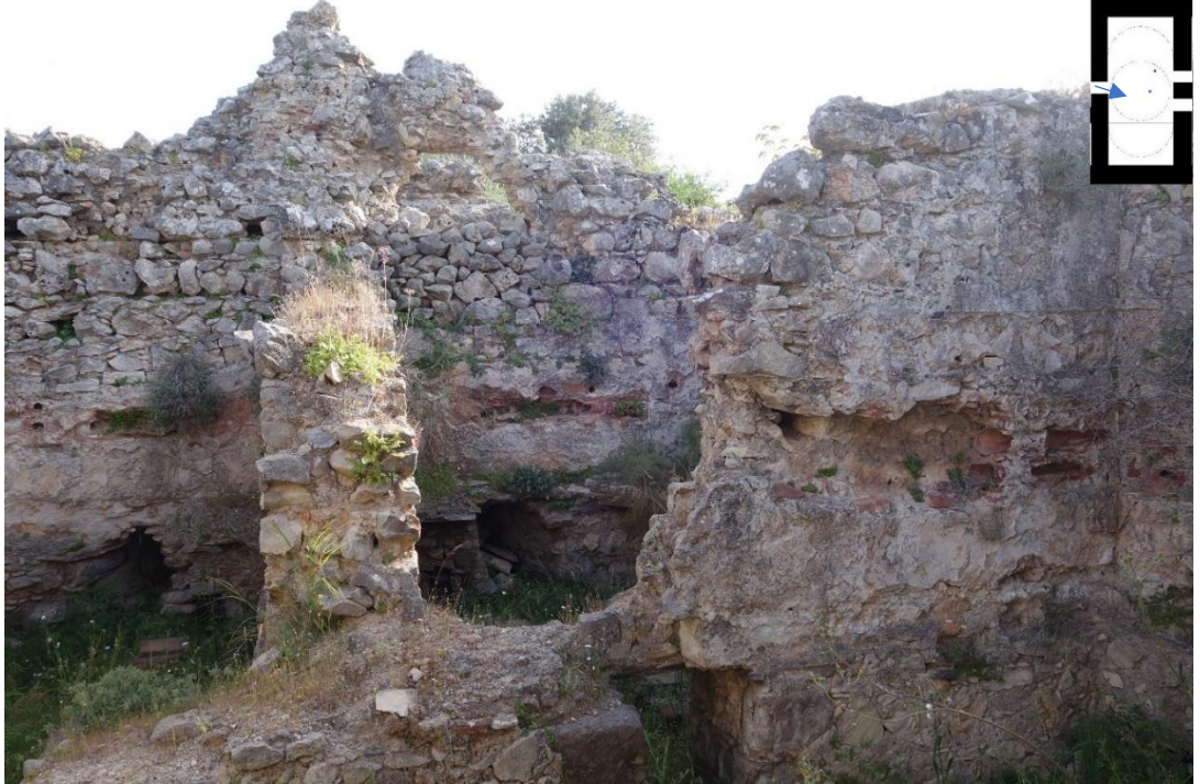
Resim 317 Sıcaklık Bölümü Güney Duvarı (5 Nolu) a. Malzeme Kaybı e. Köklü Bitkiler
