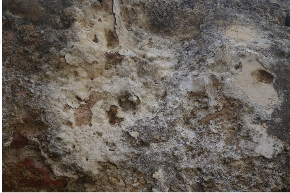
Resim 539 Aralık Bölümü Kuzey Duvarı (2 Nolu) d. Renk Değişimi f. Kabuklanma
