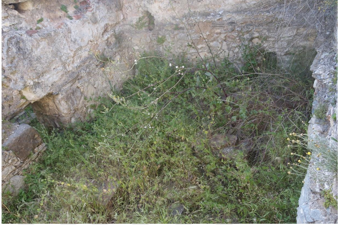
Resim 310 Sıcaklık Bölümü Zemin (5 Nolu) a. Malzeme Kaybı e. Köklü Bitkiler
