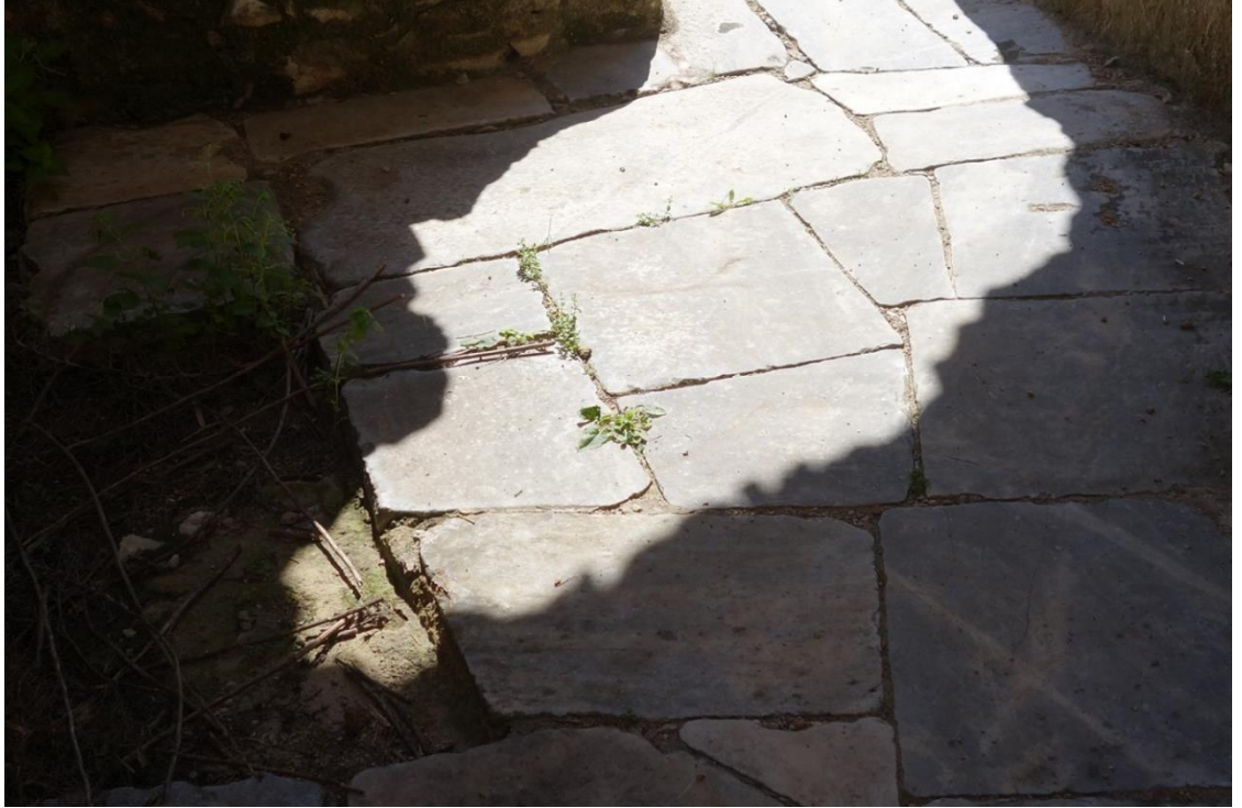
Resim 31 Aralık Bölümü Zemin (2 Nolu) a. Malzeme Kaybı b. Çatlak e. Köklü Bitkiler
