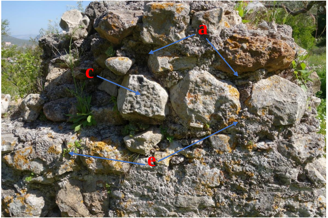
Resim 176 Külhan Bölümü ve Odunluk Kuzey Duvarı Harç ve Sıva (11 Nolu) a. Malzeme Kaybı b. Petek Gözlülük e. Biyolojik Oluşumlar ve Köklü Bitkiler
