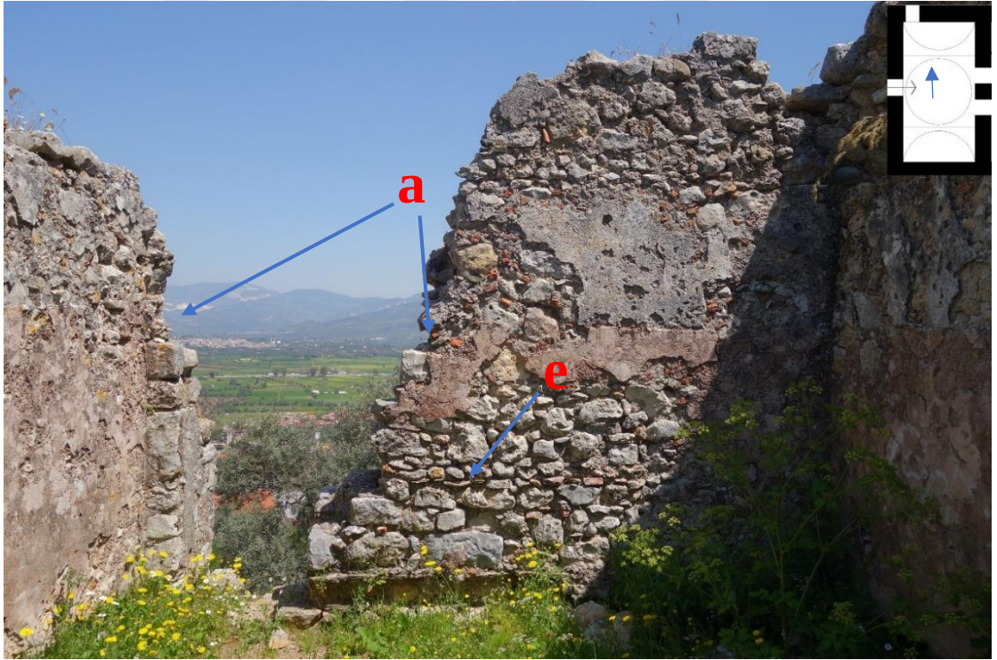
Resim 210 Sıcaklık Bölümü Kuzey Duvarı (2 Nolu) a. Malzeme Kaybı e. Biyolojik Oluşum
