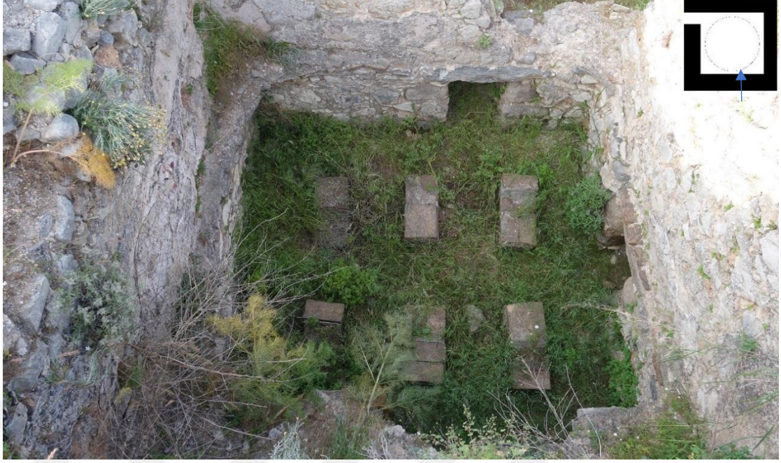
Resim 330 Batı Halvet Bölümü Zemin (7 Nolu) a. Malzeme Kaybı e. Köklü Bitkiler
