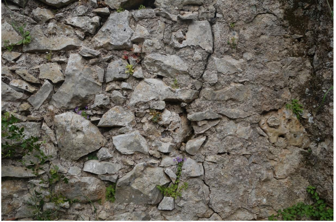
Resim 464 Doğu Halvet Bölümü Doğu Duvarı (7 Nolu) b. Yarık c. Petek Gözlülük e. Köklü Bitkiler
