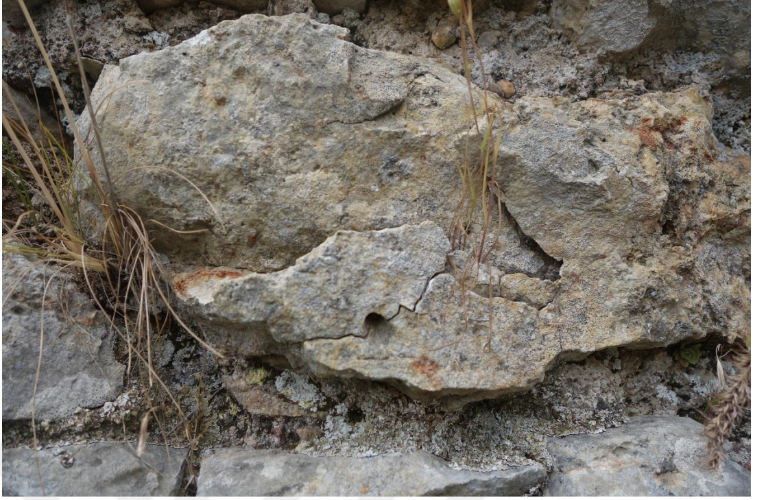
Resim 486 Batı Halvet Kuzey Duvarı (8 Nolu) b. Çatlak
