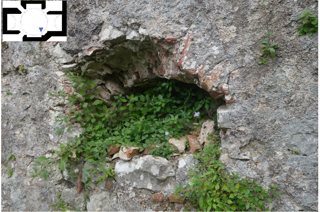
Resim 457 Sıcaklık Bölümü Güney Eyvanı (6 Nolu) a. Malzeme Kaybı b. Çatlak e. Köklü Bitkiler
