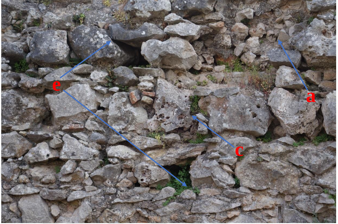
Resim 328 Doğu Halvet Bölümü Güney Duvar (6 Nolu) a. Malzeme Kaybı c. Petek Gözlülük e. Biyolojik Oluşumlar ve Köklü Bitkiler
