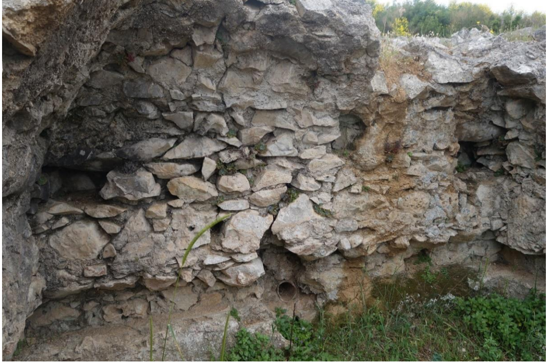
Resim 505 Su Deposu Bölümü (1) Güney Duvarı (9 Nolu) a. Malzeme Kaybı d. Renk Değişimi e. Biyolojik Oluşumlar ve Köklü Bitkiler
