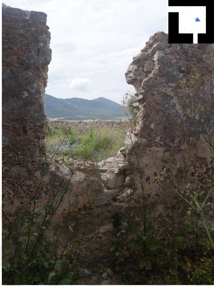
Resim 552 Sıcaklık Bölümü Kuzey Duvarı (3 Nolu) a. Malzeme Kaybı
