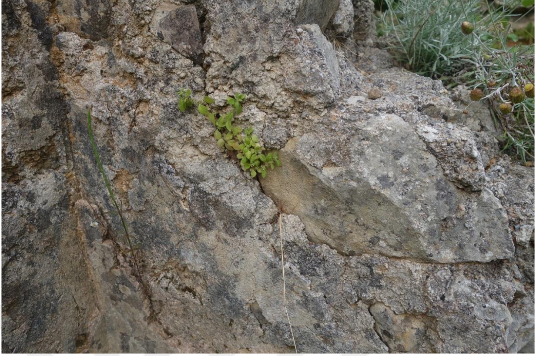
Resim 452 Sıcaklık Bölümü Kuzey Eyvanı (6 Nolu) a. Malzeme Kaybı d. Renk Değişimi e. Biyolojik Oluşumlar ve Köklü Bitkiler
