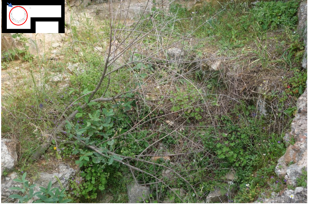
Resim 510 Su Deposu Bölümü (1) Kazan Bölümü (9 Nolu) a. Malzeme Kaybı e. Köklü Bitkiler
