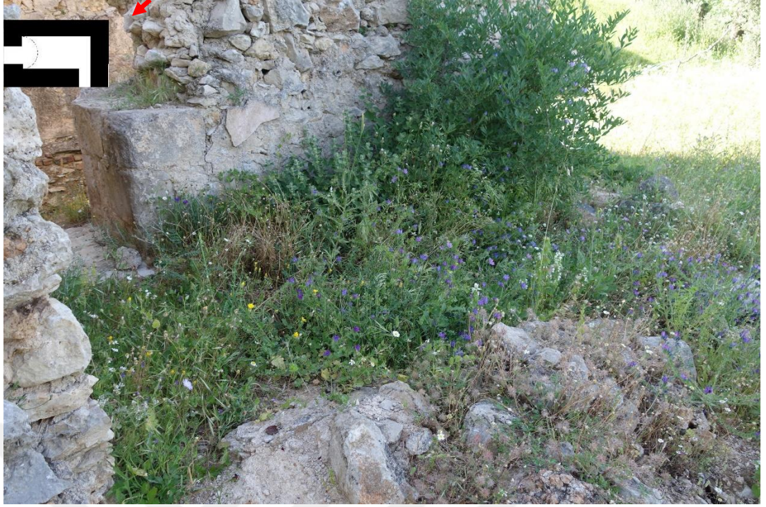
Resim 276 Aralık Bölümü Zemin (2 Nolu) a. Malzeme Kaybı e. Köklü Bitkiler
