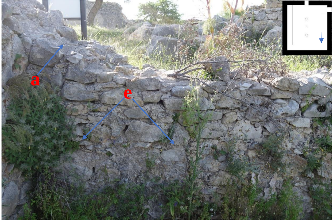
Resim 268 Soyunmalık Bölümü Batı Duvarı (1 Nolu) a. Malzeme Kaybı e. Köklü Bitkiler
