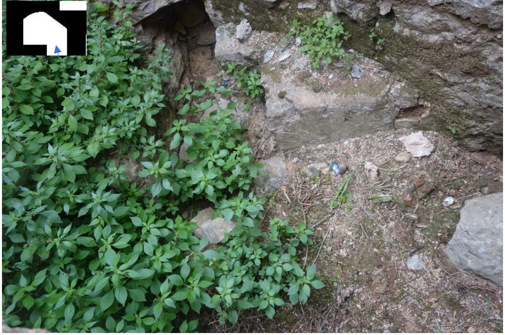
Resim 405 Hela Bölümü Zemin (3 Nolu) a. Malzeme Kaybı e. Biyolojik Oluşumlar ve Köklü Bitkiler
