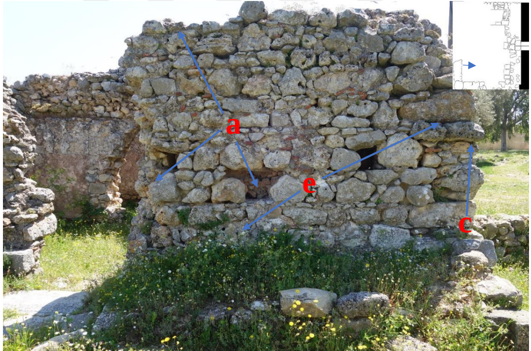
Resim 196 Soyunmalık Bölümü Doğu Duvarı (1 Nolu) a. Malzeme Kaybı c. Petek Gözlülük e. Biyolojik Oluşumlar ve Köklü Bitkiler
