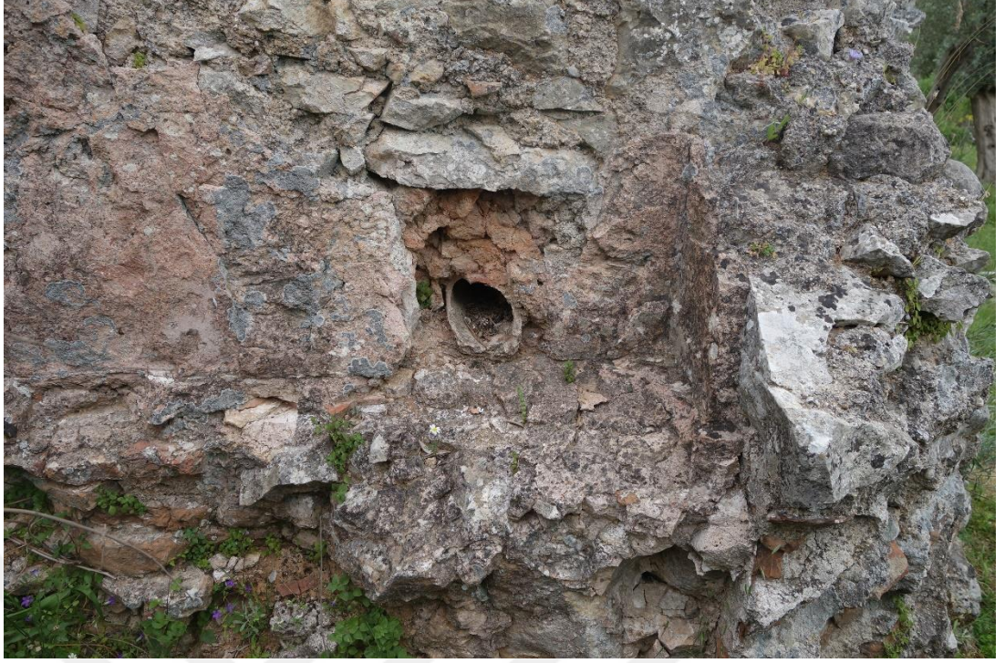
Resim 504 Su Deposu Bölümü (1) Batı Duvarı (9 Nolu) a. Malzeme Kaybı e. Biyolojik Oluşumlar ve Köklü Bitkiler
