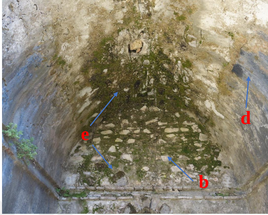
Resim 116 Sıcaklık Bölümü Kuzey Eyvan (6 Nolu) b. Çatlak d. Renk Değişimi e. Biyolojik Oluşumlar
