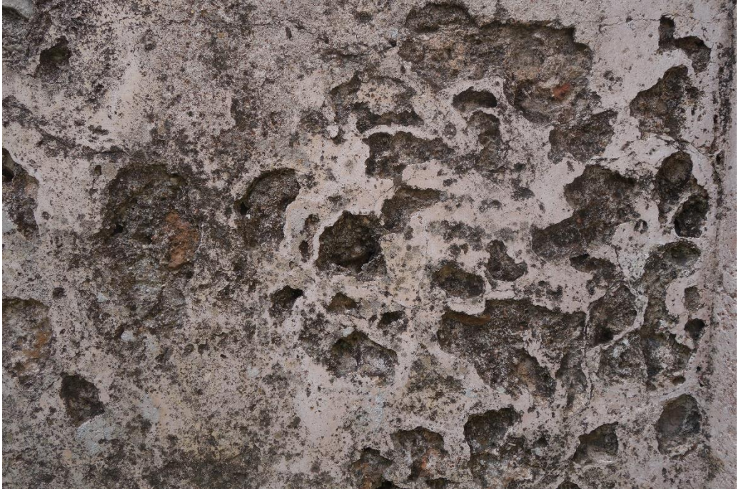
Resim 553 Sıcaklık Bölümü Kuzey Duvarı (3 Nolu) a. Malzeme Kaybı d. Renk Değişimi
