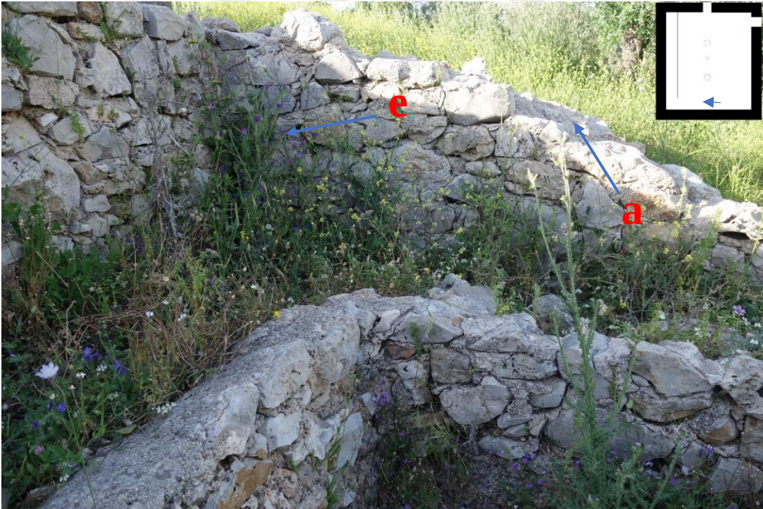
Resim 271 Soyunmalık Bölümü Kuzey Duvarı (1 Nolu) a. Malzeme Kaybı e. Köklü Bitkiler
