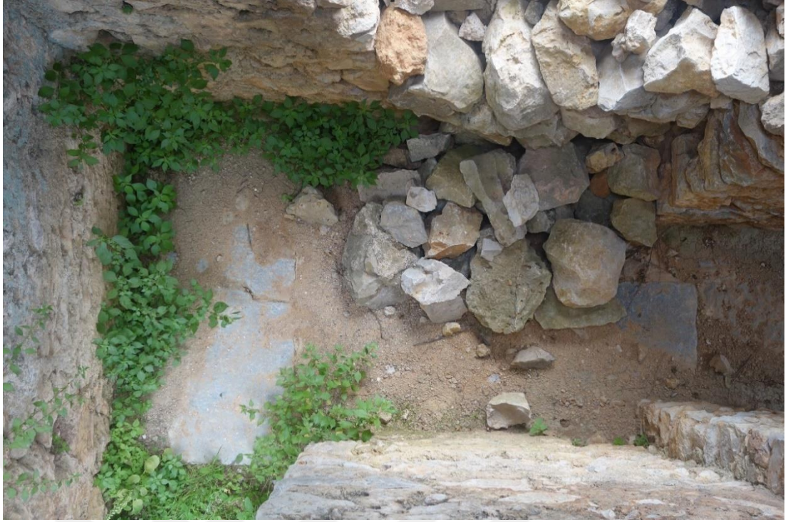
Resim 386 Aralık Bölümü Zemin (2 Nolu) a. Malzeme Kaybı e. Köklü Bitkiler
