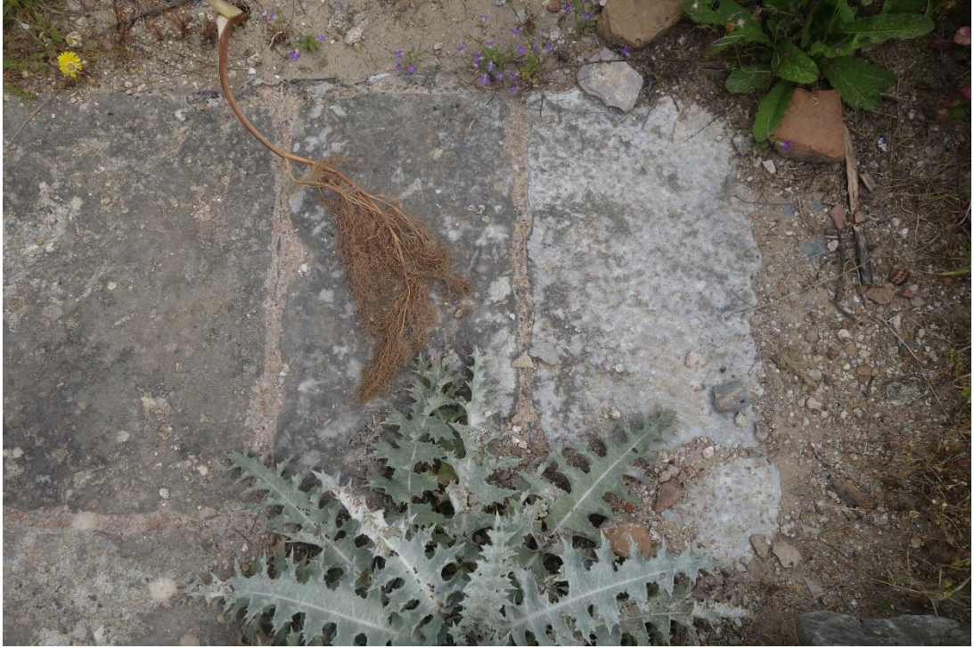
Resim 521 Soyunmalık Bölümü Zemin (1 Nolu) b. Çatlak d. Renk Değişimi e. Köklü Bitkiler
