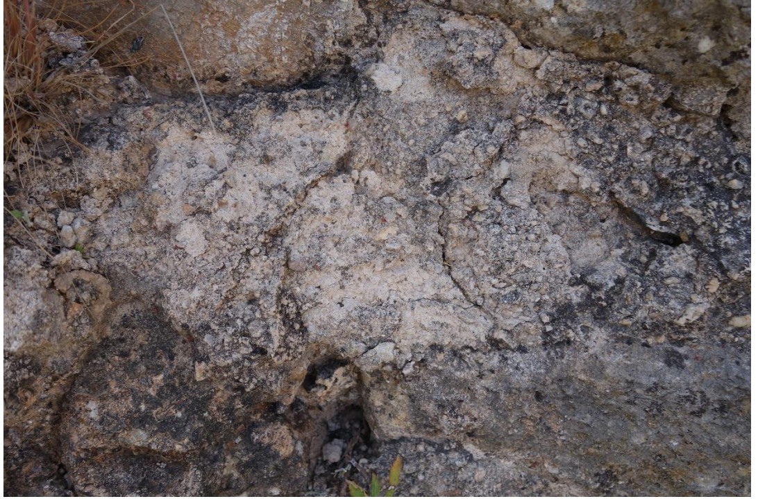
Resim 335 Batı Halvet Bölümü Kuzey Duvar Harç Malzeme (7 Nolu) a. Malzeme Kaybı b. Çatlak d. Renk Değişimi e. Köklü Bitkiler
