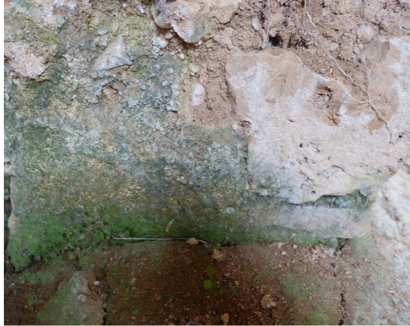
Resim 403 Tıraşlık Bölümü Güney Duvar (3 Nolu) e. Biyolojik Oluşumlar
