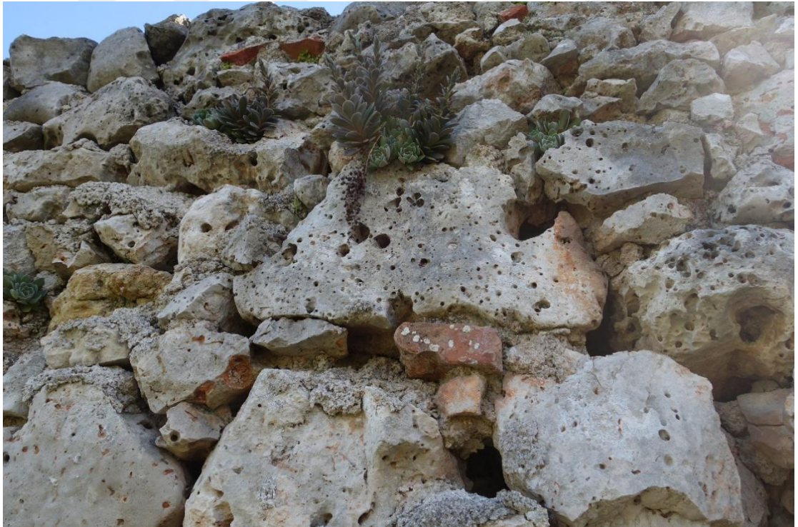
Resim :273 Soyunmalık Bölümü Doğu Duvarı (1 Nolu) c. Petek Gözlülük e. Köklü Bitkiler
