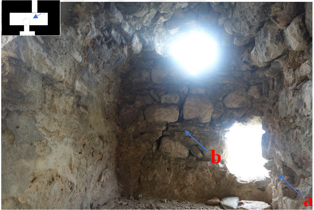
Resim 567 Su Deposu Kuzey Duvar (4 Nolu) a. Malzeme Kaybı b. Çatlak
