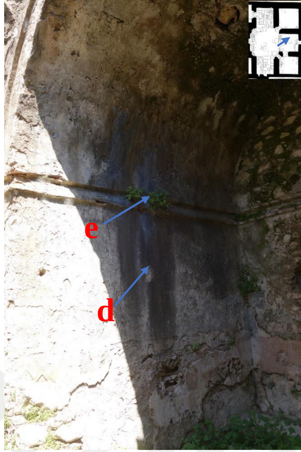
Resim 120 Sıcaklık Bölümü Kuzey Eyvan (6 Nolu) d. Renk Değişimi e. Köklü Bitki
