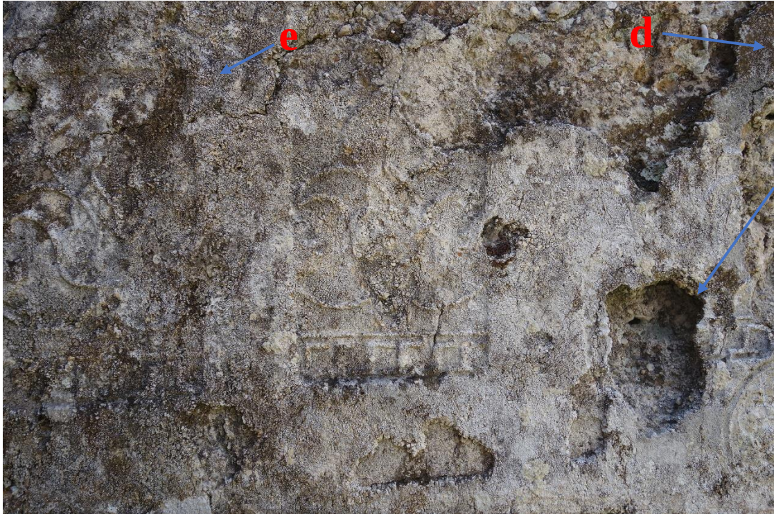
Resim 249 Güney Halvet Odası Güney Duvar Sıva Malzeme (4 Nolu) a. Malzeme Kaybı d. Renk Değişimi e. Biyolojik Oluşum
