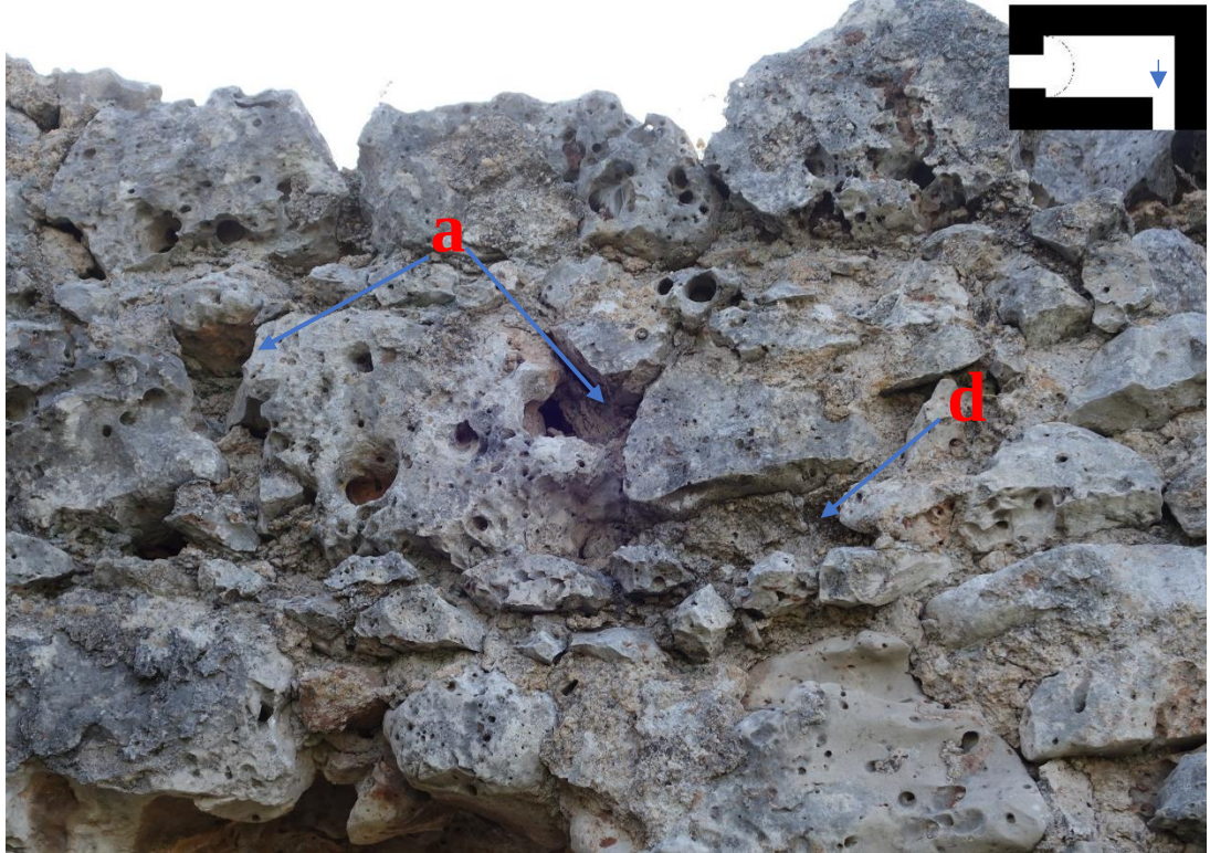
Resim 283 Aralık Bölümü Güney Duvarı Harç Malzeme (2 Nolu) a. Malzeme Kaybı d. Renk Değişimi
