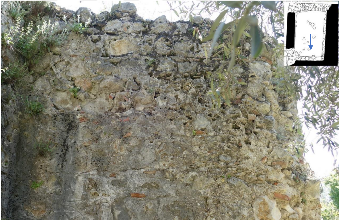
Resim 184 Ek Mekân Doğu Duvarı (12 Nolu) a. Malzeme Kaybı e. Biyolojik Oluşumlar ve Köklü Bitkiler
