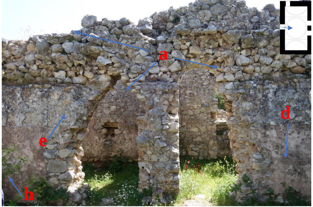
Resim 205 Sıcaklık Bölümü Doğu Duvarı (2 Nolu) a. Malzeme Kaybı d. Renk Değişimi Biyolojik Oluşum ve Köklü Bitkiler h. Vandalizm
