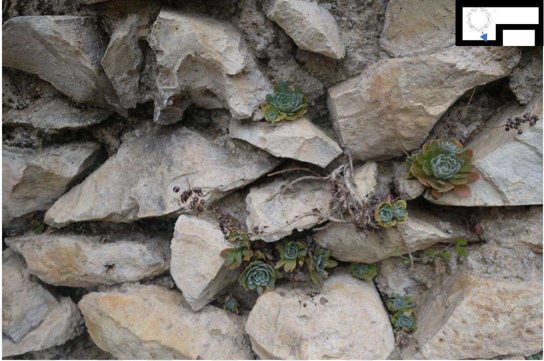
Resim 508 Su Deposu Bölümü (1) Güney Duvar Harç Malzeme (9 Nolu) a. Malzeme Kaybı d. Renk Değişimi e. Köklü Bitkiler
