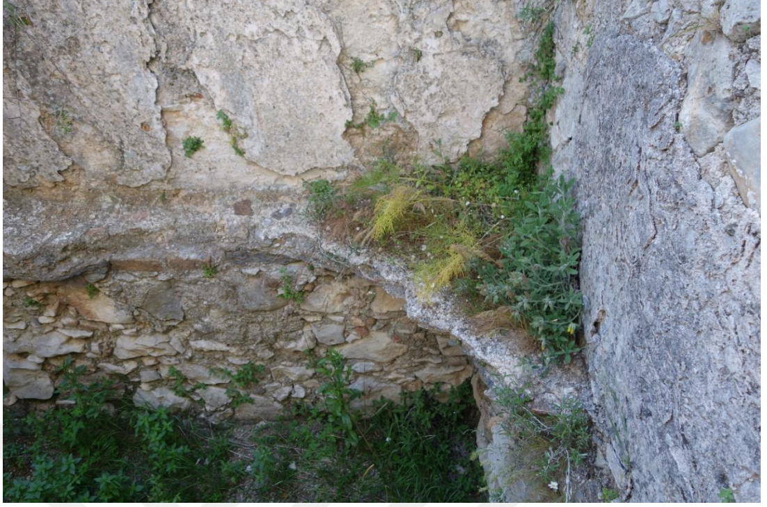
Resim 298 Traşlık Bölümü Zemin (4 Nolu) a. Malzeme Kaybı e. Köklü Bitkiler
