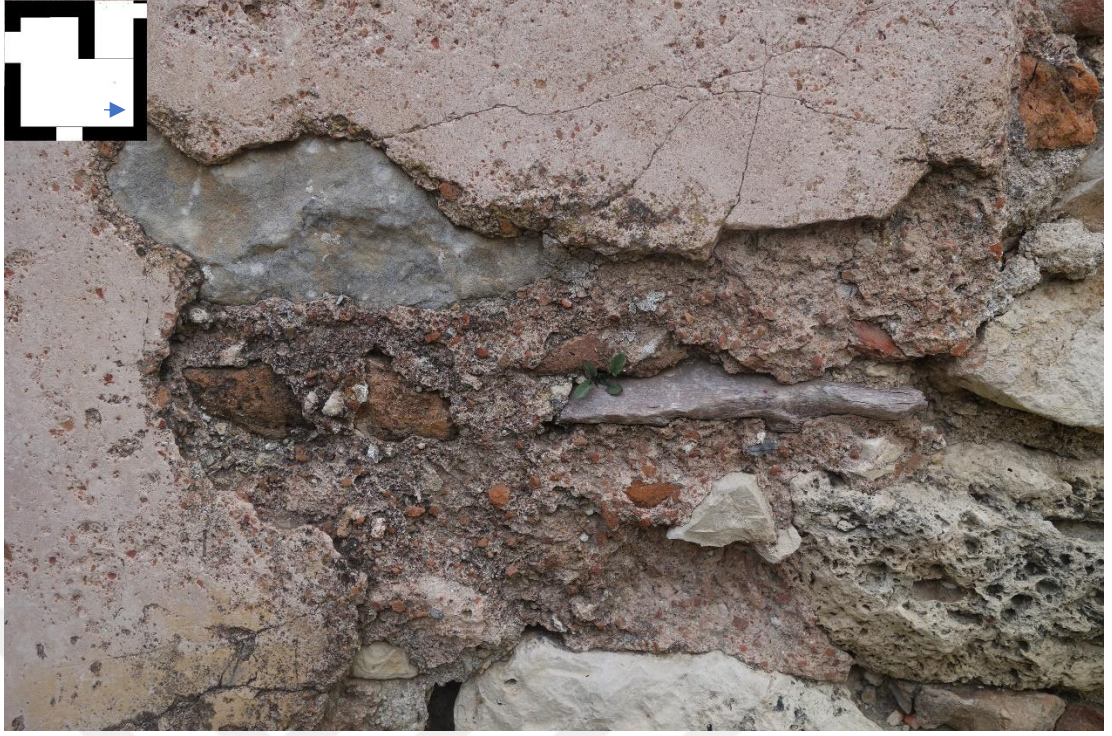
Resim 534 Soyunmalık Bölümü Kuzey Duvar Harç Malzeme (1 Nolu) a. Malzeme Kaybı b. Çatlak
