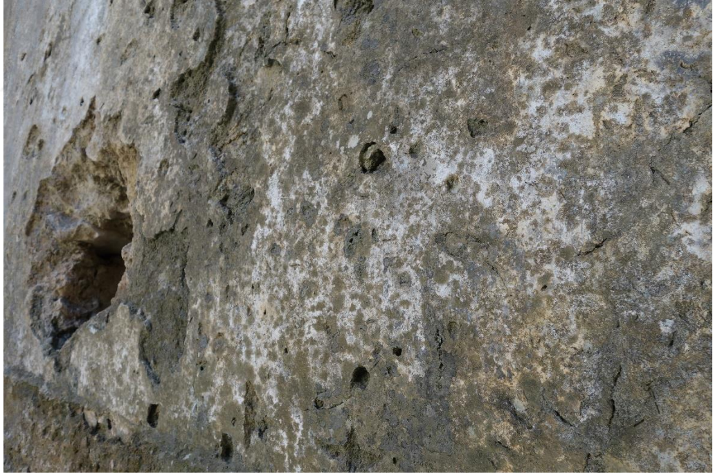
Resim 91 Tıraşlık Bölümü (2) Doğu Duvarı (5 Nolu) e. Biyolojik Oluşumlar
