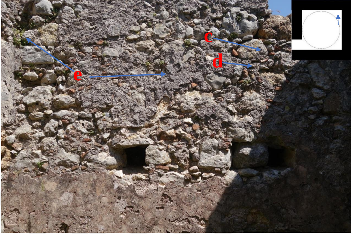
Resim 224 Kuzey Halvet Odası Kuzey Duvarı (3 Nolu) c. Petek Gözlülük d. Renk Değişimi e. Biyolojik Oluşumlar ve Köklü Bitkiler
