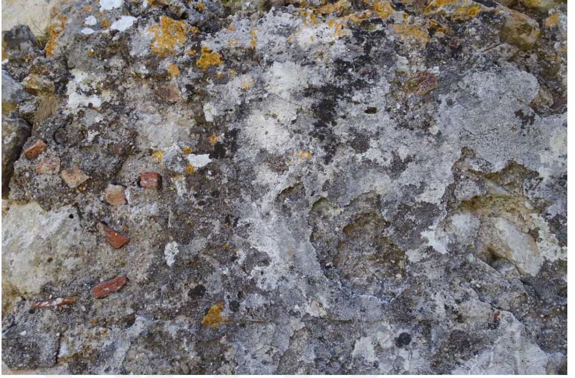
Resim 207 Sıcaklık Bölümü Doğu Duvarı (2 Nolu) d. Renk Değişimi e. Biyolojik Oluşumlar
