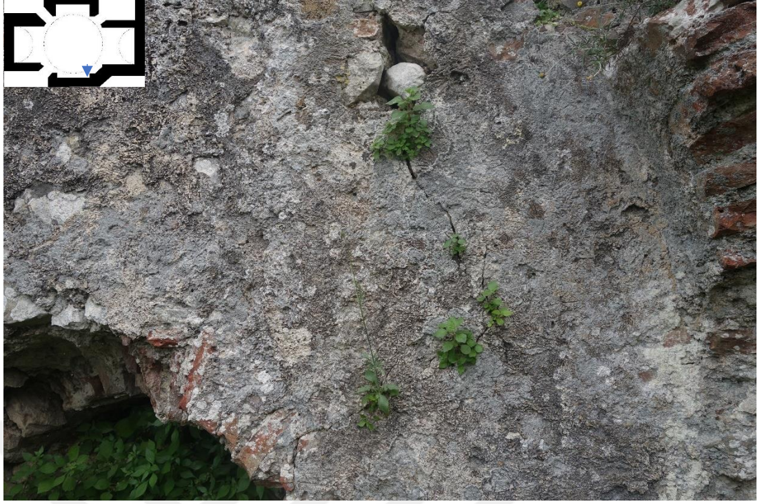
Resim 456 Sıcaklık Bölümü Güney Eyvanı (6 Nolu) d. Renk Değişimi b. Çatlak e. Köklü Bitkiler
