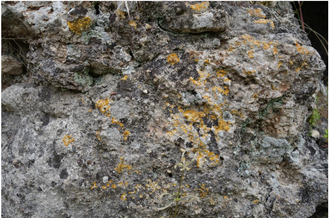
Resim 161 Su Deposu (1) Doğu Duvarı (9 Nolu) a. Malzeme Kaybı e. Biyolojik Oluşumlar ve Köklü Bitkiler
