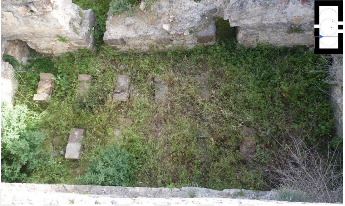
Resim 308 Sıcaklık Bölümü Zemin (5 Nolu) a. Malzeme Kaybı e. Köklü Bitkiler
