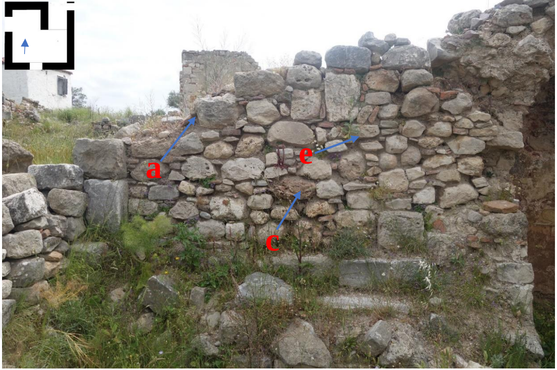
Resim 524 Soyunmalık Bölümü Batı Duvar (1 Nolu) a. Malzeme Kaybı c. Petek Gözlülük e. Köklü Bitkiler
