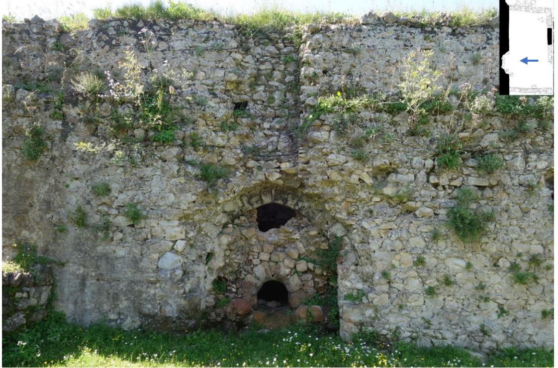
Resim 178 Külhan Bölümü ve Odunluk Kuzey Duvarı (11 Nolu) a. Malzeme Kaybı e. Biyolojik Oluşumlar
