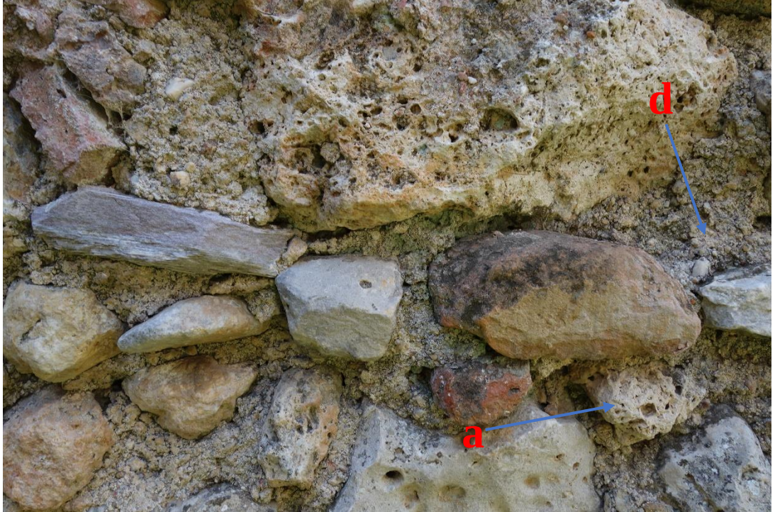
Resim 231 Kuzey Halvet Odası Güney Duvarı Harç Malzeme (3 Nolu) a. Malzeme Kaybı d. Renk Değişimi
