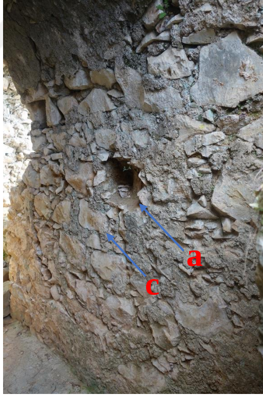
Resim 399 Tıraşlık Bölümü Batı Duvar (3 Nolu) a. Malzeme Kaybı c. Petek Gözlülük e. Biyolojik Oluşum
