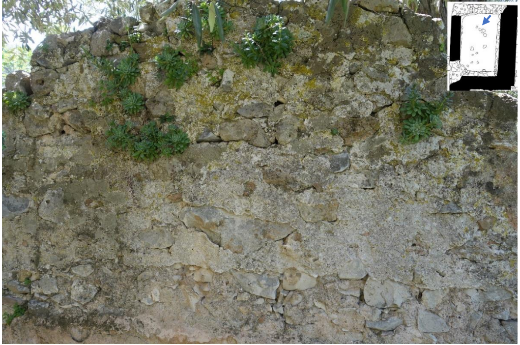
Resim 188 Ek Mekân Kuzey Duvarı (12 Nolu) a. Malzeme Kaybı e. Biyolojik Oluşumlar ve Köklü Bitkiler
