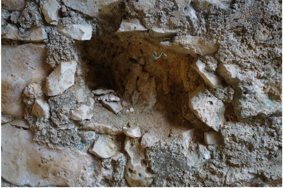
Resim 401 Tıraşlık Bölümü Batı Duvar Harç Malzeme (3 Nolu) a. Malzeme Kaybı d. Renk Değişimi
