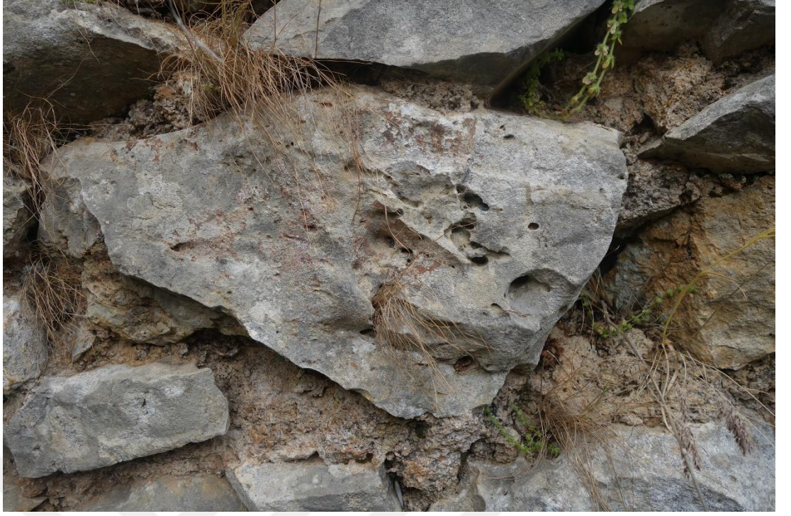
Resim 480 Batı Halvet Doğu Duvarı (8 Nolu) c. Petek Gözlülük
