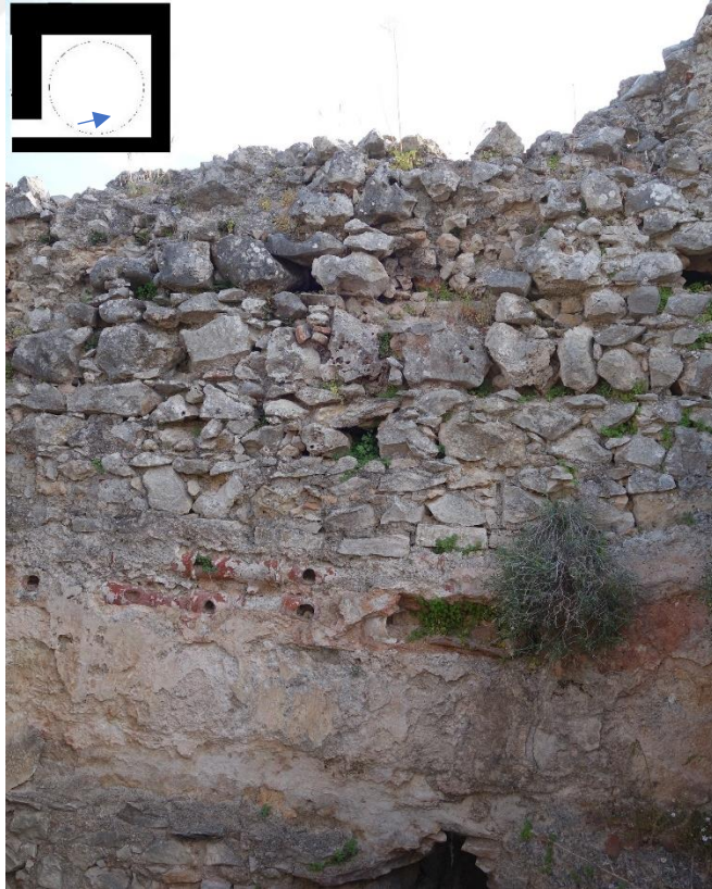
Resim 327 Doğu Halvet Bölümü Güney Duvar (6 Nolu) a. Malzeme Kaybı c. Petek Gözlülük e. Köklü Bitkiler
