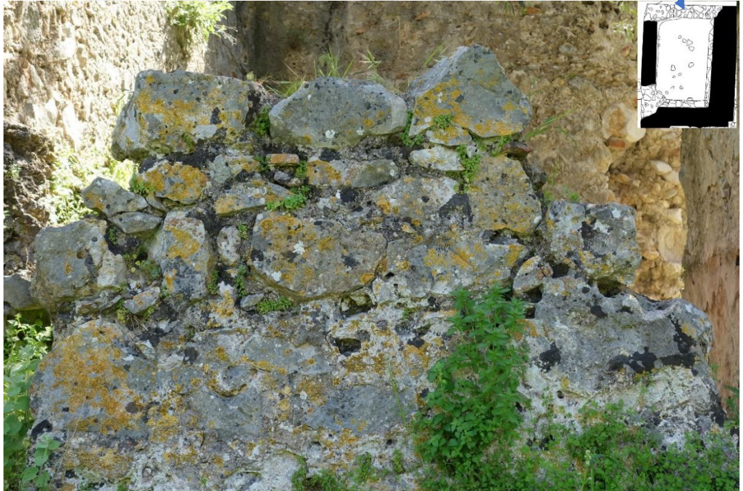
Resim 186 Ek Mekân Batı Duvarı (12 Nolu) a. Malzeme Kaybı e. Biyolojik Oluşumlar ve Köklü Bitkiler
