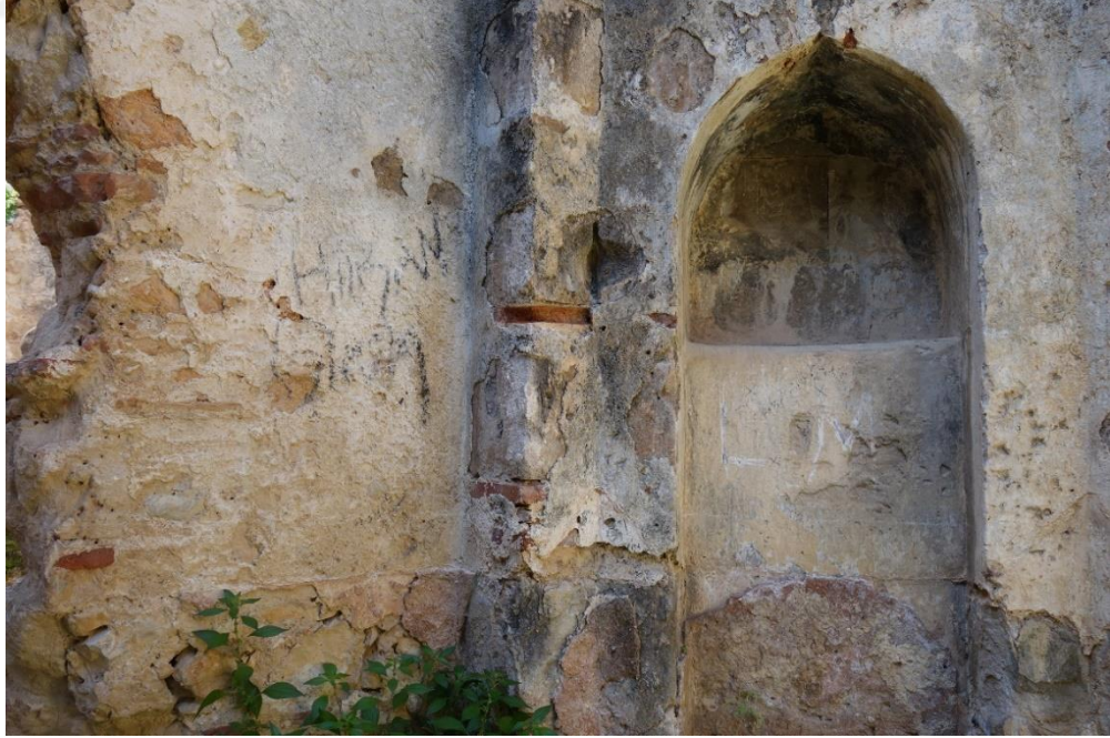
Resim 123 Sıcaklık Bölümü Güney Duvarı (6 Nolu) h. Vandalizm
