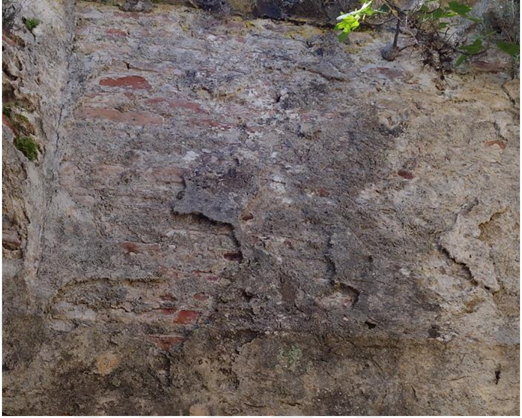
Resim 64 Tıraşlık Bölümü Güney Duvarı (3 Nolu) d. Renk Değişimi e. Biyolojik Oluşum ve Köklü Bitkiler
