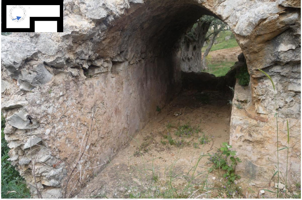
Resim 496 Su Deposu Bölümü (1) Genel Görünüş (9 Nolu)
