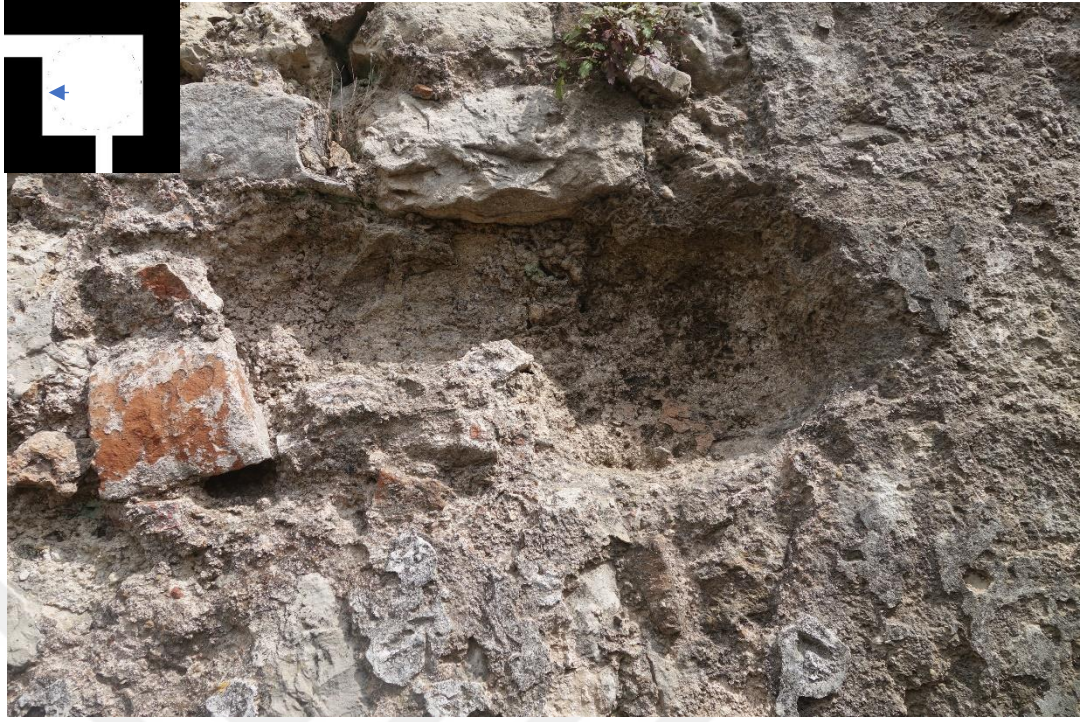
Resim 558 Sıcaklık Bölümü Güney Duvarı Harç Malzeme (3 Nolu) a. Malzeme Kaybı
