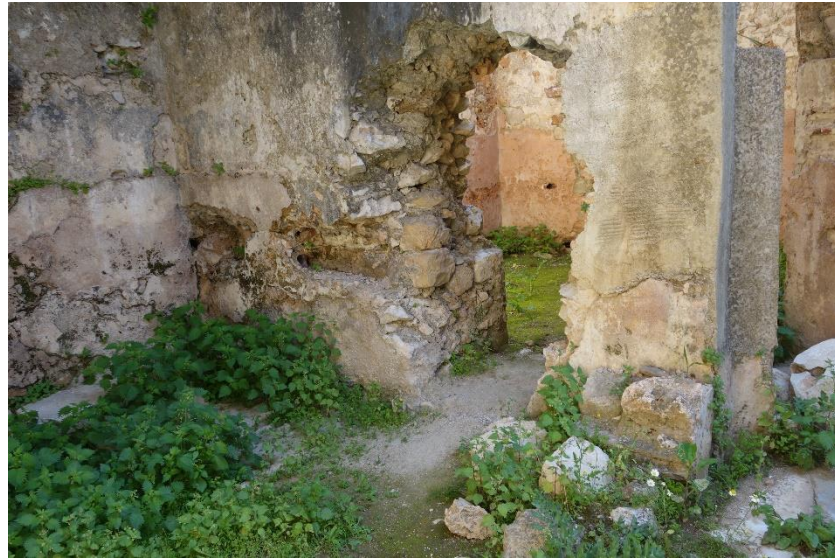
Resim 119 Sıcaklık Bölümü Kuzey Eyvan (6 Nolu) 1. Hatalı Restorasyon (Çimento kullanımı)
