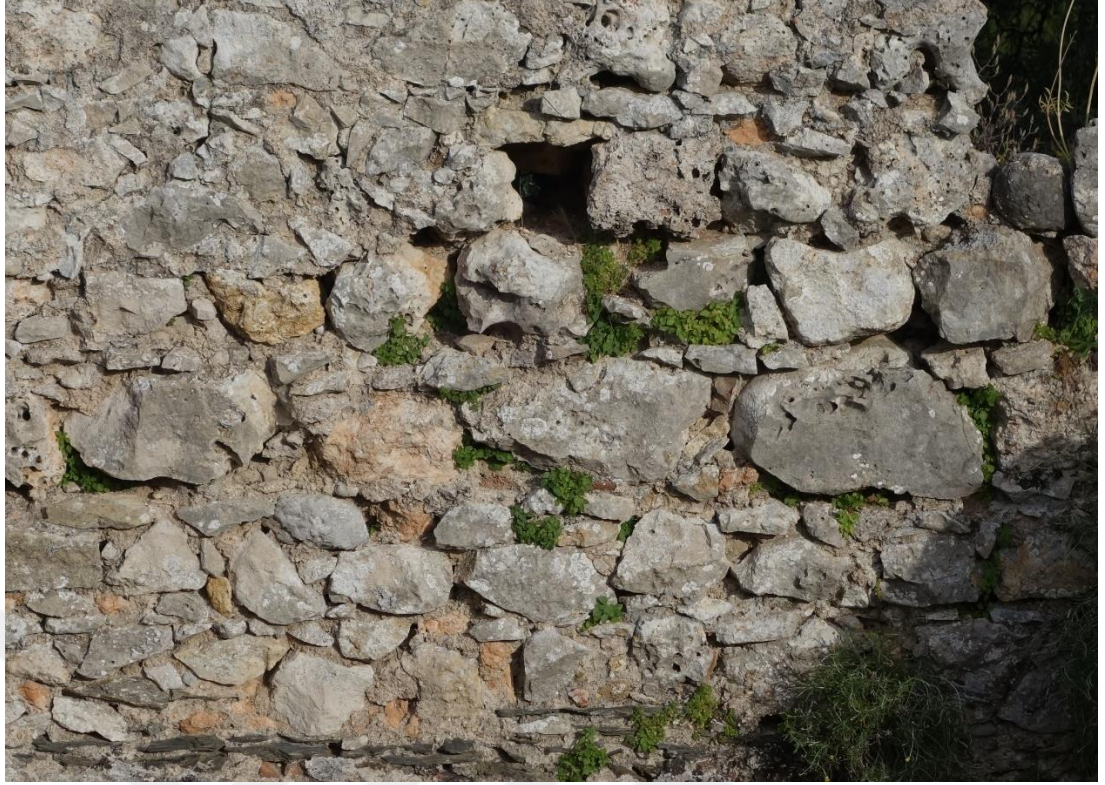
Resim 312 Sıcaklık Bölümü Doğu Duvarı (5 Nolu) c. Petek Gözlülük e. Köklü Bitkiler
