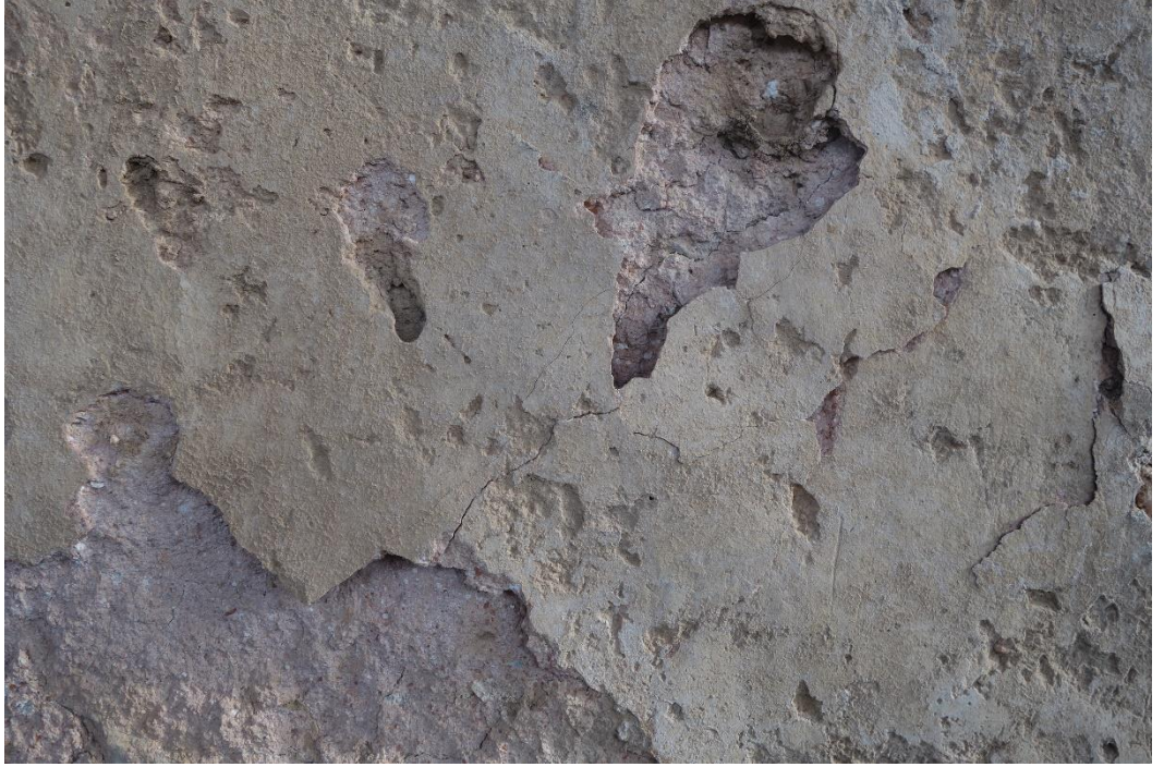
Resim 582 Sıcaklık Bölümü Güney Sıva Detayı a. Malzeme Kayıpları b. Çatlak
