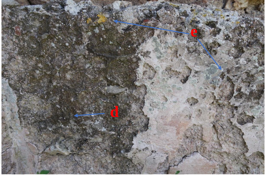
Resim 213 Sıcaklık Bölümü Güney Duvarı (2 Nolu) d. Renk Değişimi e. Biyolojik Oluşumlar
