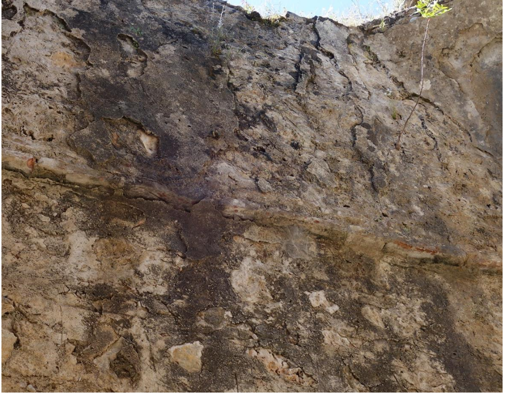
Resim 45 Aralık Bölümü Güney Duvarı (2 Nolu) e. Köklü Bitkiler d. Renk Değişimi
