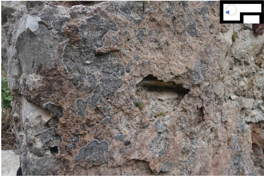
Resim 509 Su Deposu Bölümü (1) Güney Duvar Sıva Malzeme (9 Nolu) a. Malzeme Kaybı d. Renk Değişimi e. Biyolojik Oluşumlar ve Köklü Bitkiler
