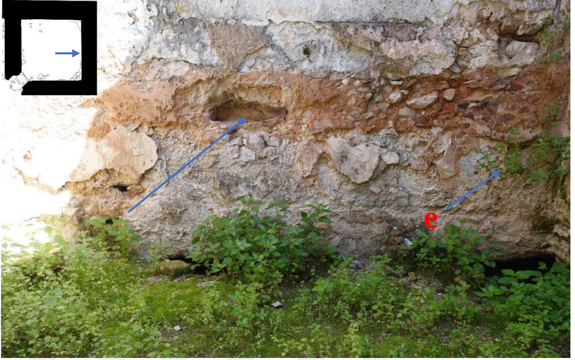
Resim 134 Batı Halvet Odası Kuzey Duvarı (7 Nolu) a. Malzeme Kaybı e. köklü Bitkiler
