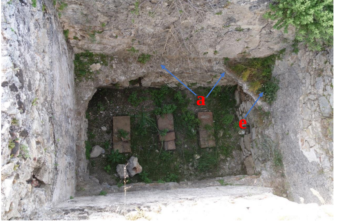
Resim 297 Traşlık Bölümü Zemin (4 Nolu) a. Malzeme Kaybı e. Köklü Bitkiler
