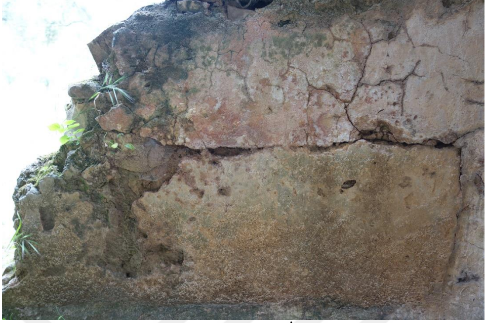
Resim 162 Su Deposu (1) Doğu İç Duvarı (9 Nolu) a. Malzeme Kaybı b. Çatlaklar e. Biyolojik Oluşumlar ve Köklü Bitkiler
