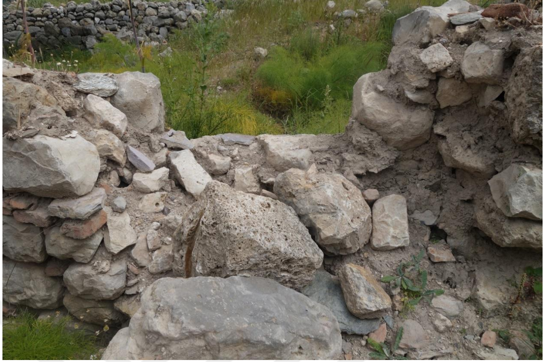
Resim 530 Soyunmalık Bölümü Güney Duvar (1 Nolu) a. Malzeme Kaybı (Yıkıntı)
