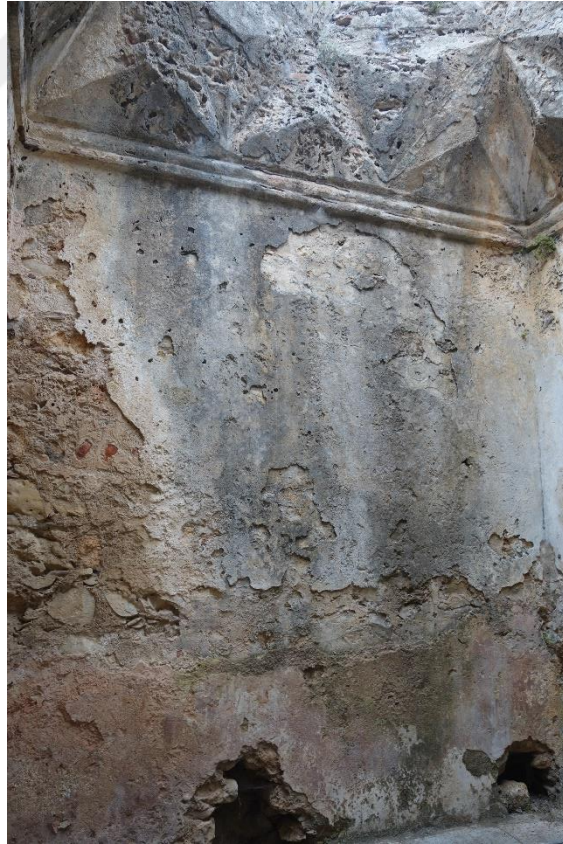
Resim 93 Tıraşlık Bölümü (2) Batı Duvarı (5 Nolu) a. Malzeme Kaybı
