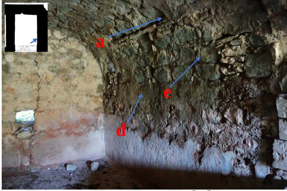
Resim 171 Su Deposu (2) Kuzey Duvarı ve Üst Örtü (10 Nolu) a. Renk Değişimi e. Biyolojik Oluşumlar
