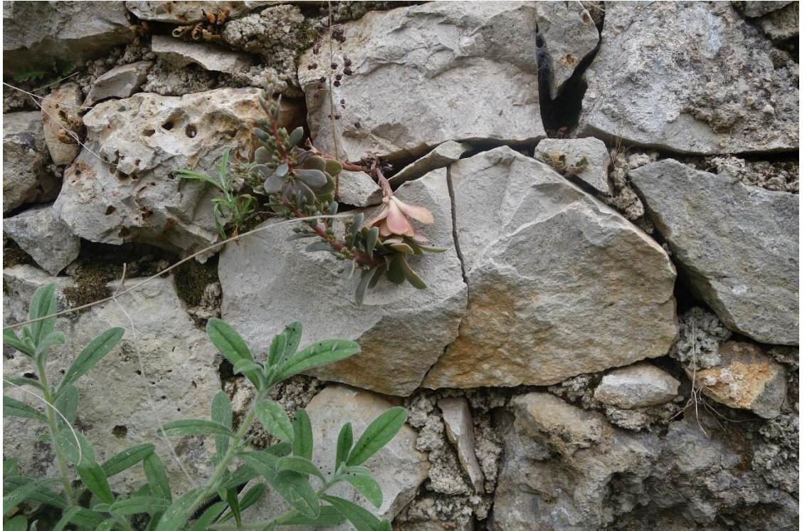
Resim 489 Batı Halvet Güney Duvarı (8 Nolu) b. Yarık c. Petek Gözlülük e. Köklü Bitkiler
