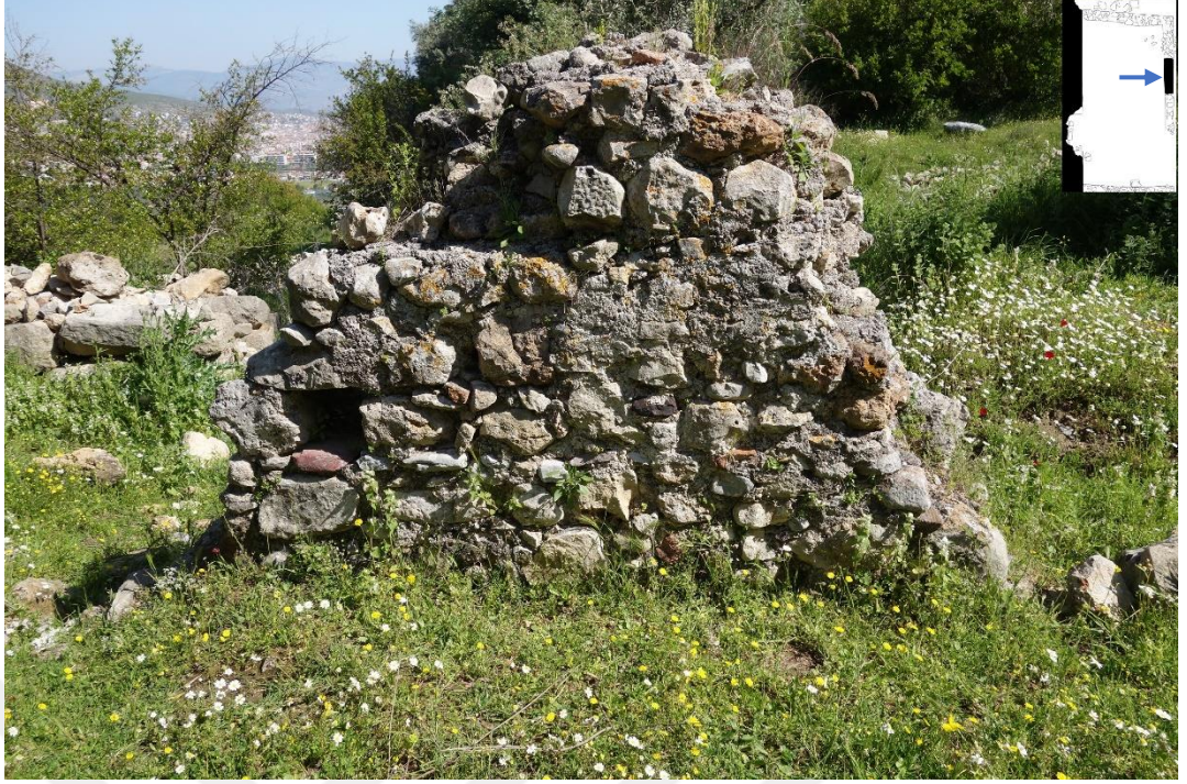
Resim 175 Külhan Bölümü ve Odunluk Kuzey Duvarı (11 Nolu) a. Malzeme Kaybı
