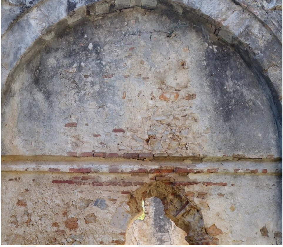
Resim 122 Sıcaklık Bölümü Güney Duvarı (6 Nolu) a. Malzeme Kaybı d. Renk Değişimi e. Köklü Bitkiler
