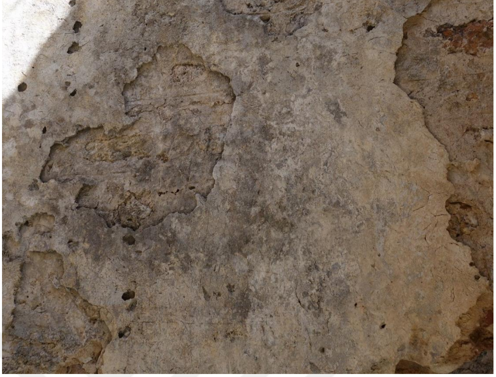
Resim 48 Aralık Bölümü Sıva Malzeme (2 Nolu) a. Malzeme Kaybı b. Çatlak c. Petek Gözlülük d. Renk Değişimi
