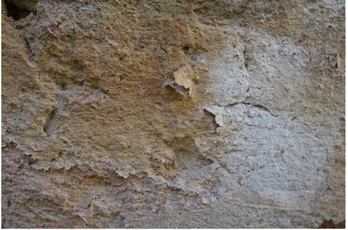
Resim 62 Tıraşlık Bölümü Güney Duvarı (3 Nolu) f. Kabuklanma g. Tuzlanma
