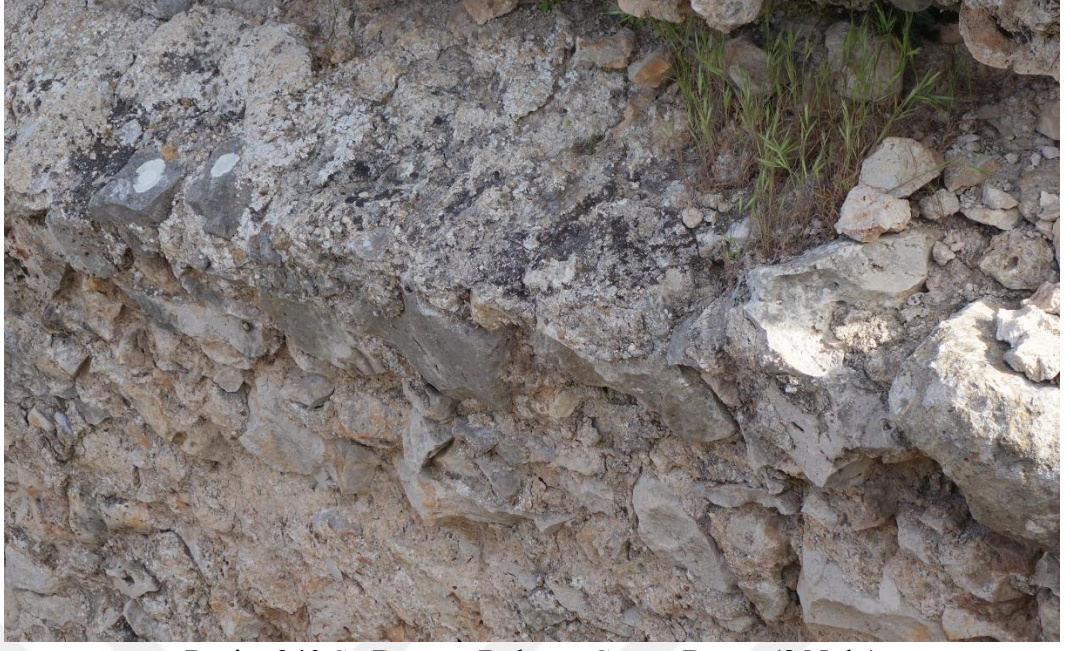
Resim 340 Su Deposu Bölümü Güney Duvar (8 Nolu) a. Malzeme Kaybı d. Renk Değişimi
