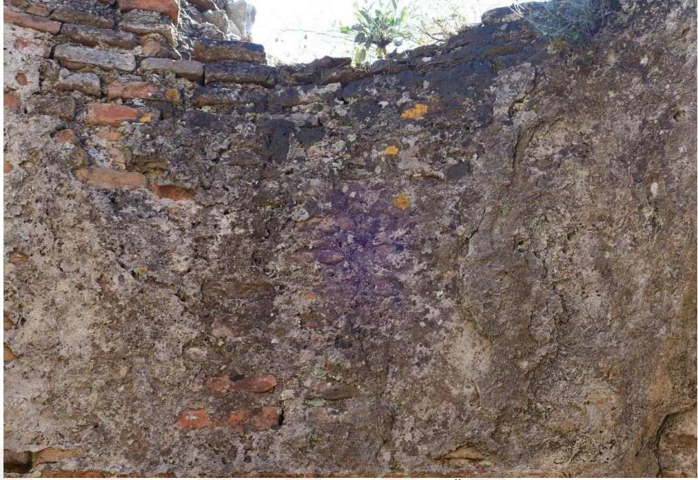
Resim 154 Doğu Halvet Odası Geçiş Ögesi (8 Nolu) a. Malzeme Kaybı d. Renk Değişimi e. Biyolojik Oluşumlar ve Köklü Bitkiler
