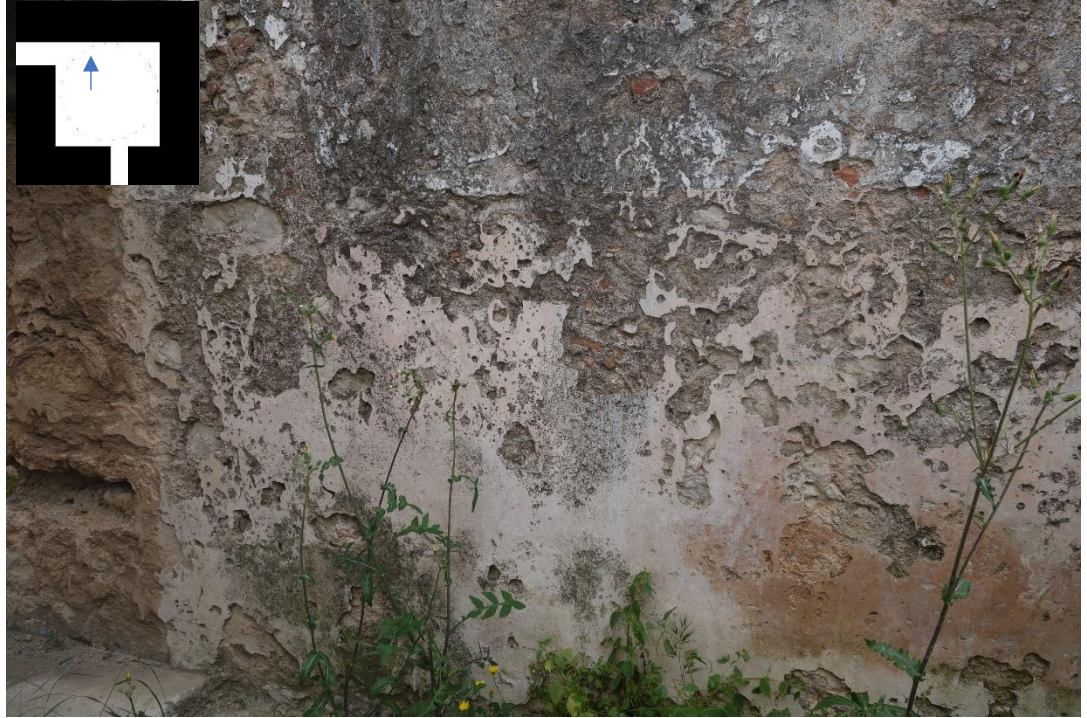
Resim 559 Sıcaklık Bölümü Batı Duvarı Sıva Malzeme (3 Nolu) a. Malzeme Kaybı d. Renk Değişimi
