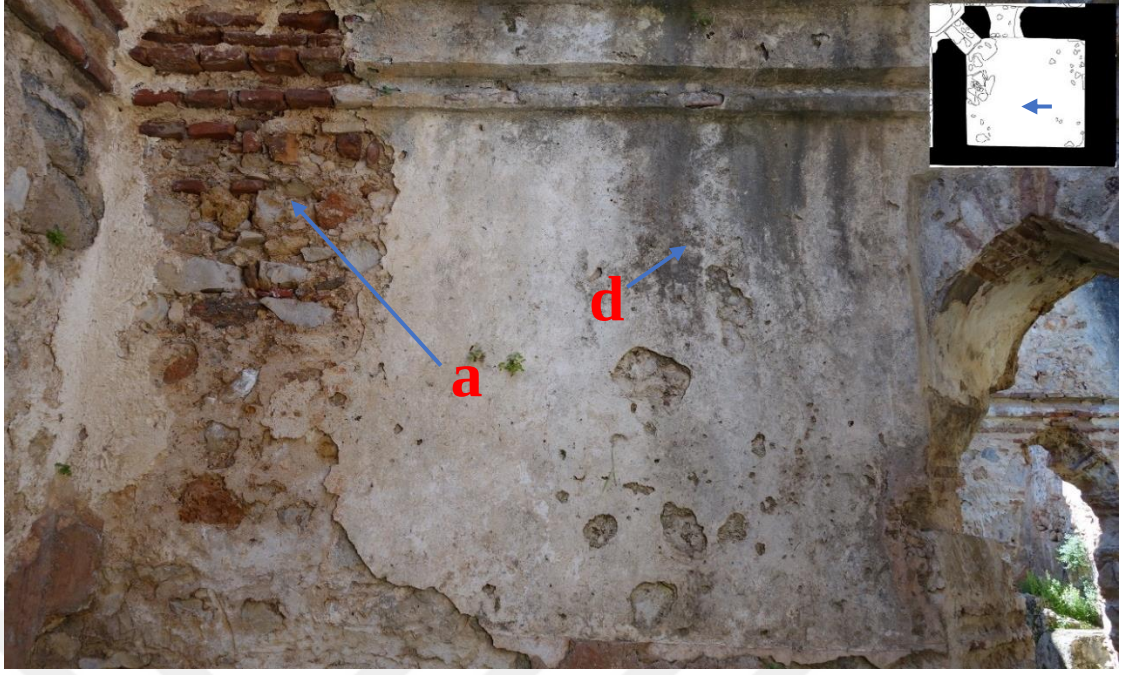
Resim 152 Doğu Halvet Odası Güney Duvarı (8 Nolu) a. Malzeme Kaybı d. Renk Değişimi
