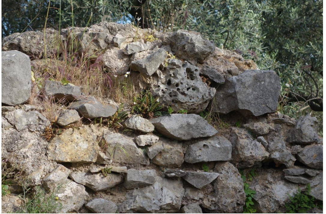
Resim 325 Doğu Halvet Bölümü Doğu Duvar (6 Nolu) a. Malzeme Kaybı c. Petek Gözlülük e. Köklü Bitkiler
