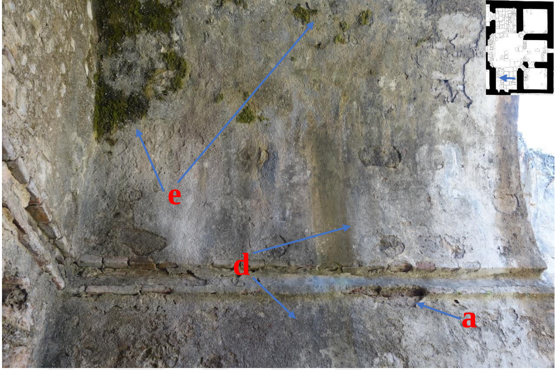
Resim 108 Sıcaklık Bölümü Doğu Eyvan (6 Nolu) a. Malzeme Kaybı d. Renk Değişimi e. Biyolojik Oluşumlar
