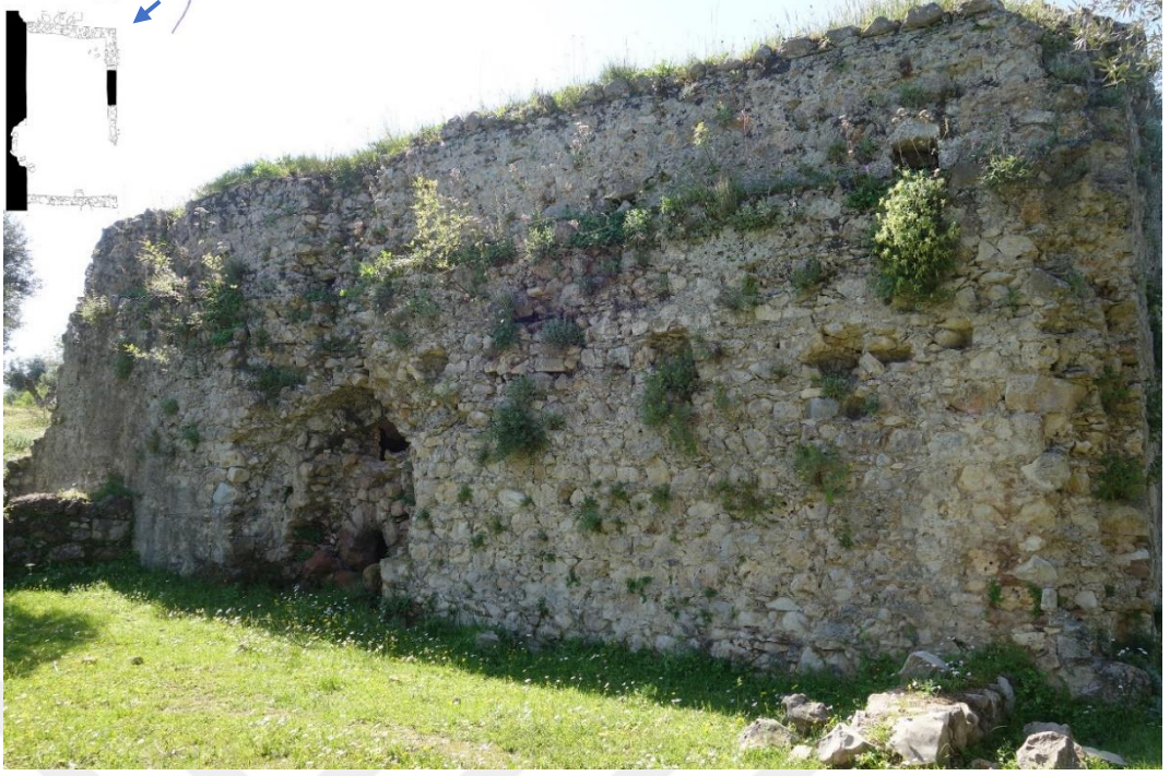
Resim 177 Külhan Bölümü ve Odunluk Kuzey Duvarı (11 Nolu) a. Malzeme Kaybı c. Petek Gözlülük e. Biyolojik Oluşumlar
