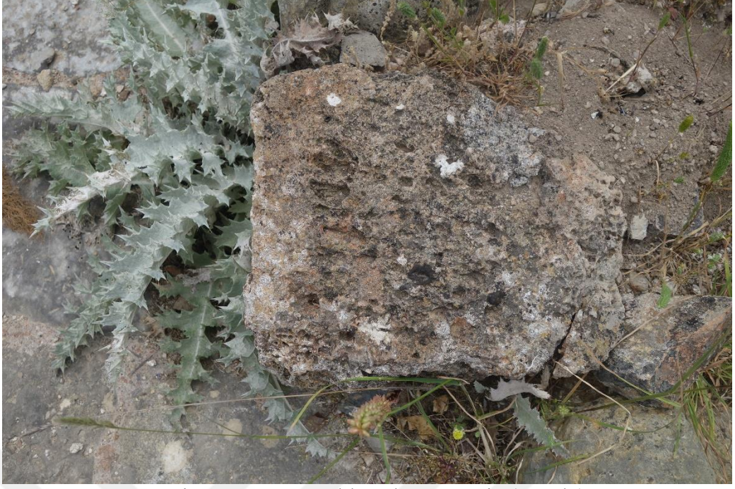
Resim 520 Soyunmalık Bölümü Zemin (1 Nolu) b. Çatlak c. Petek Gözlülük e. Biyolojik Oluşumlar ve Köklü Bitkiler
