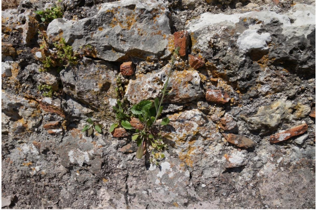
Resim 254 Su Deposu Doğu Duvarı (5 Nolu) c. Petek Gözlülük e. Biyolojik Oluşumlar ve Köklü Bitkiler
