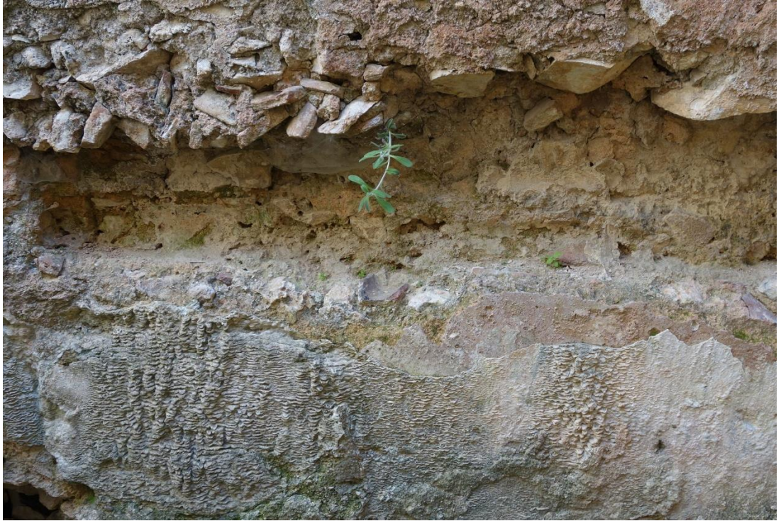
Resim 59 Tıraşlık Bölümü Kuzey Duvarı (3 Nolu) a. Malzeme Kaybı d. Renk Değişimi e. Köklü Bitkiler f. Kabuklanma
