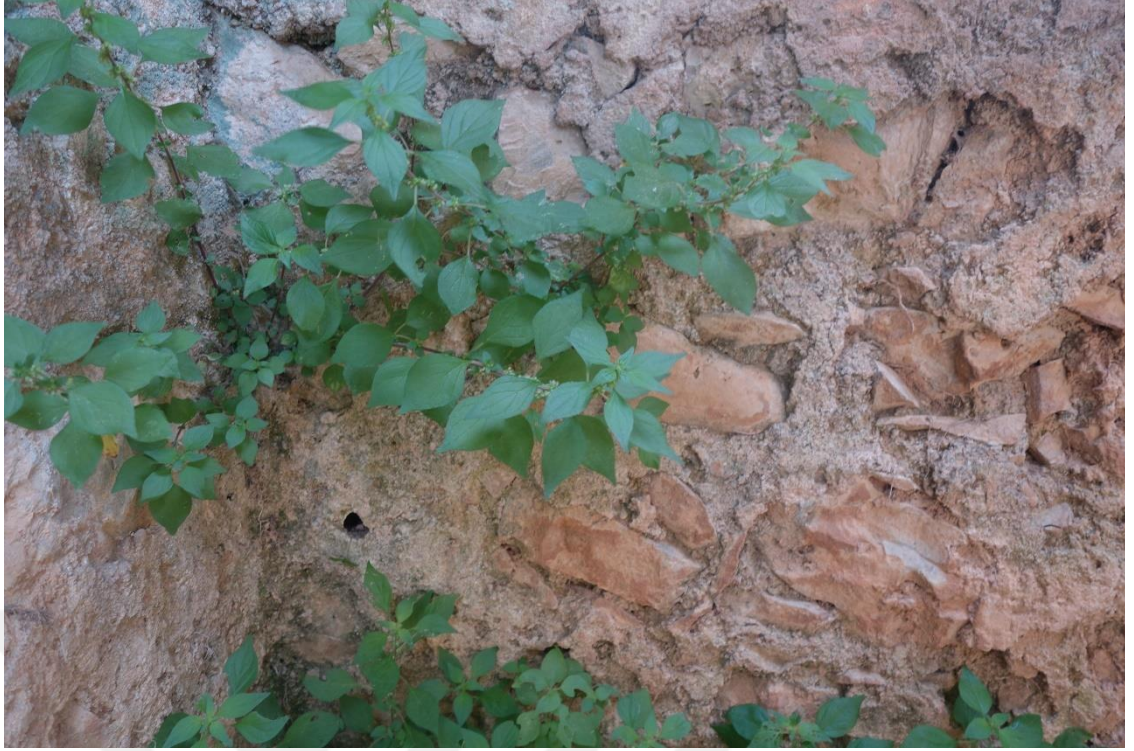
Resim 390 Aralık Bölümü Batı Duvarı (2 Nolu) a. Malzeme Kaybı e. Biyolojik Oluşum ve Köklü Bitkiler
