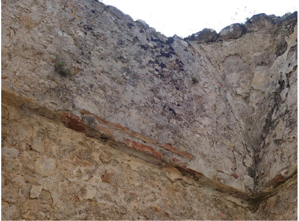
Resim 33 Aralık Bölümü Doğu Duvarı (2 Nolu) d. Renk Değişimi e. Köklü Bitkiler ve Biyolojik Oluşum
