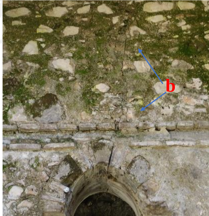
Resim 117 Sıcaklık Bölümü Kuzey Eyvan (6 Nolu) b. Çatlak
