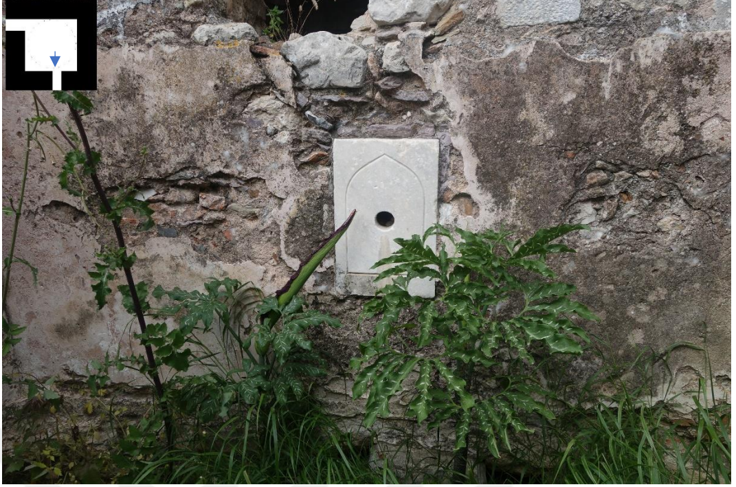
Resim 546 Sıcaklık Bölümü Doğu Duvarı (3 Nolu) a. Malzeme Kaybı d. Renk Değişimi e. Köklü Bitkiler
