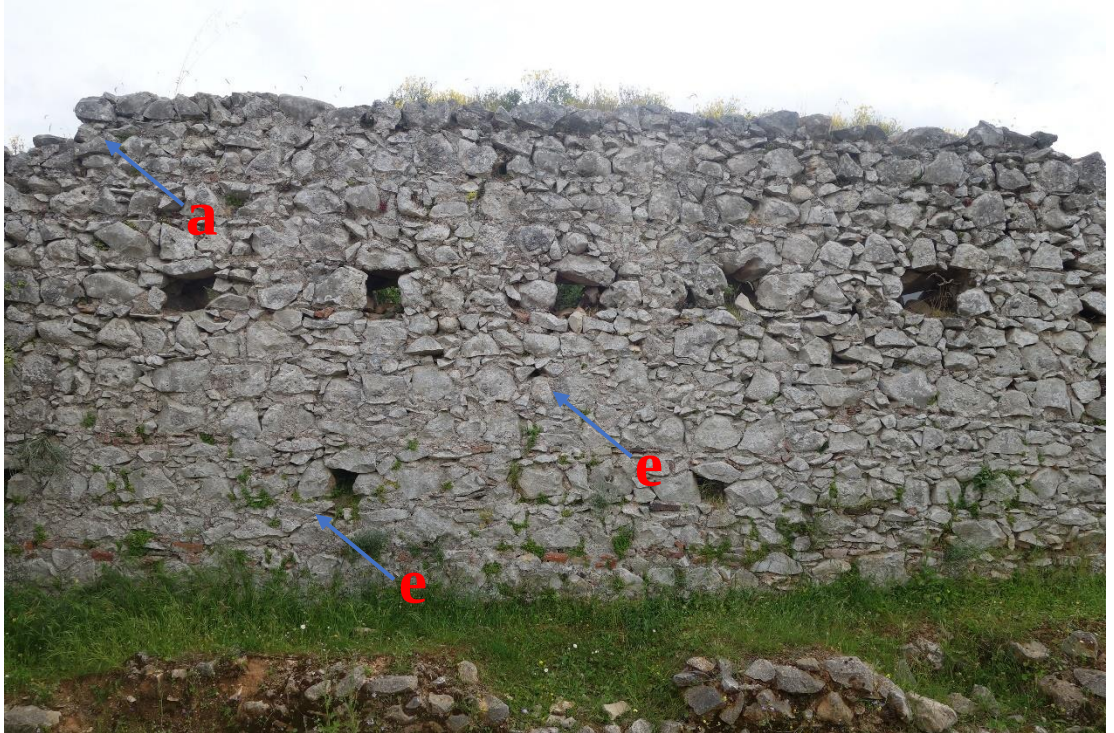
Resim 383 Soyunmalık Bölümü Güney Duvar (1 Nolu) a. Malzeme Kaybı e. Biyolojik Oluşumlar ve Köklü Bitkiler
