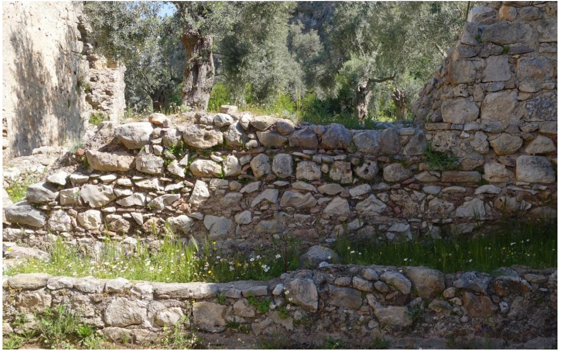
Resim 23 Soyunmalık Bölümü Kuzey Duvarı (1 Nolu) a. Malzeme Kaybı e. Köklü Bitkiler
