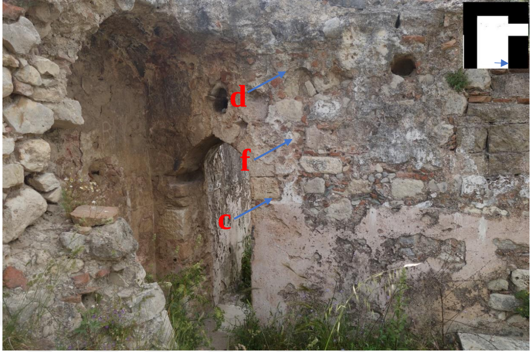
Resim 538 Aralık Bölümü Kuzey Duvarı (2 Nolu) c. Petek Gözlülük d. Renk Değişimi f. Kabuklanma
