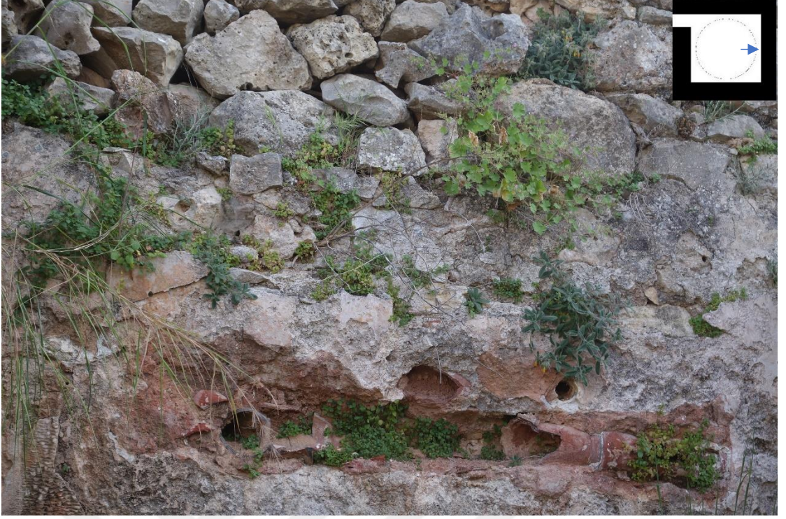
Resim 334 Batı Halvet Bölümü Güney Duvar (7 Nolu) a. Malzeme Kaybı d. Renk Değişimi e. Köklü Bitkiler
