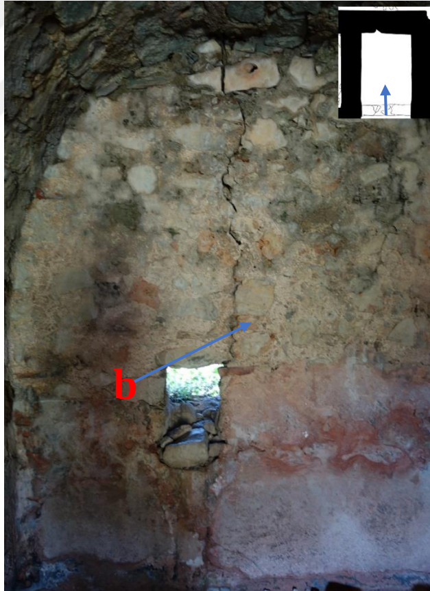
Resim 170 Su Deposu (2) Batı Duvarı (10 Nolu) b. Çatlak ve Yarık
