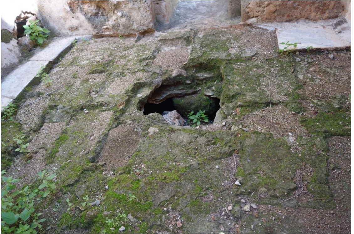
Resim 87 Tıraşlık Bölümü Zemin (2) (5 Nolu) a. Malzeme Kaybı e. Biyolojik Oluşumlar ve Köklü Bitkiler
