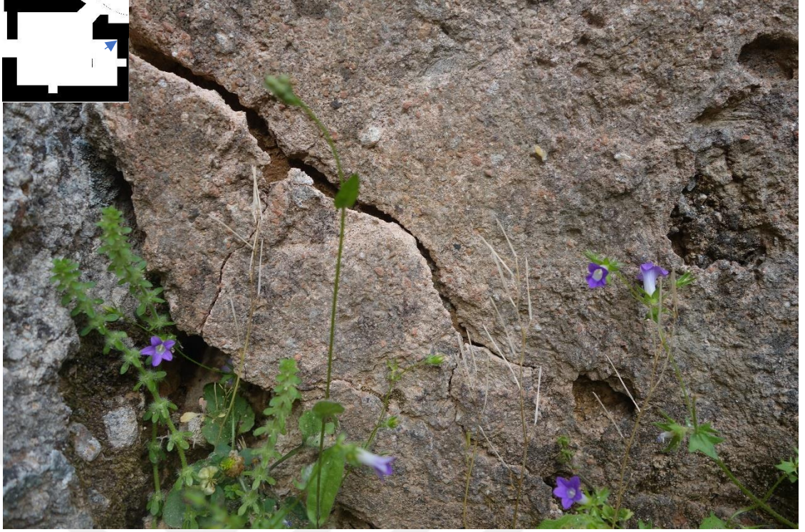
Resim 430 Ilıklık Bölümü Batı Duvarı Sıva Malzeme (4 Nolu) a. Malzeme Kaybı b. Yarık d. Renk Değişimi
