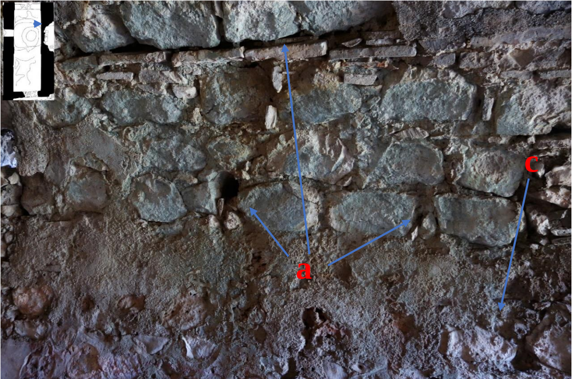
Resim 168 Su Deposu (1) Harç ve Sıva Malzeme (9 Nolu) a. Malzeme Kaybı c. Petek Gözlülük
