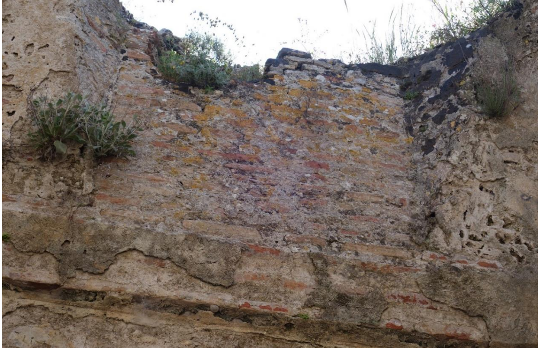
Resim 53 Tıraşlık Bölümü Doğu Duvarı (3 Nolu) d. Renk Değişimi e. Köklü Bitkiler ve Biyolojik Oluşum
