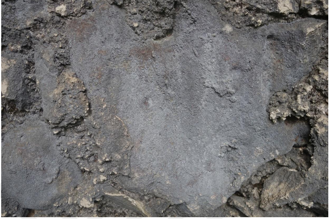
Resim 434 Sıcaklık Bölümü Doğu Eyvanı (5 Nolu) d. Renk Değişimi
