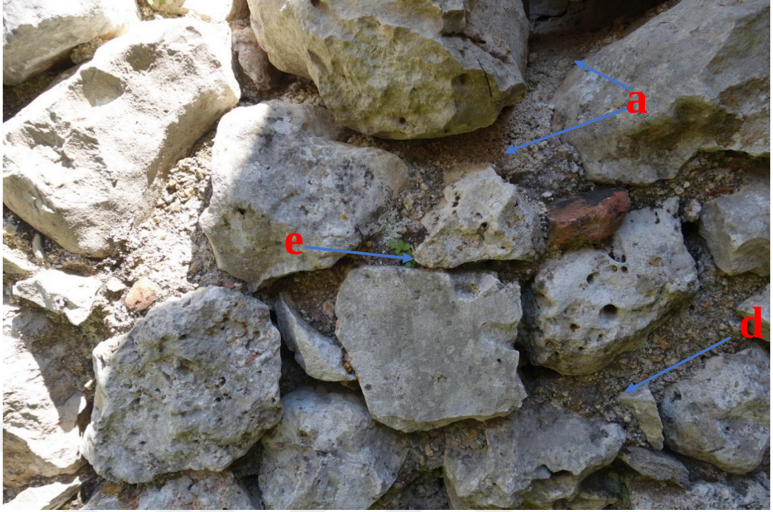
Resim 248 Güney Halvet Odası Kuzey Duvar Harç Malzeme (4 Nolu) a. Malzeme Kaybı d. Renk Değişimi e. Köklü Bitkiler
