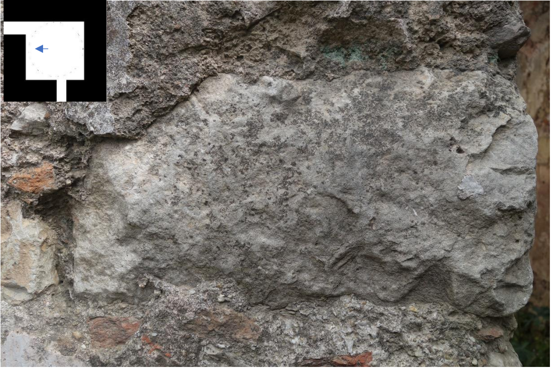
Resim 555 Sıcaklık Bölümü Güney Duvarı (3 Nolu) d. Renk Değişimi
