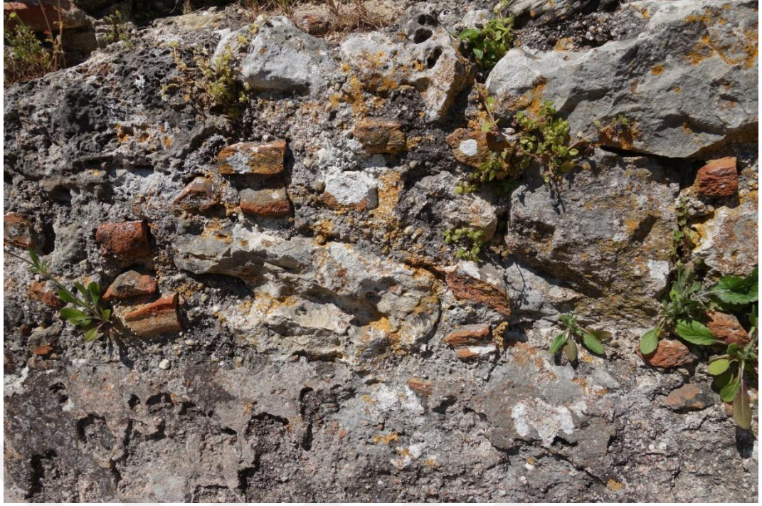
Resim 256 Su Deposu Batı Duvarı (5 Nolu) a. Malzeme Kaybı d. Renk Değişimi e. Biyolojik Oluşumlar ve Köklü Bitkiler
