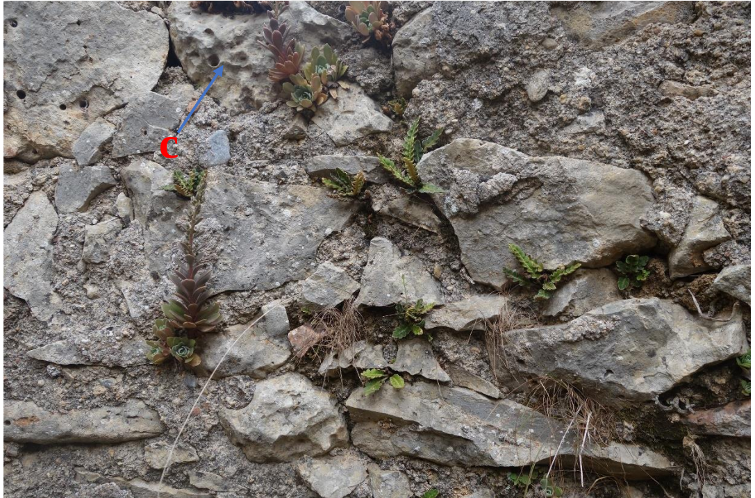
Resim :407 Hela Bölümü Kuzey ve Doğu Duvar (3 Nolu) c. Petek Gözlülük e. Köklü Bitkiler
