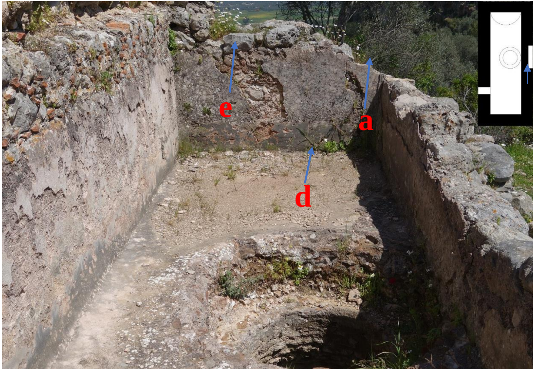
Resim 257 Su Deposu Kuzey Duvarı (5 Nolu) a. Malzeme Kaybı d. Renk Değişimi e. Köklü Bitkiler
