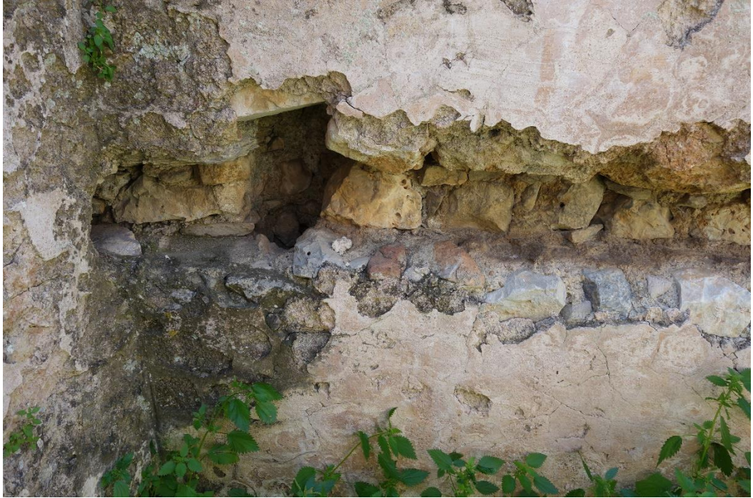
Resim 245 Güney Halvet Odası Güney Duvarı (4 Nolu) a. Malzeme Kaybı d. Renk Değişimi e. Köklü Bitkiler
