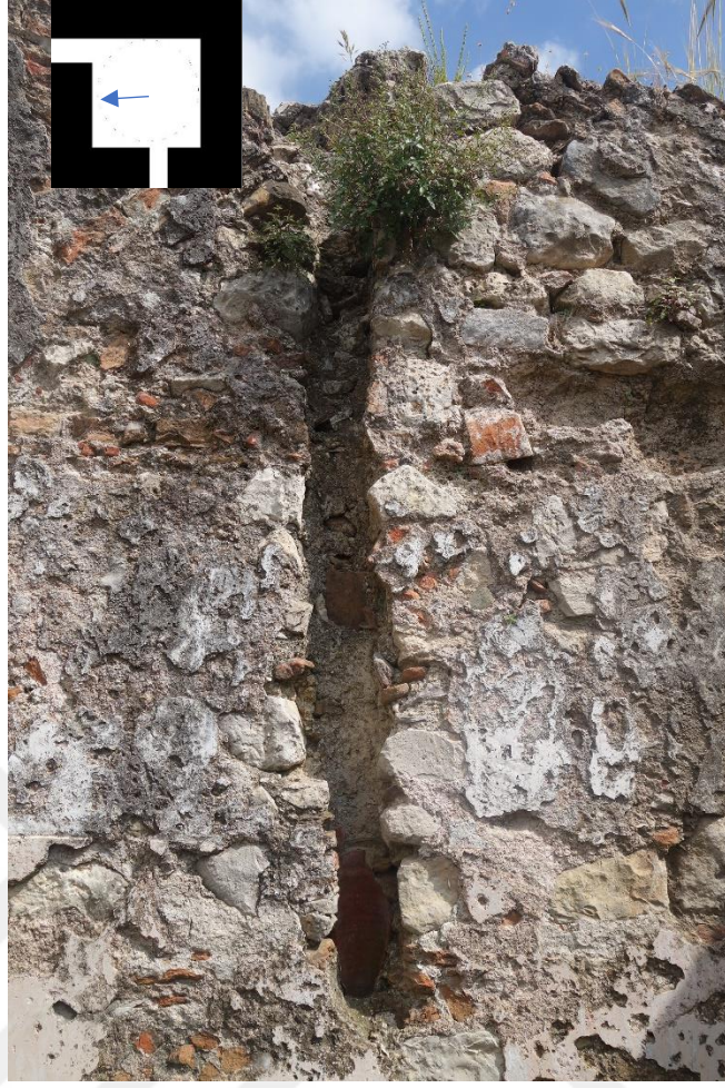
Resim 556 Sıcaklık Bölümü Güney Duvarı (3 Nolu) a. Malzeme Kaybı e. Biyolojik Oluşumlar
