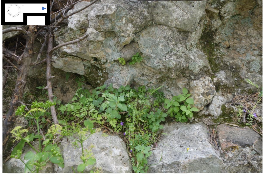
Resim 500 Su Deposu Bölümü (1) Doğu Duvarı (9 Nolu) e. Biyolojik Oluşumlar ve Köklü Bitkiler
