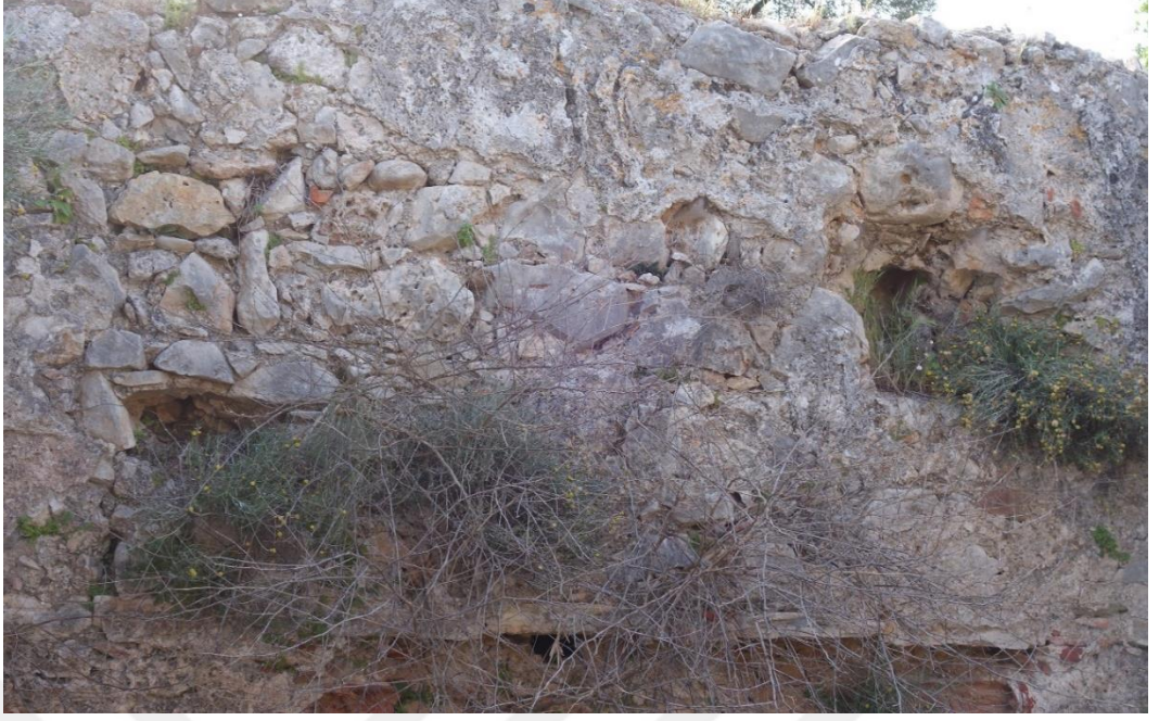
Resim 314 Sıcaklık Bölümü Batı Duvarı (5 Nolu) a. Malzeme Kaybı e. Köklü Bitkiler
