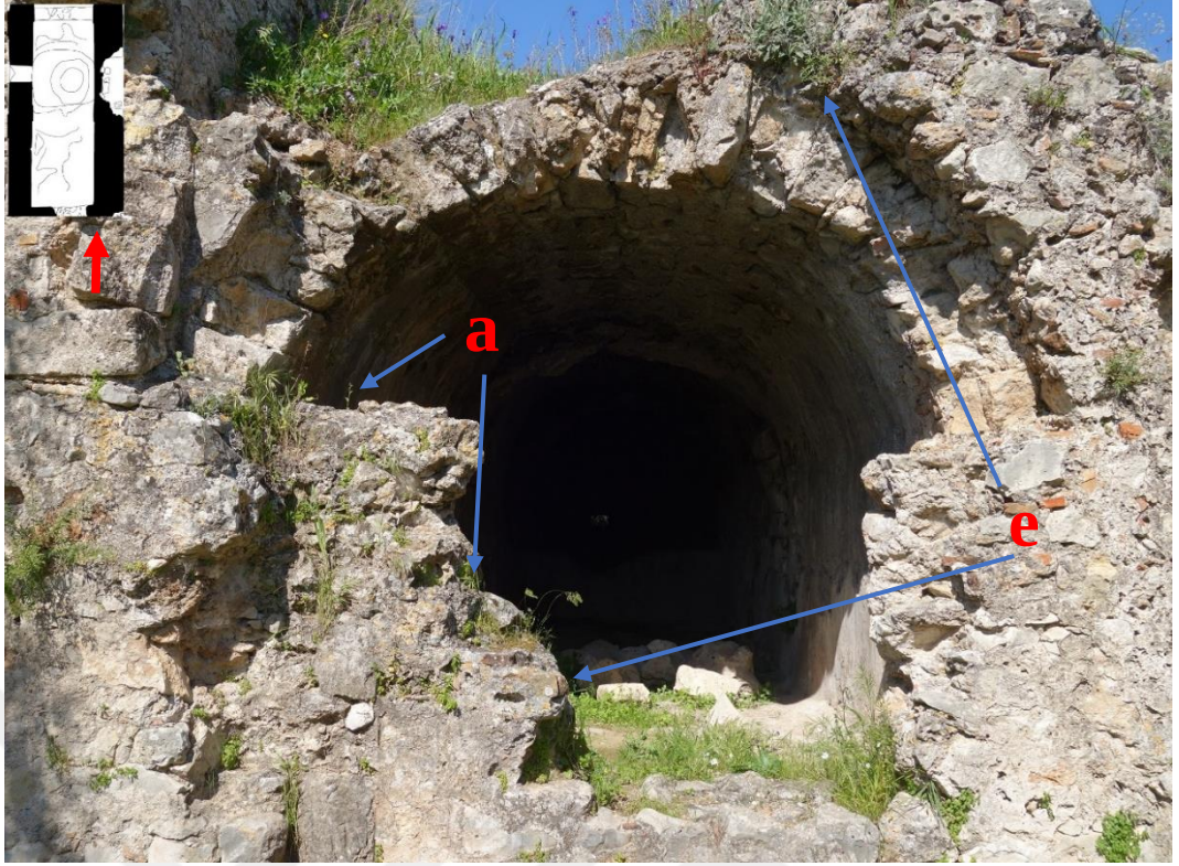
Resim 160 Su Deposu (1) Doğu Duvarı (9 Nolu) a. Malzeme Kaybı e. Biyolojik Oluşumlar ve Köklü Bitkiler
