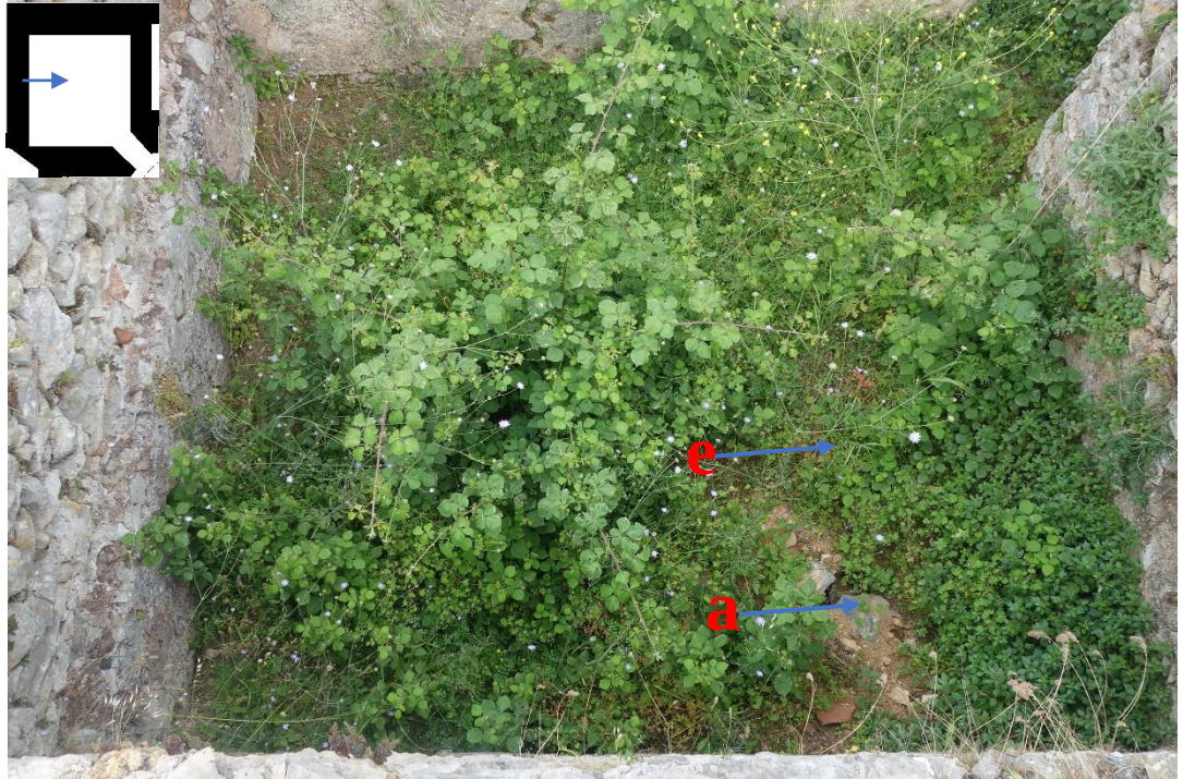
Resim 477 Batı Halvet Bölümü Zemin (8 Nolu) a. Malzeme Kaybı e. Köklü Bitkiler
