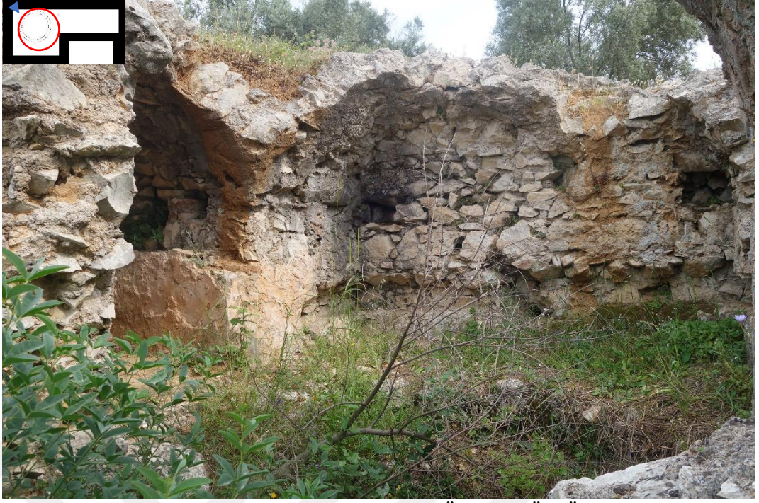
Resim 506 Su Deposu Bölümü (1) Geçiş Ögesi ve Üst Örtü (9 Nolu) a. Malzeme Kaybı
