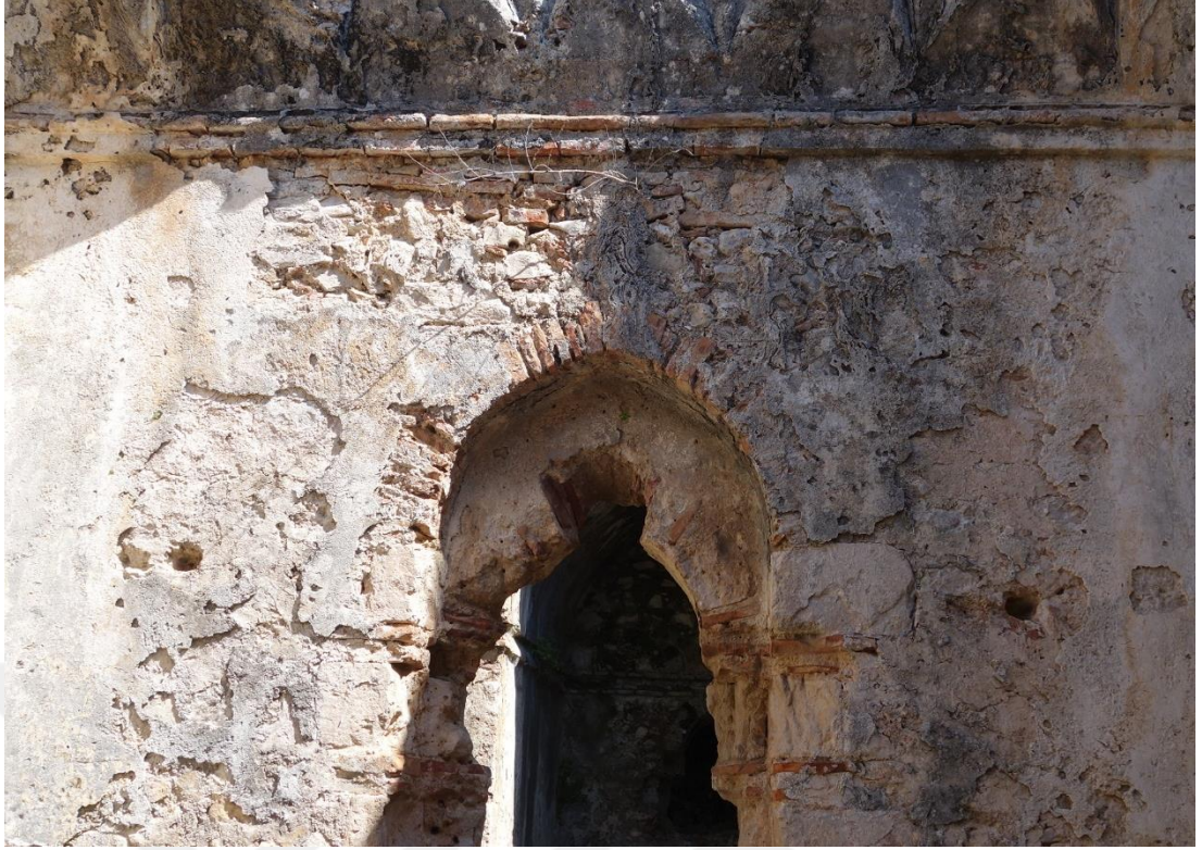
Resim 76 Ilıklık Bölümü Kuzey Duvarı (4 Nolu) a. Malzeme Kaybı d. Renk Değişimi e. Köklü Bitkiler
