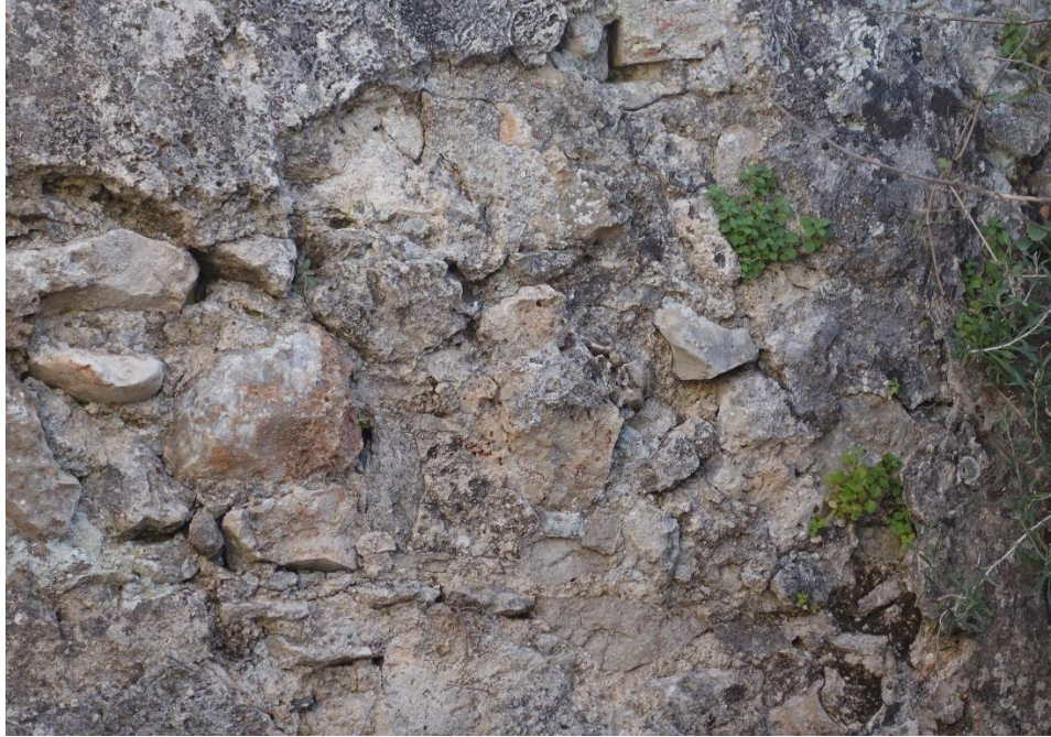
Resim 305 Traşlık Bölümü Güney Duvar (4 Nolu) d. Renk Değişimi e. Biyolojik Oluşumlar ve Köklü Bitkiler
