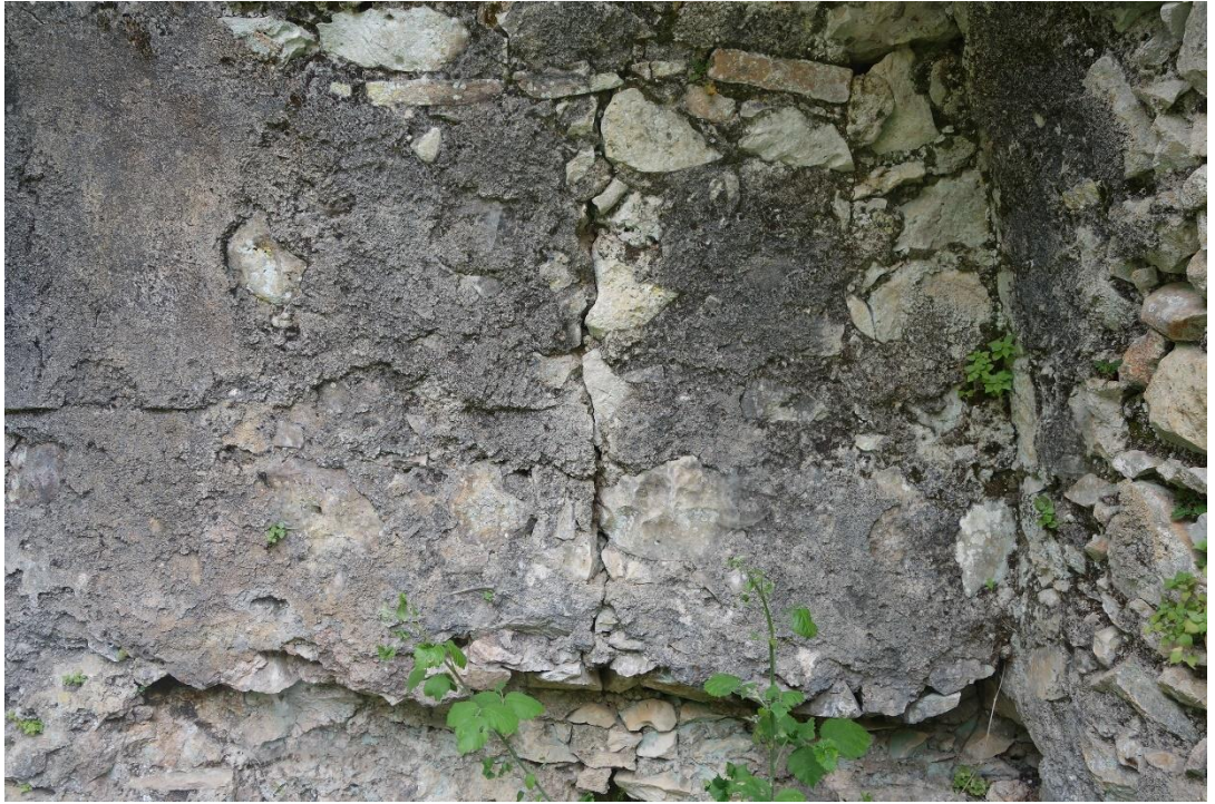
Resim 441 Sıcaklık Bölümü Batı Eyvanı (6 Nolu) b. Yarık
