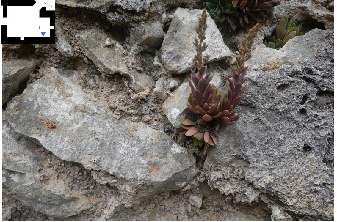
Resim 429 Ilıklık Bölümü Kuzey Duvarı Sıva Malzeme (4 Nolu) a. Malzeme Kaybı d. Renk Değişimi e. Köklü Bitkiler
