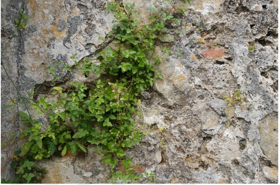
Resim 412 Ilıkkık Bölümü Doğu Duvarı (4 Nolu) e. Biyolojik Oluşum ve Köklü Bitkiler
