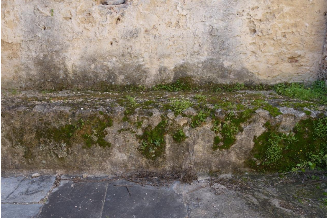
Resim 78 Ilıklık Bölümü Güney Duvarı (4 Nolu) e. Biyolojik Oluşumlar ve Köklü Bitkiler
