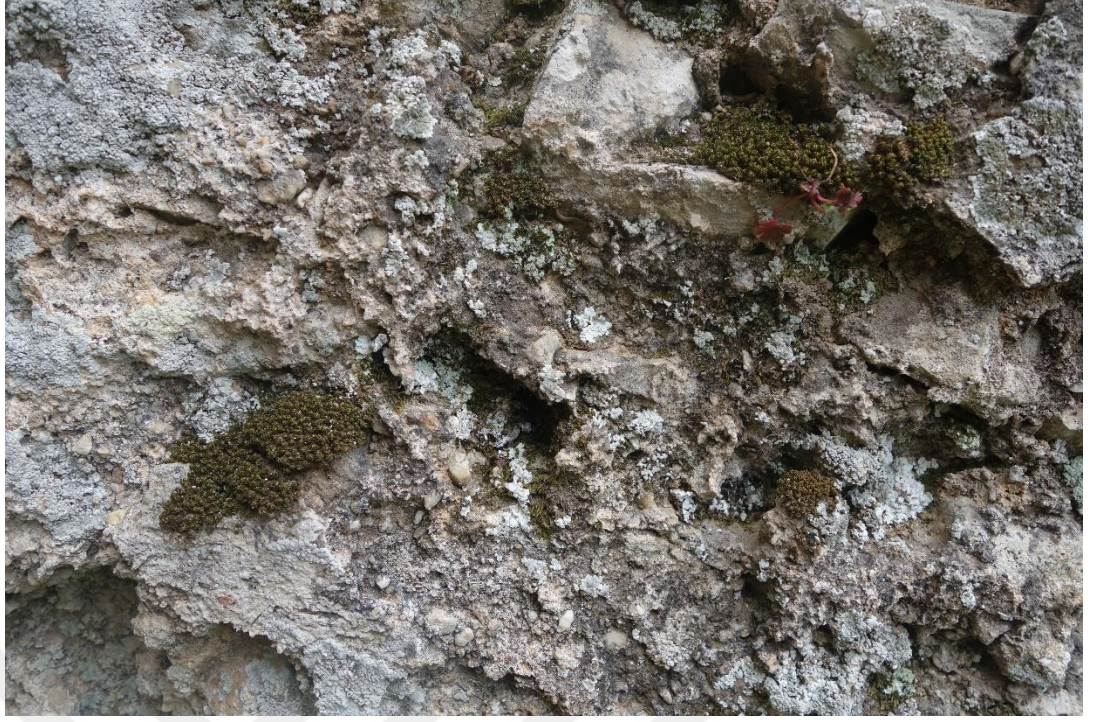
Resim 418 Ihlık Bölümü Batı Duvarı (4 Nolu) e. Biyolojik Oluşumlar
