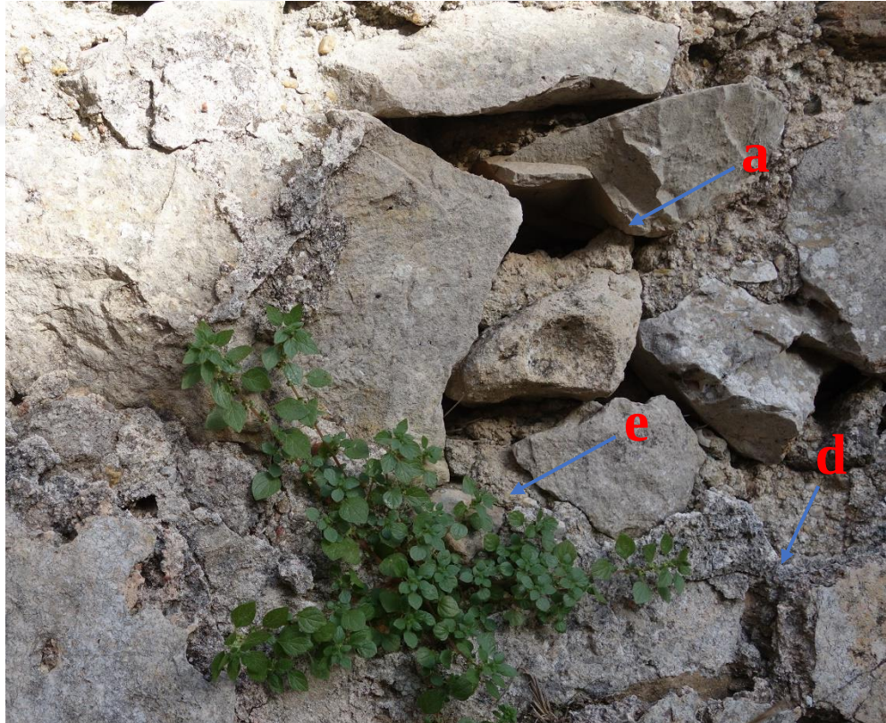
Resim 295 Ilıklık Bölümü Doğu Duvarı Harç Malzeme (3 Nolu) a. Malzeme Kaybı d. Renk Değişimi e. Köklü Bitkiler
