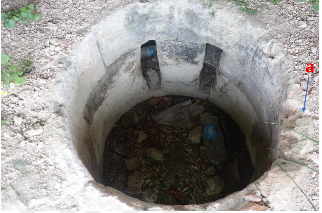
Resim 564 Kazan Bölümü ve Duman Kanalları a. Malzeme Kaybı
