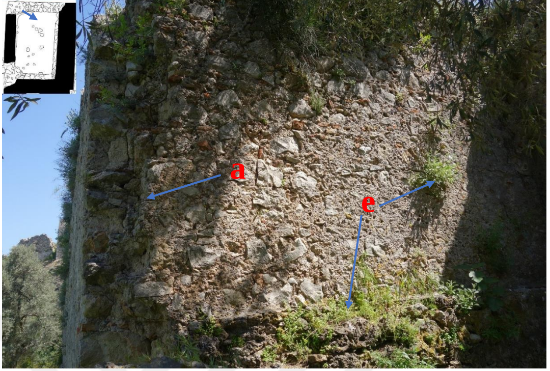
Resim 187 Ek Mekân Kuzey Duvarı (12 Nolu) a. Malzeme Kaybı e. Köklü Bitkiler
