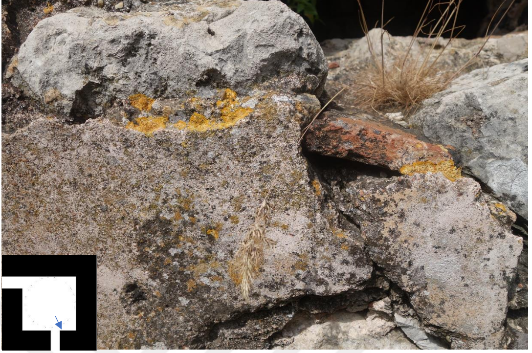
Resim 548 Sıcaklık Bölümü Doğu Duvarı (3 Nolu) e. Biyolojik Oluşum
