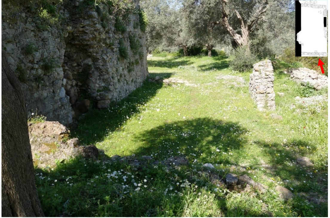
Resim 173 Külhan Bölümü ve Odunluk Zemin (11 Nolu) a. Malzeme Kaybı e. Biyolojik Oluşumlar
