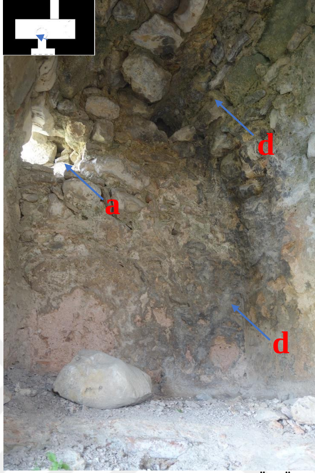
Resim 568 Su Deposu Güney Duvarı, Zemin ve Üst Örtü (4 Nolu) a. Malzeme Kaybı d. Renk Değişimi
