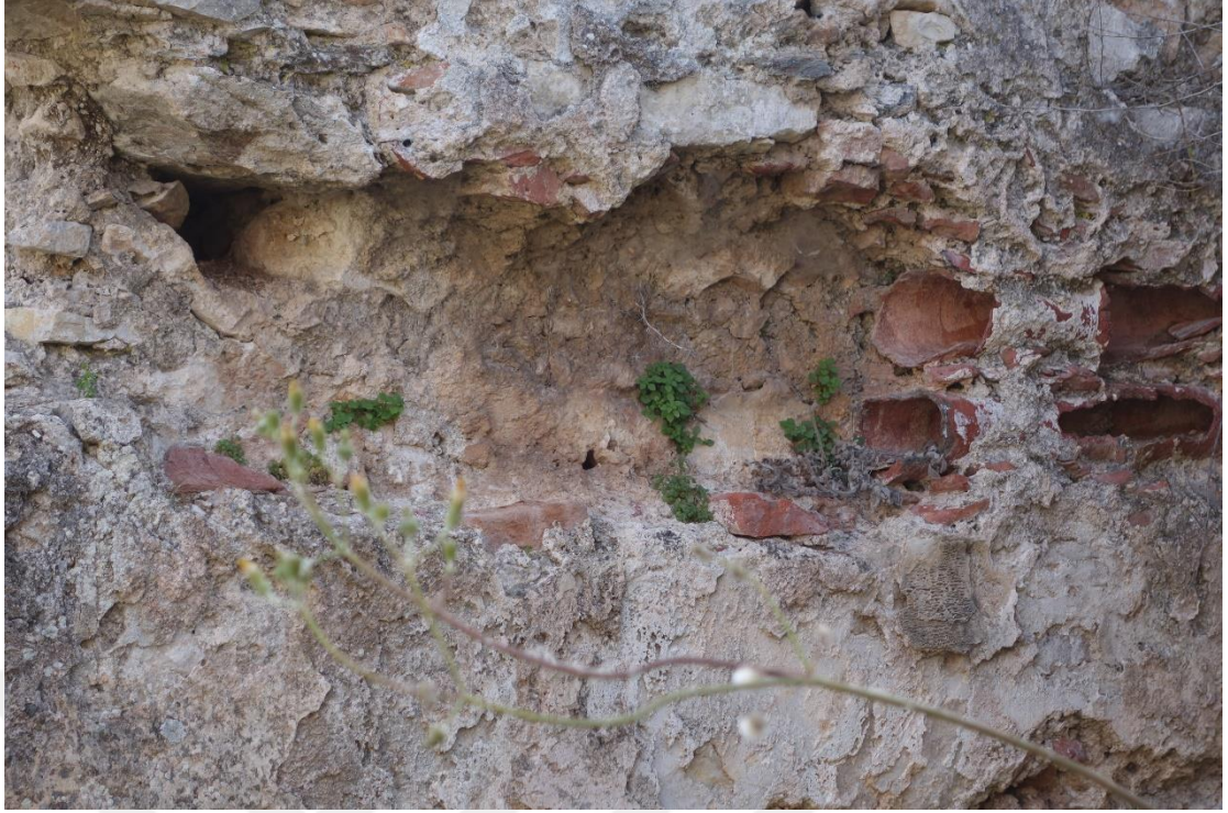
Resim 318 Sıcaklık Bölümü Güney Duvarı (5 Nolu) a. Malzeme Kaybı e. Köklü Bitkiler
