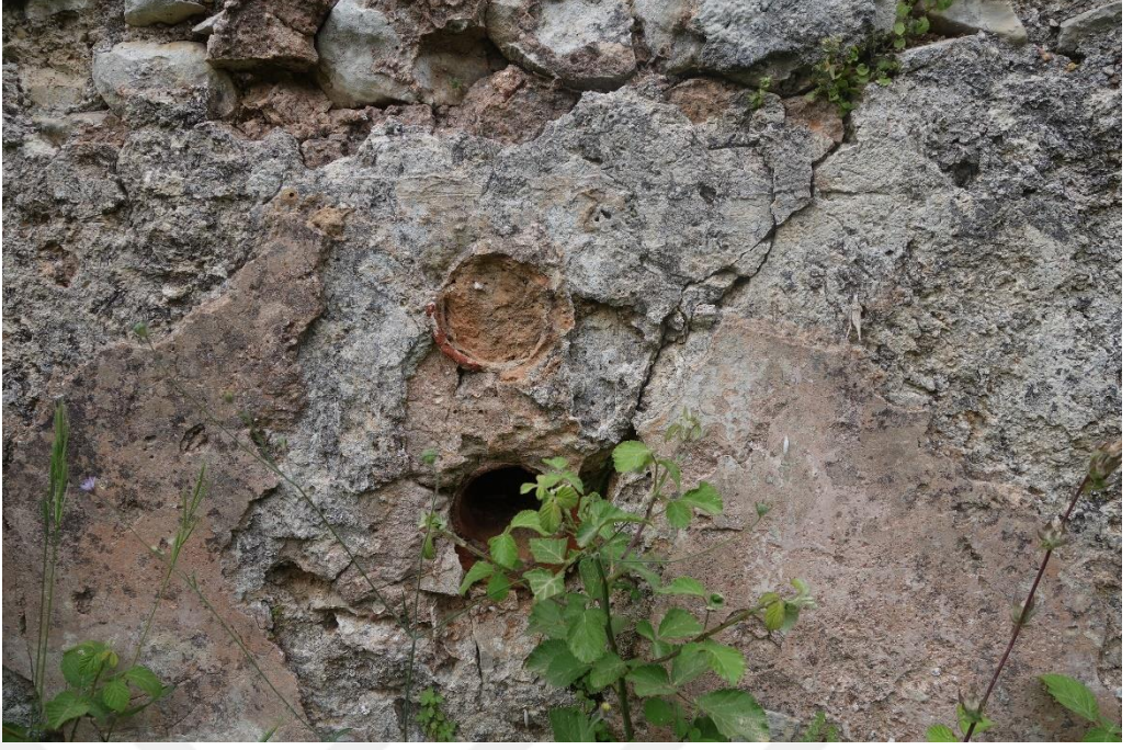
Resim 448 Sıcaklık Bölümü Kuzey Eyvanı (6 Nolu) b. Çatlak d. Renk Değişimi e. Köklü Bitkiler
