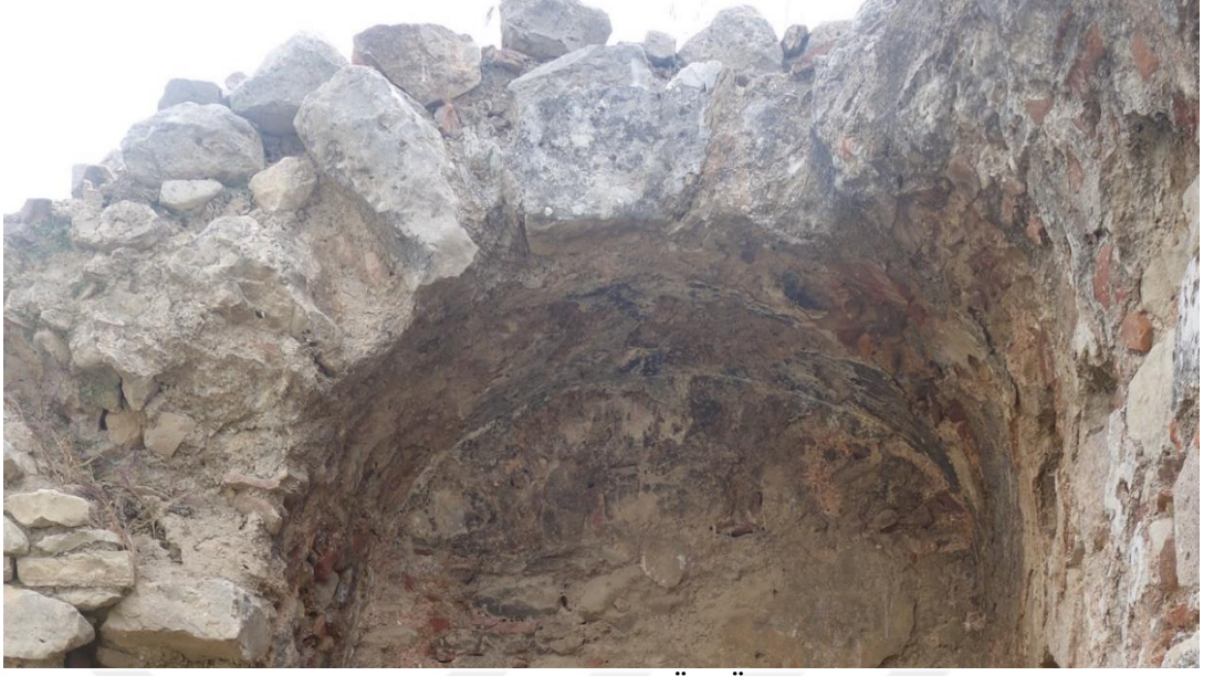
Resim 542 Aralık Bölümü Üst Örtü (2 Nolu) a. Malzeme Kaybı
