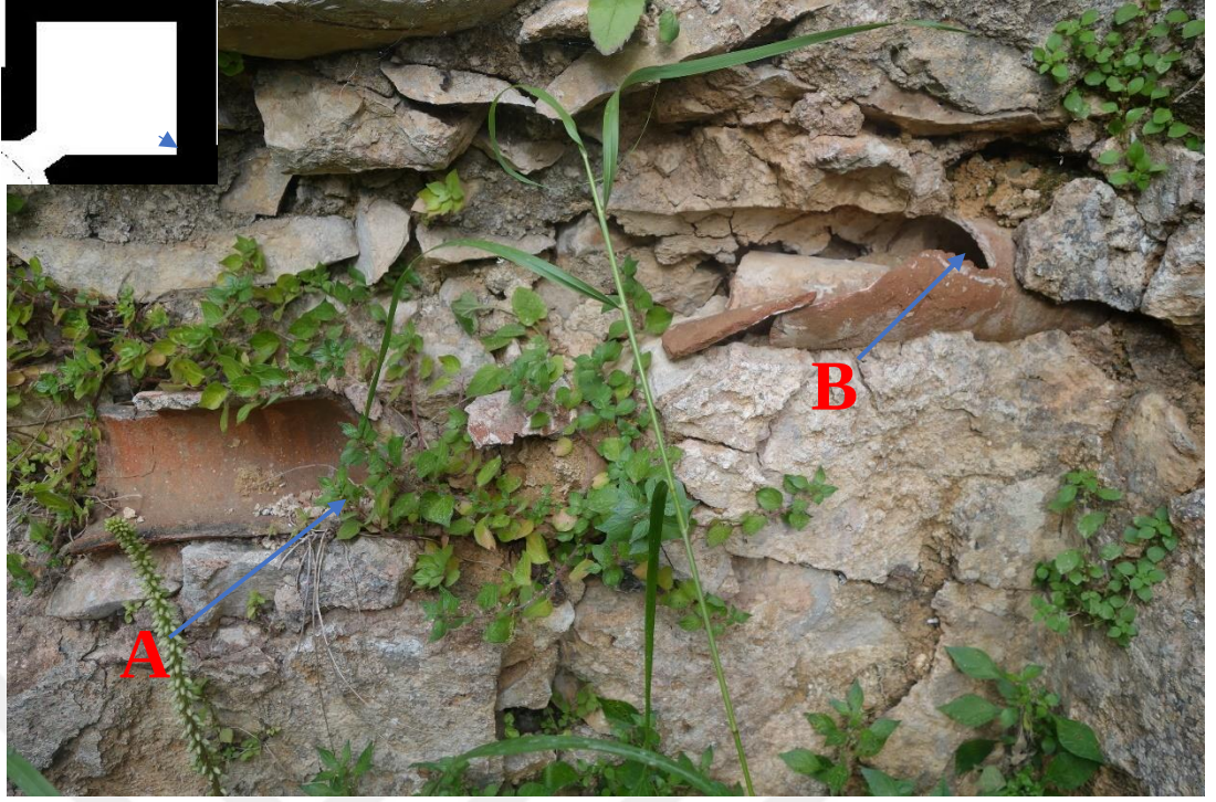
Resim 474 Doğu Halvet Bölümü Doğu Duvarı Su Hattı (7 Nolu) A. Eski Su Hattı B. Sonradan Yapılan Su Hattı
