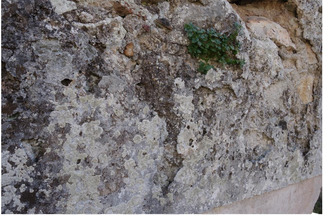
Resim 294 Ilıklık Bölümü Güney Duvarı (3 Nolu) e. Biyolojik Oluşumlar ve Köklü Bitkiler
