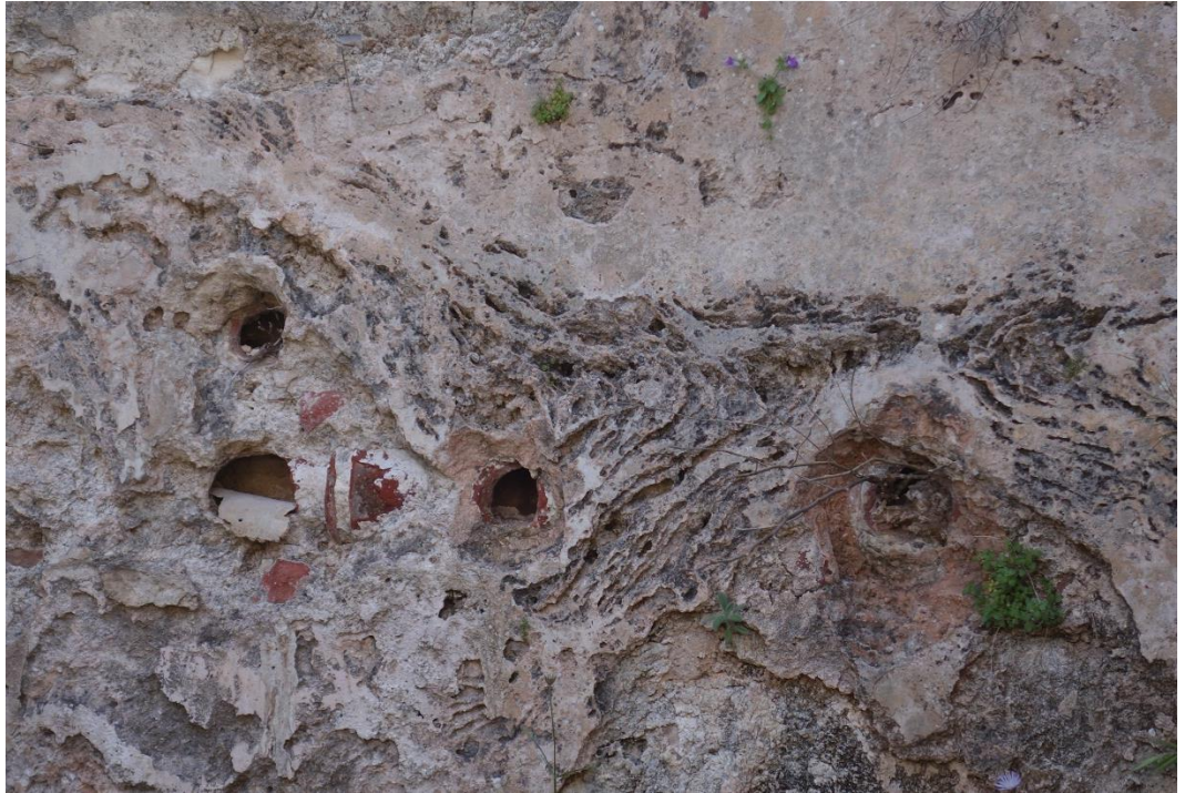
Resim 333 Batı Halvet Bölümü Batı Duvar (7 Nolu) a. Malzeme Kaybı d. Renk Değişimi e. Köklü Bitkiler
