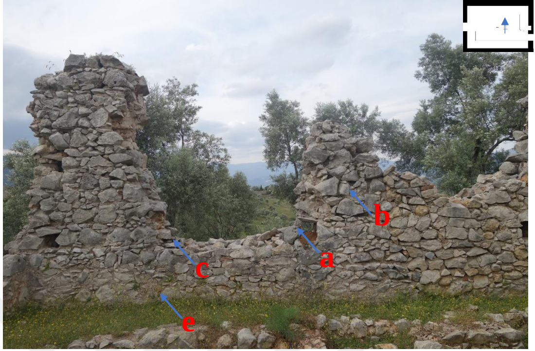
Resim 378 Soyunmalık Bölümü Kuzey Duvar (1 Nolu) a. Malzeme Kaybı b. Çatlak c. Petek Gözlülük e. Köklü Bitkiler
