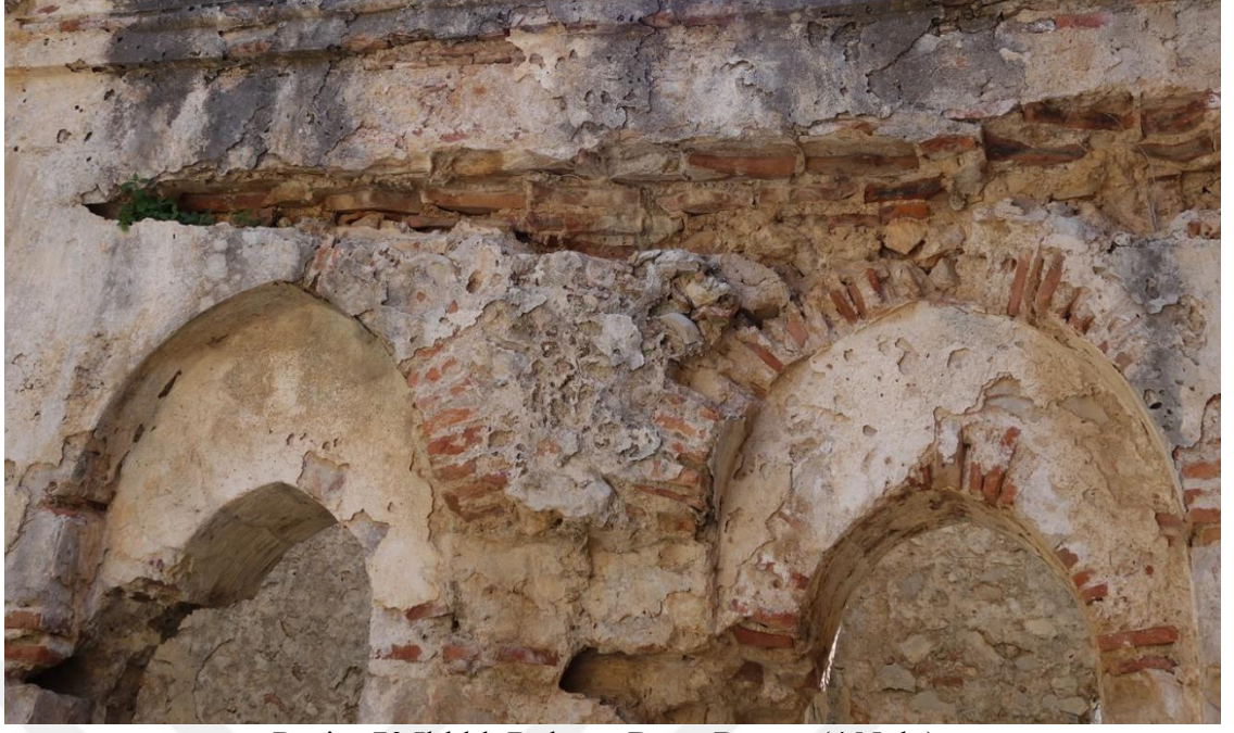
Resim 70 Ilıklık Bölümü Doğu Duvarı (4 Nolu) a. Malzeme Kaybı d. Renk Değişimi e. Köklü Bitkiler
