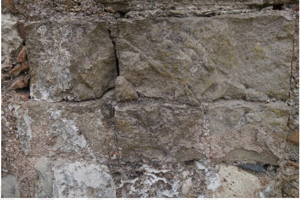
Resim 528 Soyunmalık Bölümü Kuzey Duvar (1 Nolu) e. Kabuklanma
