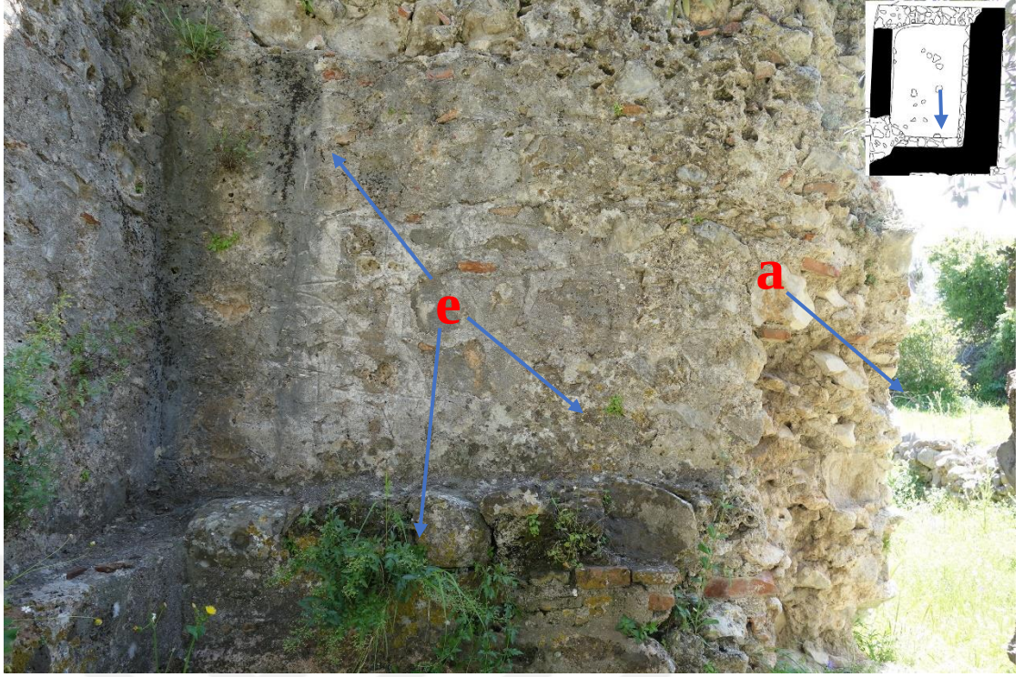
Resim 183 Ek Mekân Doğu Duvarı (12 Nolu) a. Malzeme Kaybı e. Biyolojik Oluşumlar ve Köklü Bitkiler
