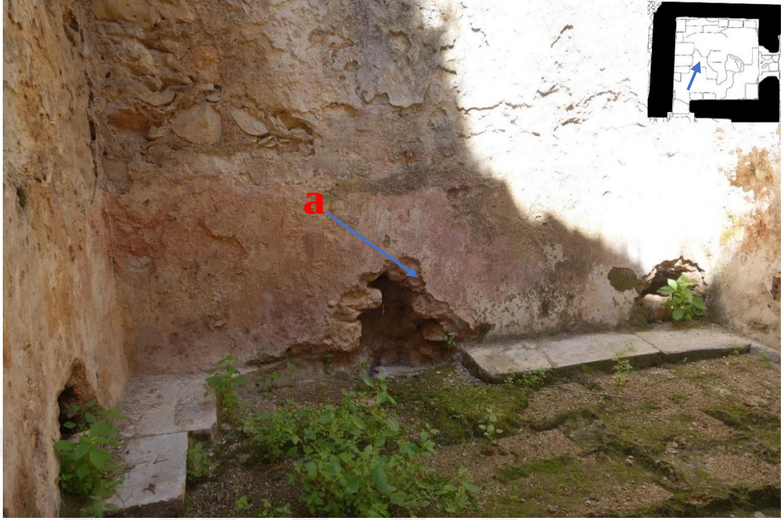
Resim 92 Tıraşlık Bölümü (2) Batı Duvarı (5 Nolu) a. Malzeme Kaybı
