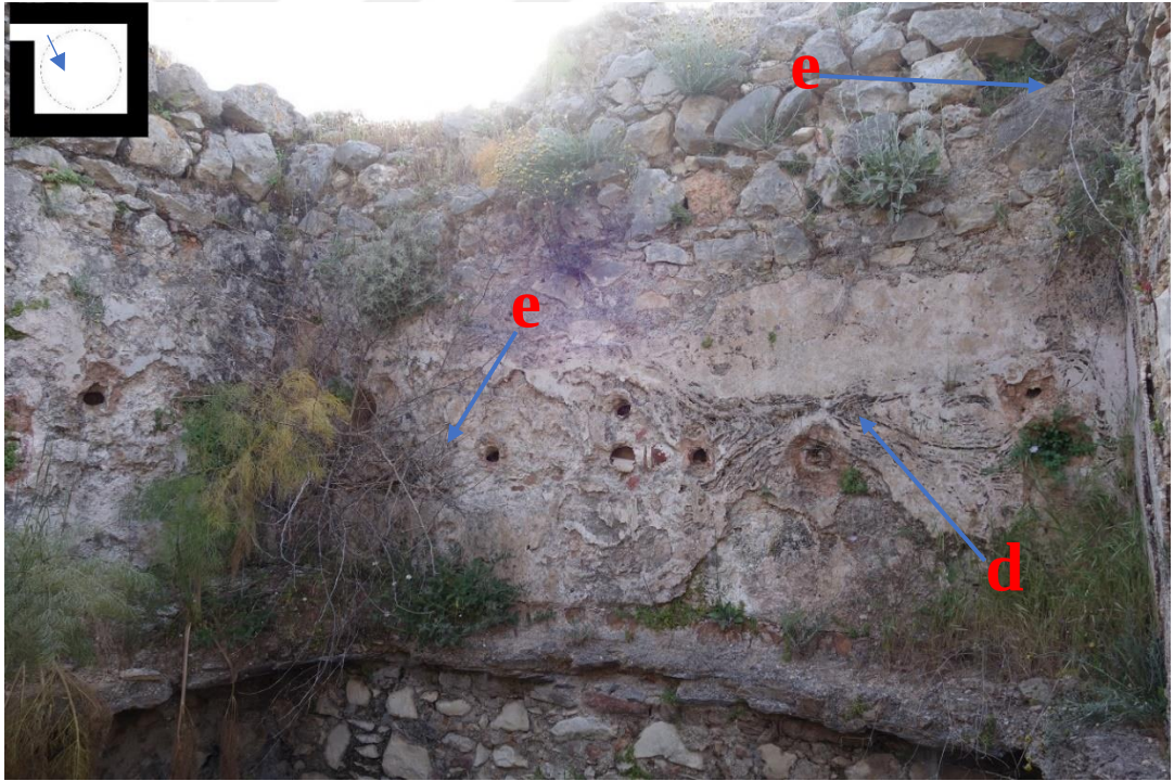
Resim 331 Batı Halvet Bölümü Batı Duvar (7 Nolu) a. Malzeme Kaybı d. Renk Değişimi e. Köklü Bitkiler
