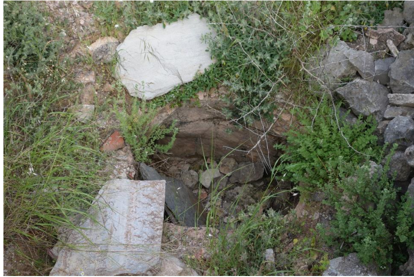
Resim 337 Su Deposu Bölümü Kazan Yeri (8 Nolu) a. Malzeme Kaybı e. Köklü Bitkiler
