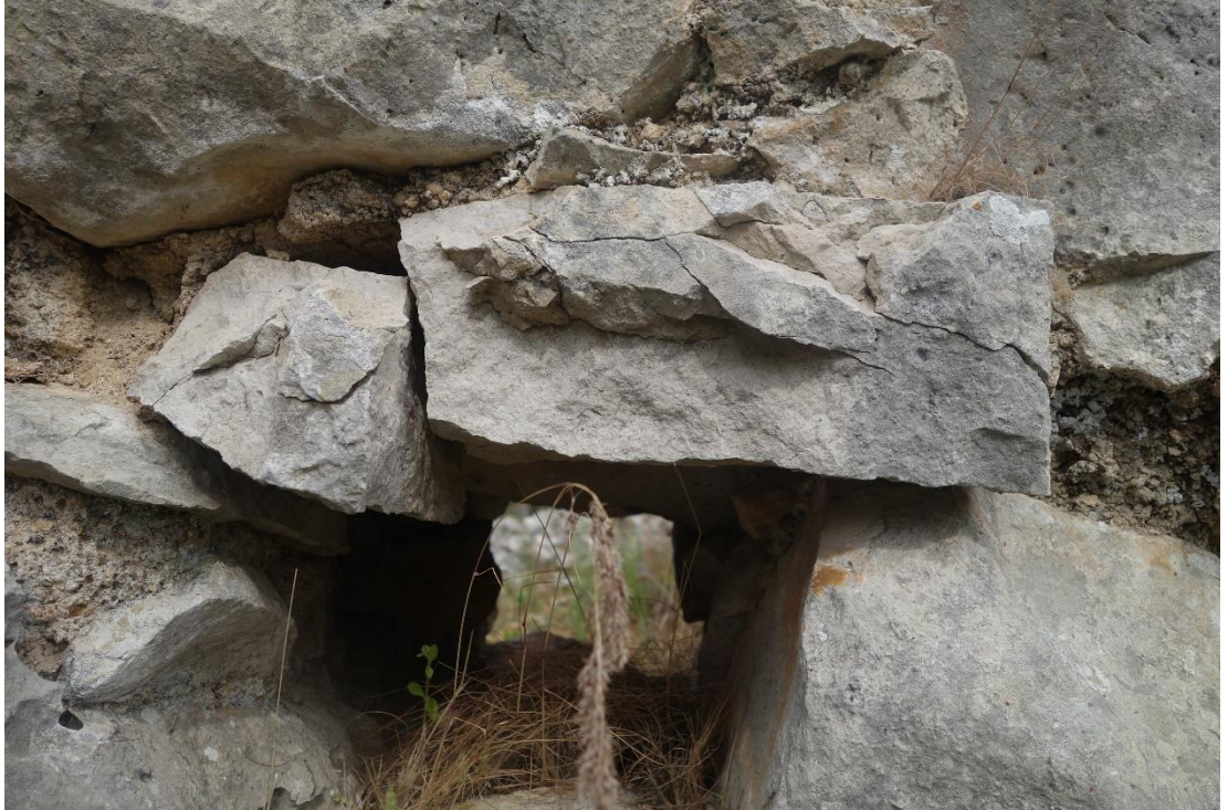
Resim 375 Soymalılık Bölümü Doğu Duvar (1 Nolu) b. Çatlak
