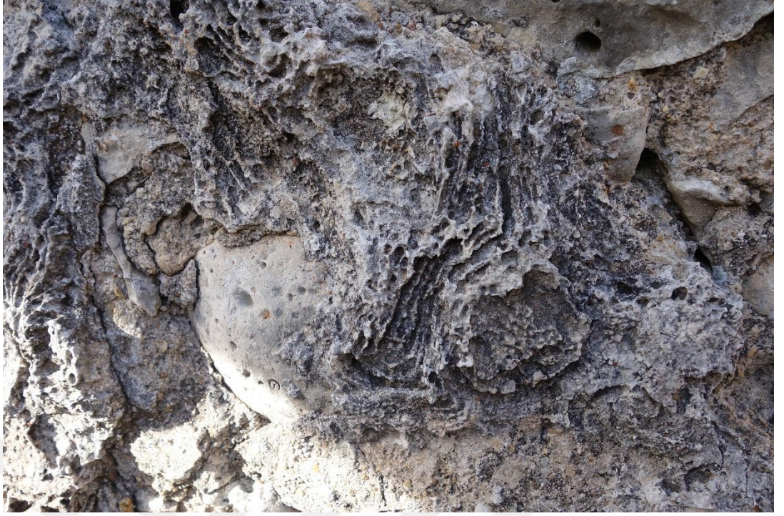
Resim 296 Ilıklık Bölümü Kuzey Duvarı Sıva Malzeme (3 Nolu) a. Malzeme Kaybı c. Petek Gözlülük d. Renk Değişimi
