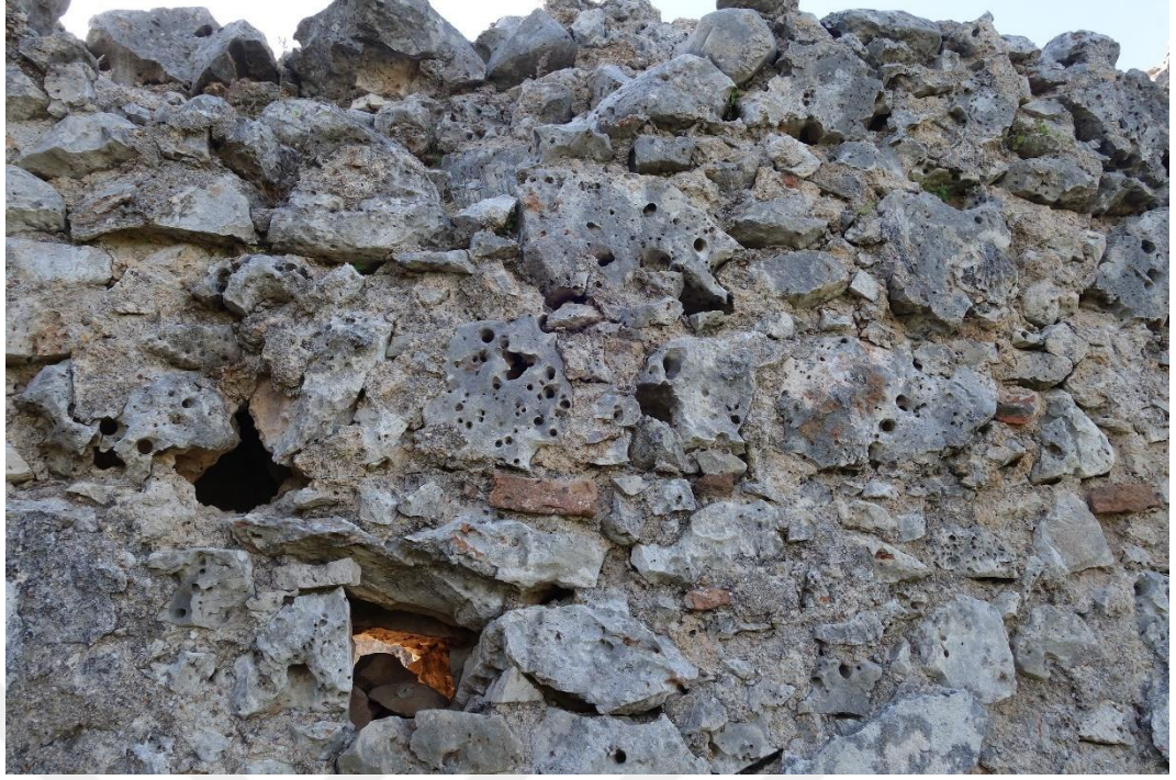
Resim 278 Aralık Bölümü Güney Duvarı (2 Nolu) a. Malzeme Kaybı c. Petek Gözlülük d. Renk Değişimi
