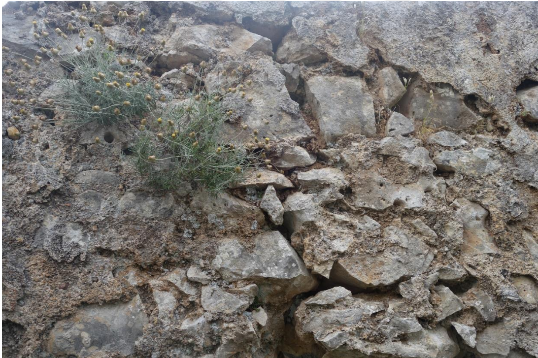
Resim 417 Ilıklık Bölümü Batı Duvarı (4 Nolu) b. Çatlak
