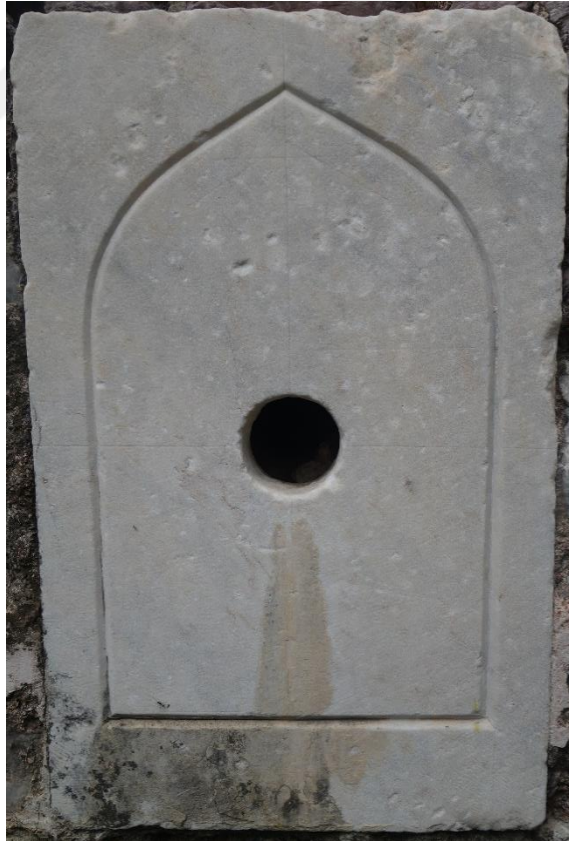
Resim 547 Sıcaklık Bölümü Doğu Duvarı (3 Nolu) d. Renk Değişimi e. Biyolojik Oluşum
