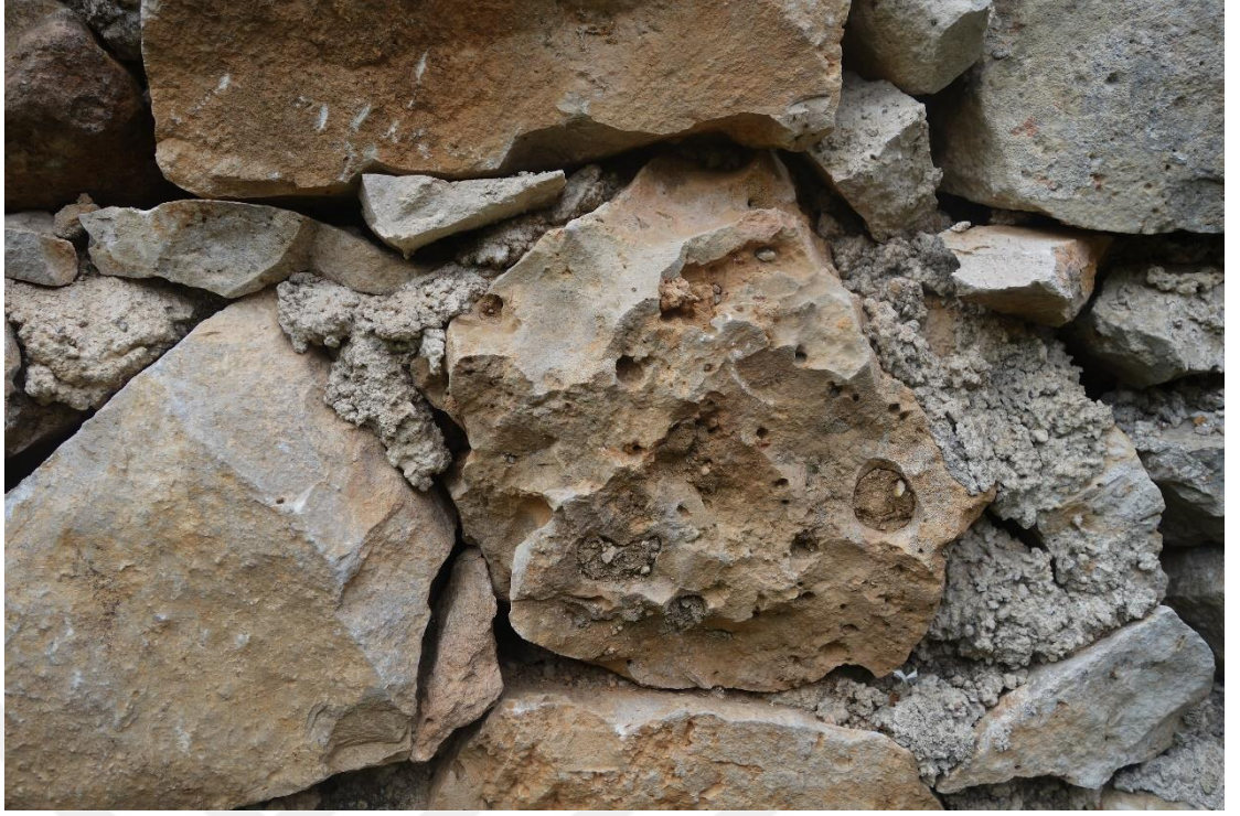
Resim 482 Batı Halvet Batı Duvarı (8 Nolu) b. Yarık c. Petek Gözlülük
