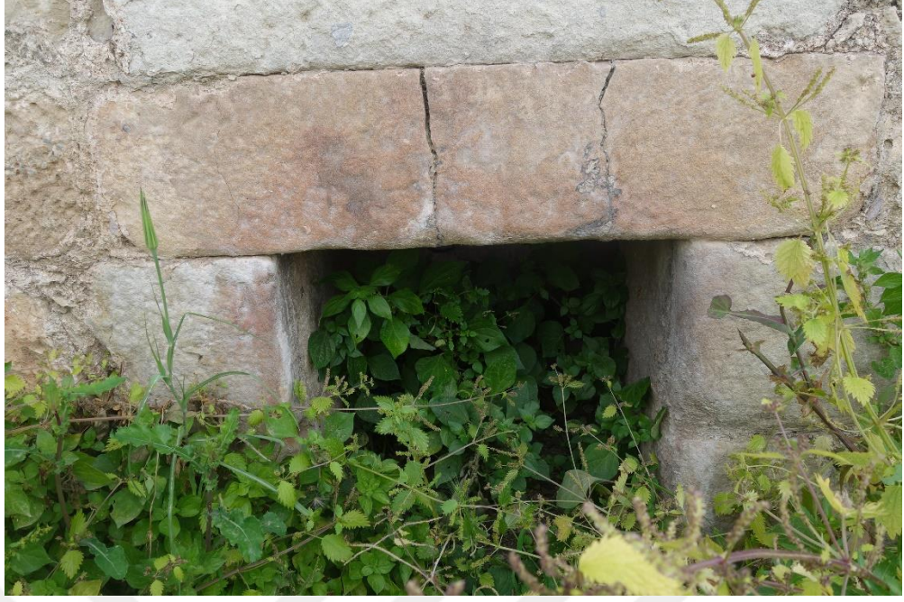
Resim 562 Ocak Ağızı b. Çatlak e. Köklü Bitkiler
