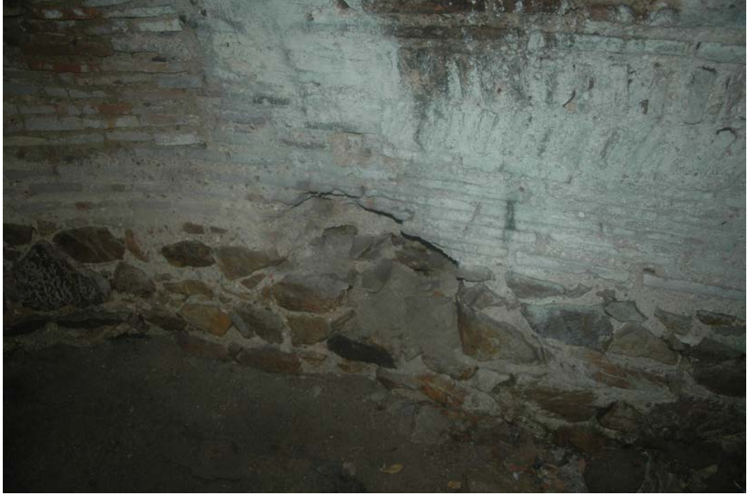
Resim 56 – Güney duvarda, balık sırtı bezemenin altındaki tahribat.
