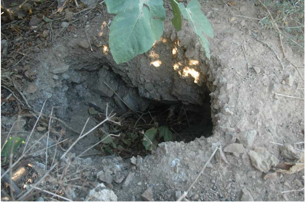
Resim 60 – Batı duvarındaki nişin üzerindeki çöküntü, üstten görünüm.
