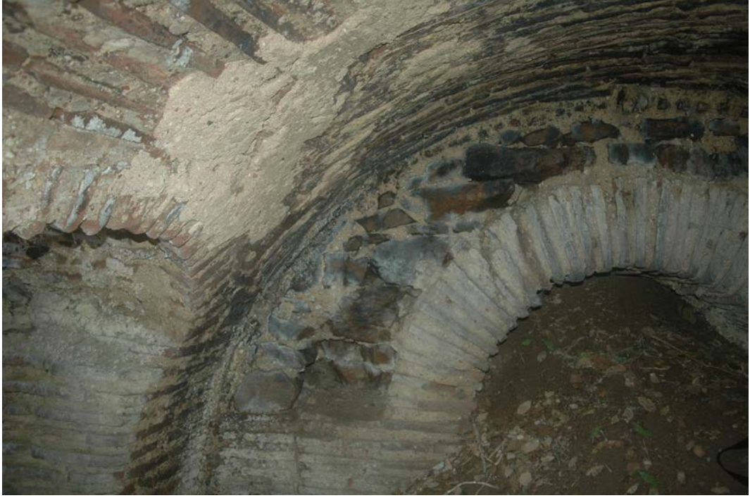
Resim 61 – Batı duvarındaki niş kemerinin sol kısmında tahribat.
