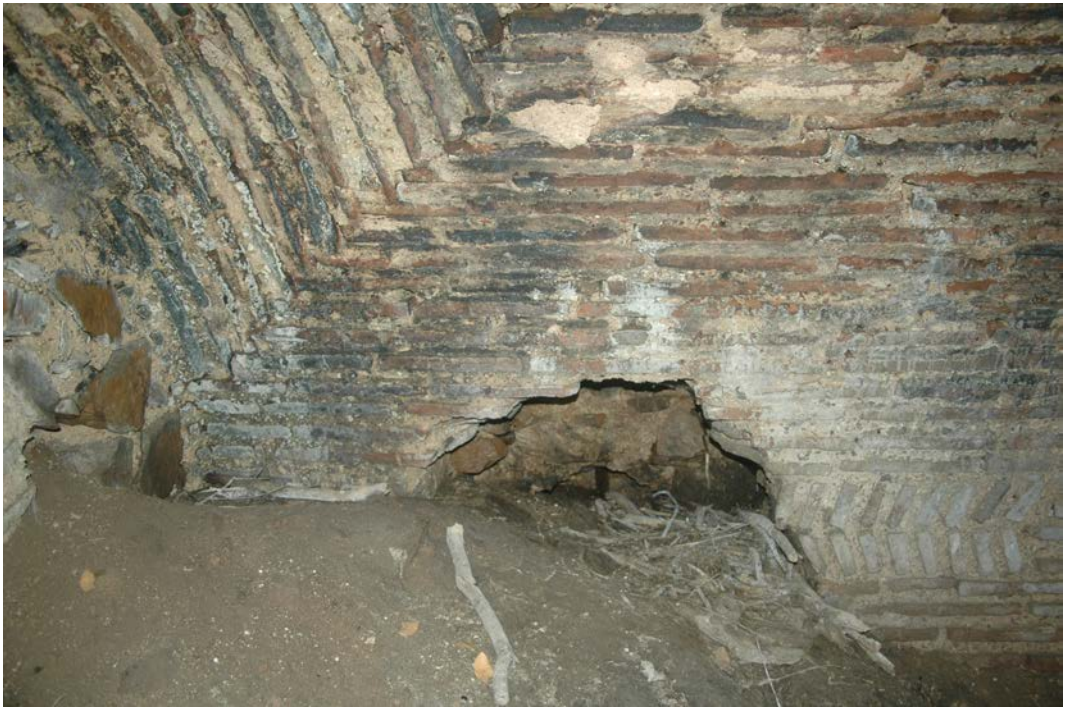
Resim 15 – Kilise altyapısının içinden tahribat örneği..
