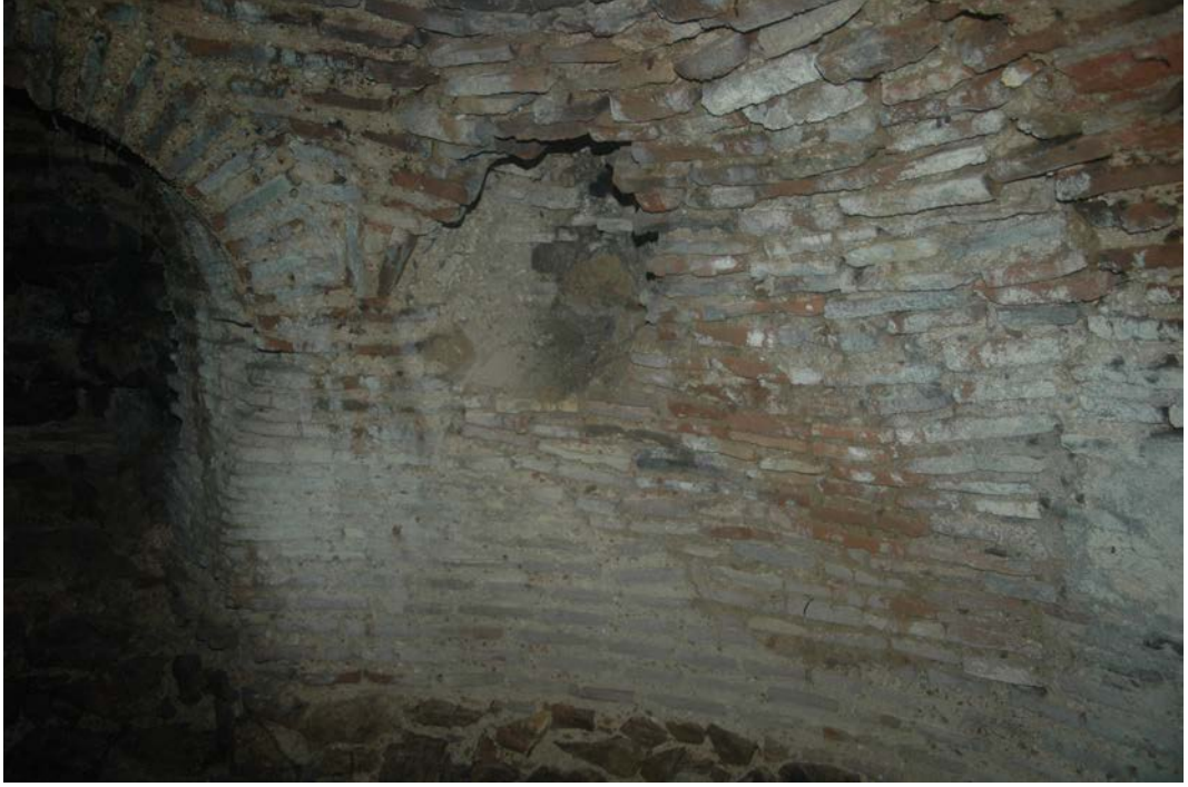
Resim 16 – Kilise altyapısının içinden tahribat örneği.
