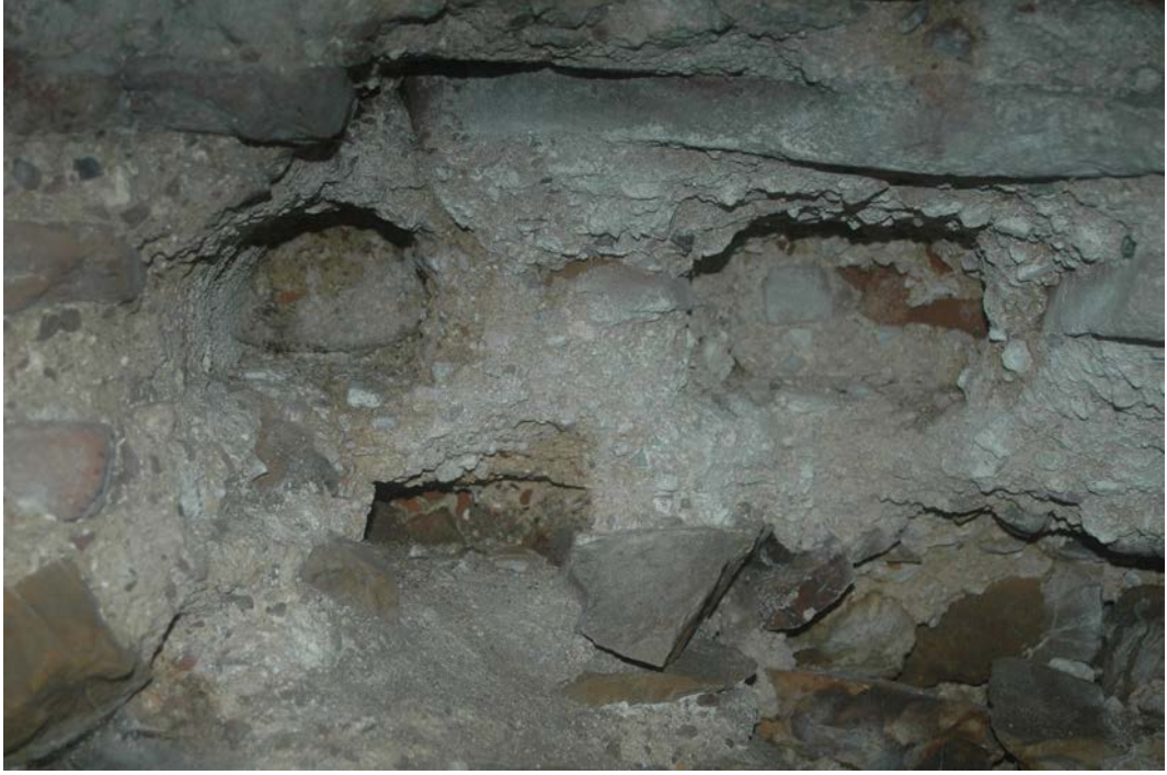
Resim 69 – Güney duvarda hatıl deliği.
