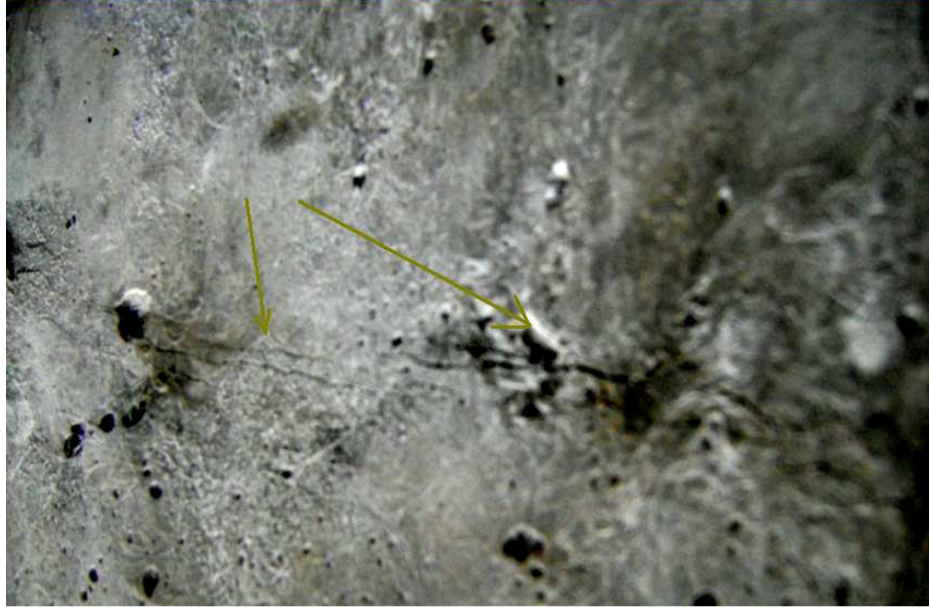
Şekil 5.5 Küp numunelerde oluşan çatlaklar
