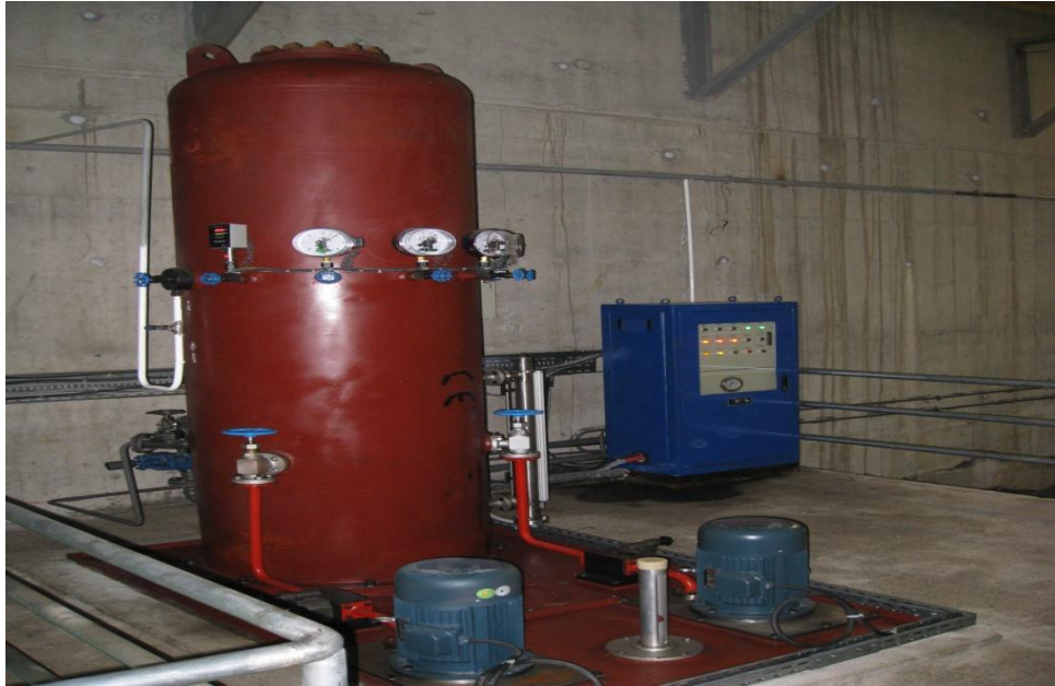
Şekil 8. Hidrolik yağ tankı
