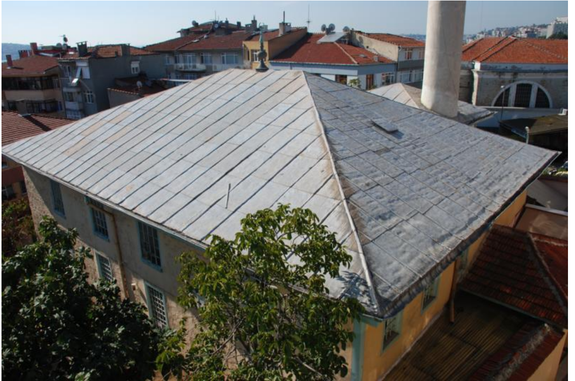
Resim 62: Abbas Ağa Camii Üst Örtüsü
