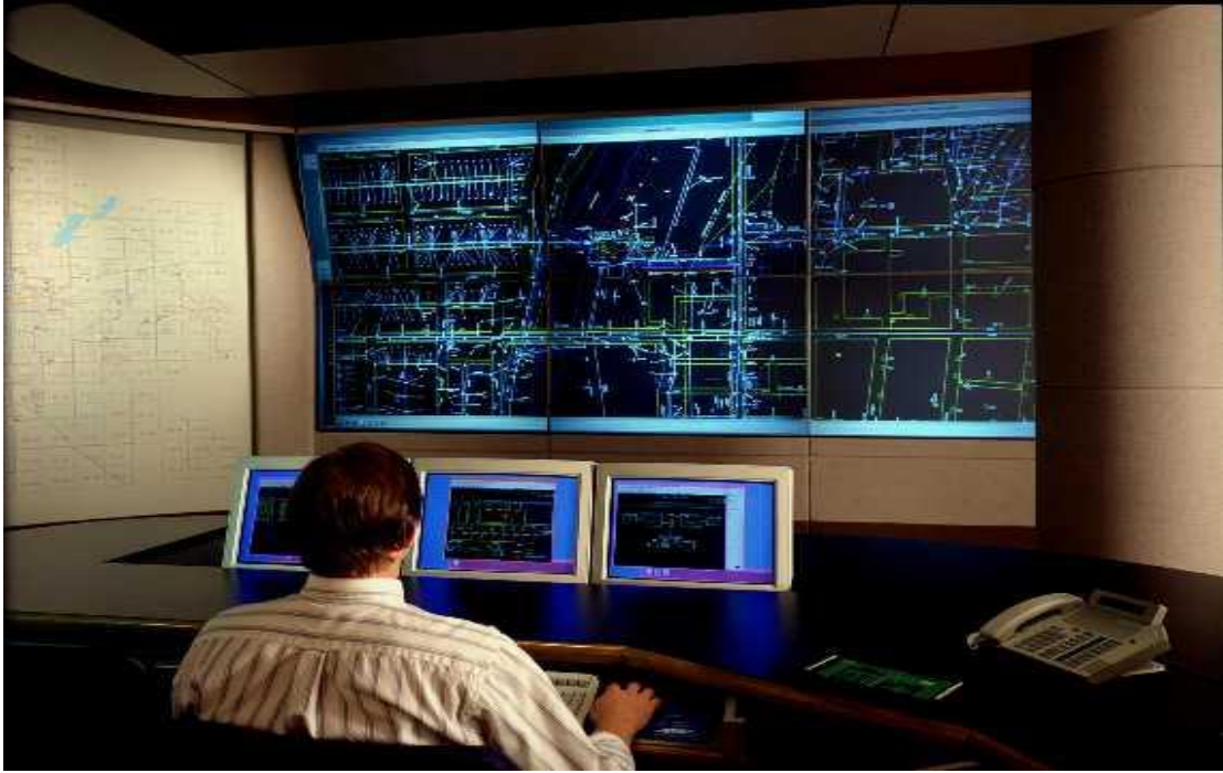
Şekil 3.11. Master Terminal Unit (MTU)
