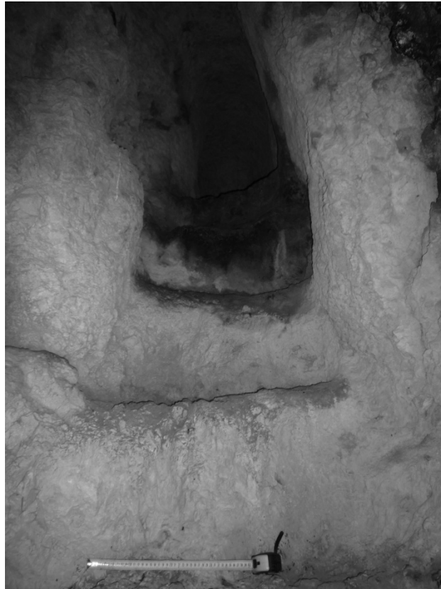
Resim 90: Oygu Kanal 7 Şaft Girişi
