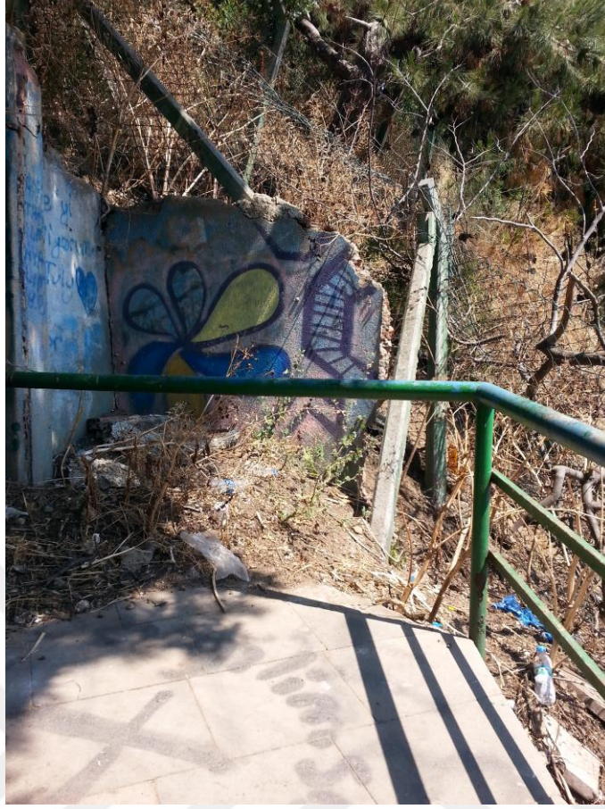
Şekil 3. 18 Problemlı merdiven bağlantısının fiziksel durumu (09.07.2017)
