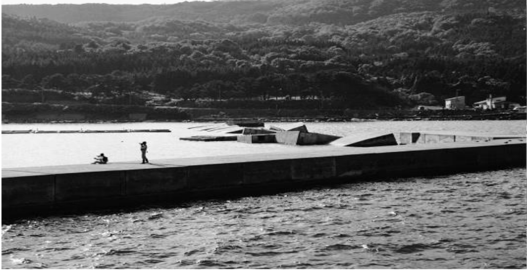
Şekil 2.10 Hasar gören dalgakıranlar, Okushiri Limanı, Japonya, 1993 Hokkaido-Nansei-oki depremi [7]
