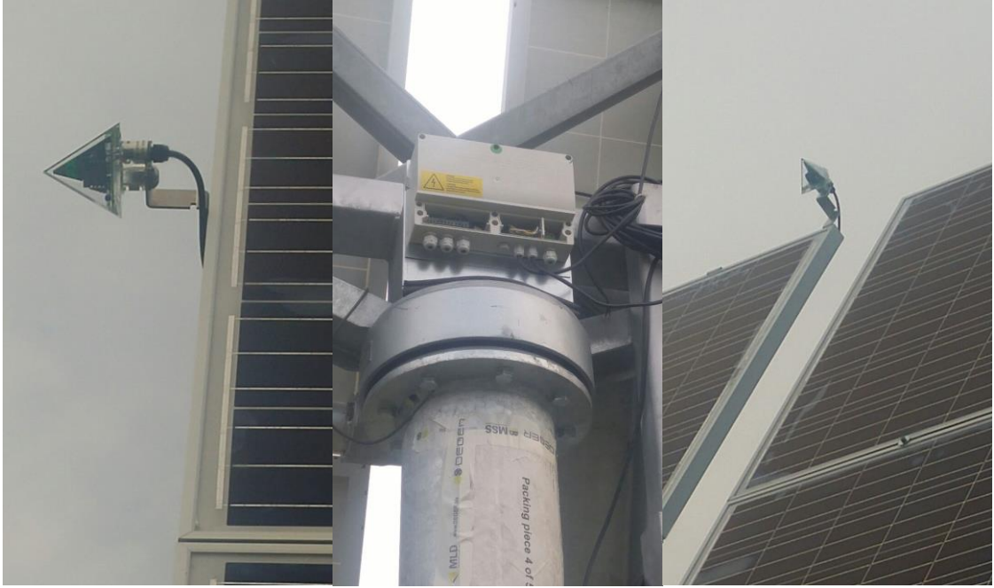
Şekil 4.5 Merkezi kontrol ünitesi ve güneş algılama elemanları
