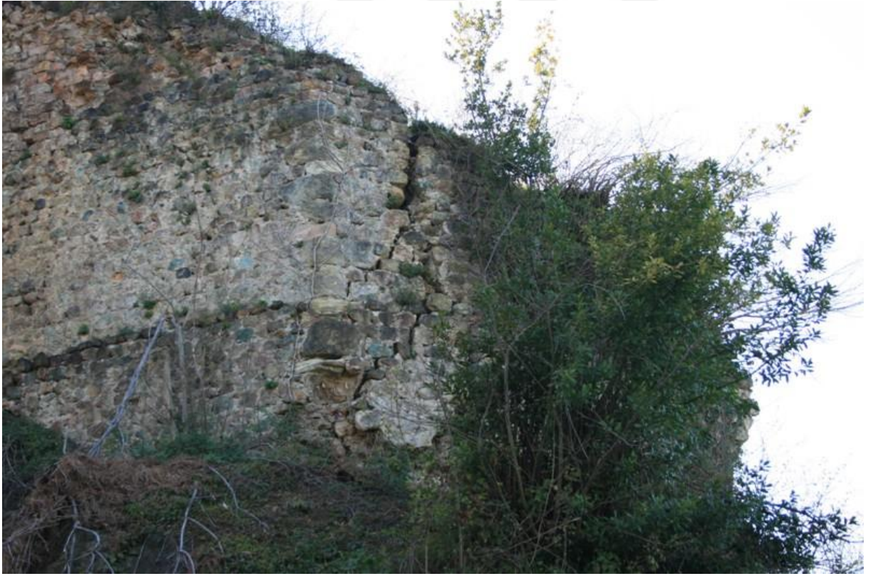
Fotoğraf 6: Of (İvyan) Kalesi Çatlamış Kuzey Duvarı
